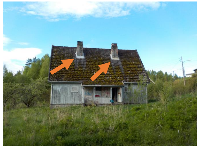
Bilde 9 viser blybeslag rundt piper på tak på bolighus.
