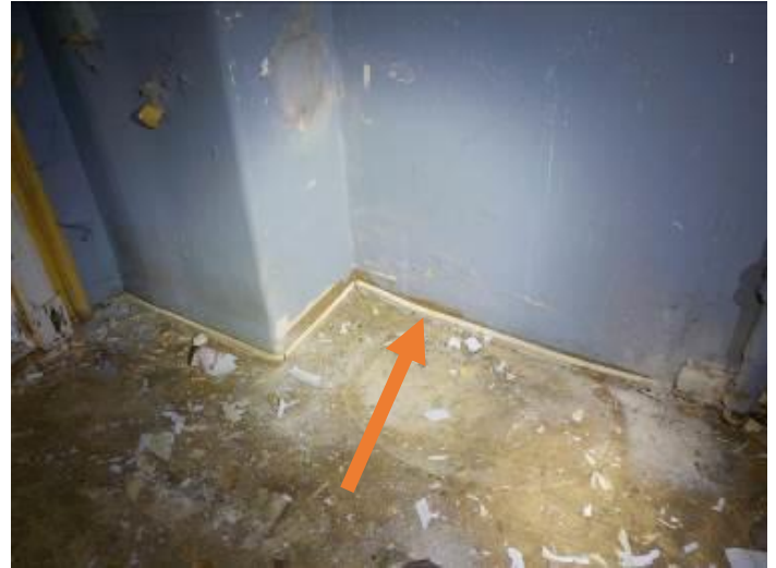
Bilde 15 viser vinyllister på kjøkken i 1. etasje vest.
