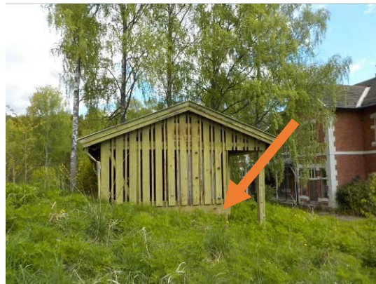
Bilde 18 viser grønnmaling på betong på skur. Malingen er over normverdier og forurenset med arsen, bly, kobber, krom og sink.
