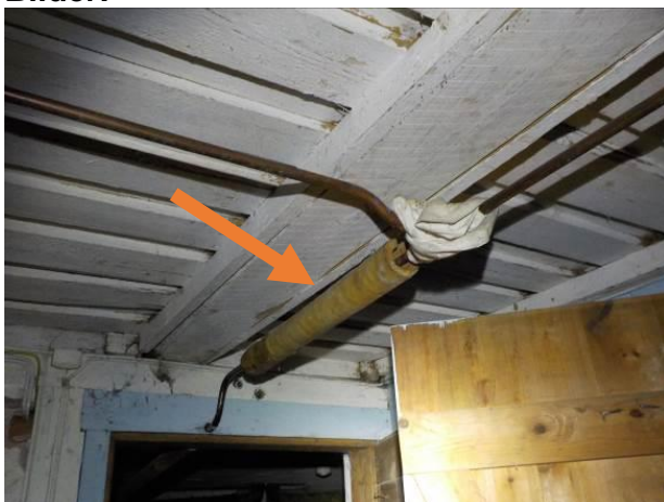
Bilde 10 viser cellegummi i mellomgang (rom kj9) i kjeller.
