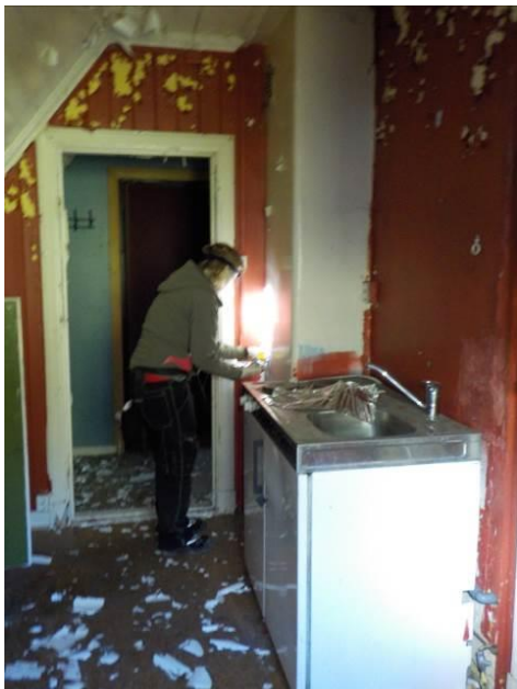
Bilde 17 viser prøvetaking av maling på pipe på kjøkken i 2. etasje vest. Malingen er farlig avfall med bly.
