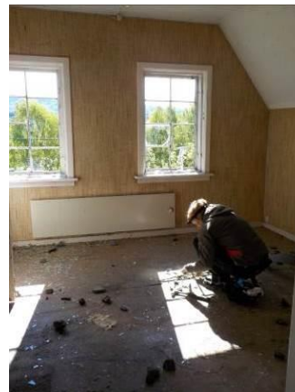
Bilde 4 viser prøvetaking av sort lim under papp og linoleum, 2. etasje øst. Limet inneholder ikke asbest.
