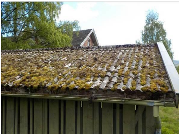
Bilde 3 viser asbestplater på tak, skur.
