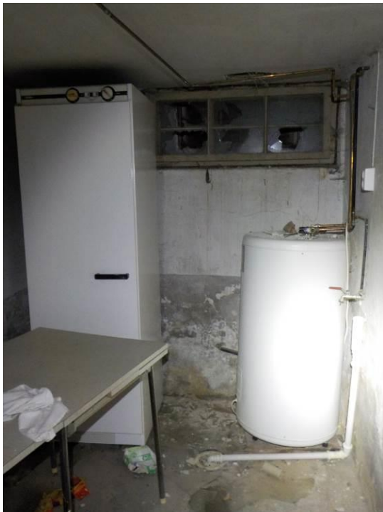
Bilde 12 viser eksempel på EE-avfall i form av løsøre; varmtvannstank og tørkeskap i kjeller.
