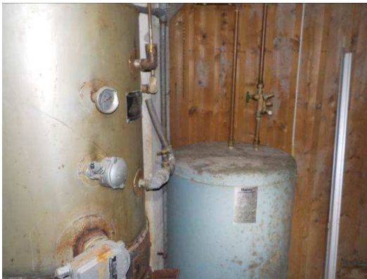
Bilde 4 Viser varmtvannstank i kjeller som eksempel på EE-avfall
