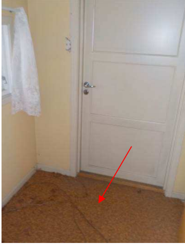
Bilde 6 Viser brunt vinylbelegg på gulv i rom 9
