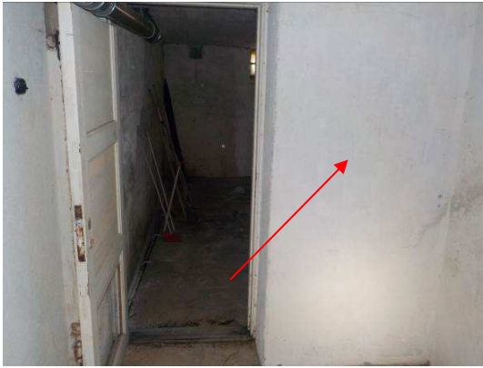
Bilde 10 Viser hvit maling på betongvegg i kjeller
