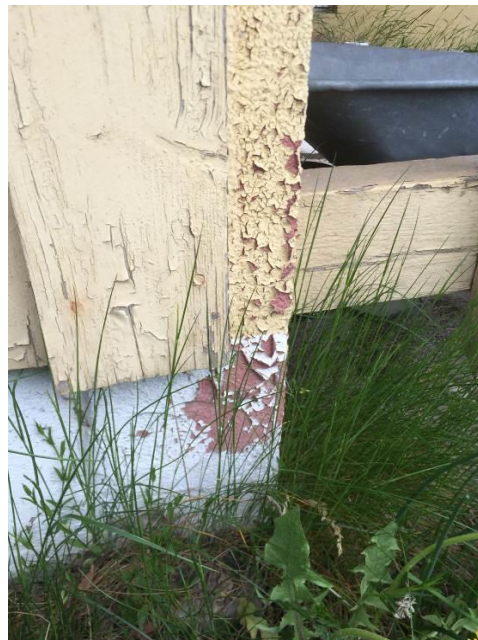
Bilde 22 viser gul maling på rød maling på trevirke og hvit maling på rød maling på grunnmur. Malingen er forurenset med kvikksølv og sink.
