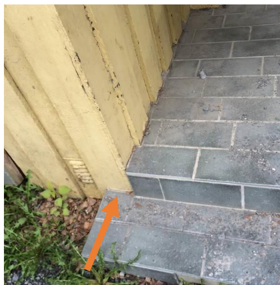
Bilde 16 viser fugemasse i trapp utvendig i 9A.
