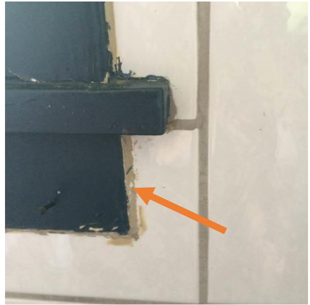
Bilde 18 viser fugemasse rundt vindu på bad i 2. etasje i 9A.
