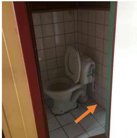
Bilde 14 viser fugemasse på toalett i 2. etasje i 9A.
