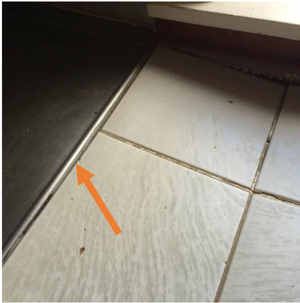
Bilde 17 viser fugemasse på kjøkkenbenk i 1. etasje i 9A.
