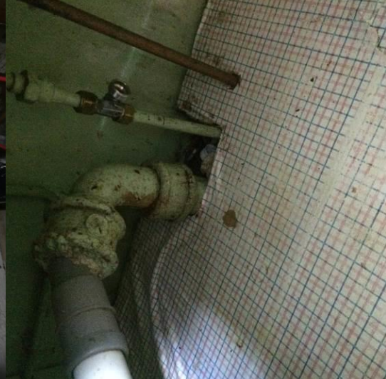
Bilde 2 viser soilrør med bly på kjøkken i 1. etasje i 9A. Det kan være asbest under blyet.
