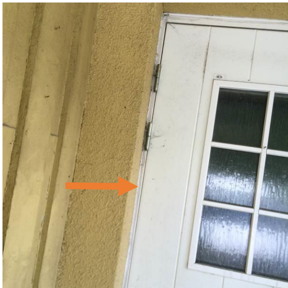
Bilde 13 viser fugemasse rundt inngangsdør i 9A.
