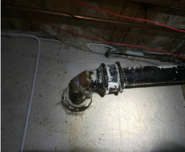
Bilde 1 viser soilrør med bly i kjeller. Det kan være asbest under blyet.
