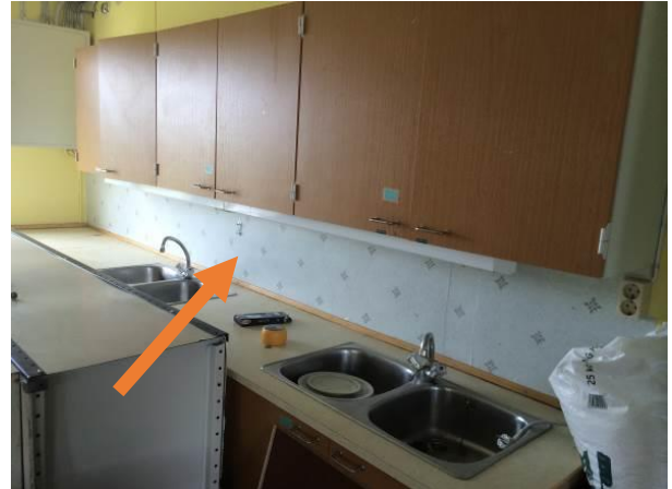
Bilde 6 viser vinyltapet ved kjøkken i rom 3 i 1. etasje.
