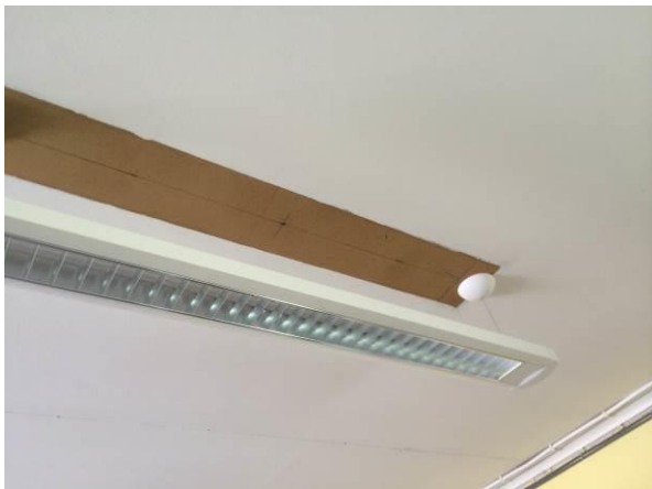
Bilde 3 viser eksempel på fastmontert EE-avfall.
