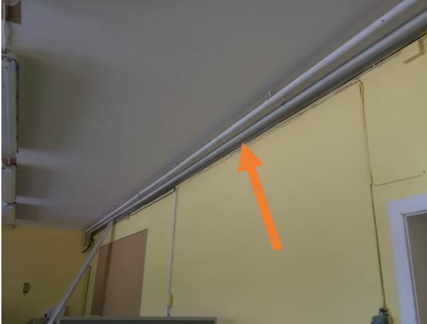
Bilde 2 viser hvitmalt cellegummi i rom 1 i 1. etasje.
