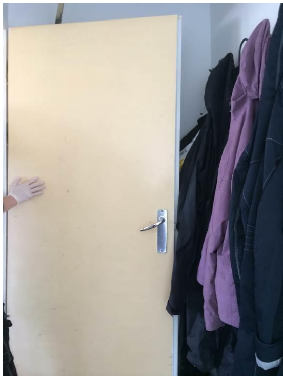
Bilde 1 viser eldre branndør mellom gang og rom 1 i 1. etasje, som kan inneholde asbestholdig isolasjon.
