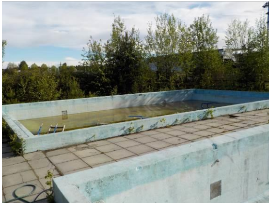
Bilde 6 Viser basseng 1 i forgrunnen og basseng 2 i bakgrunnen. Både maling og betong i bassengene er forurenset. Se også kap. 3.6.
