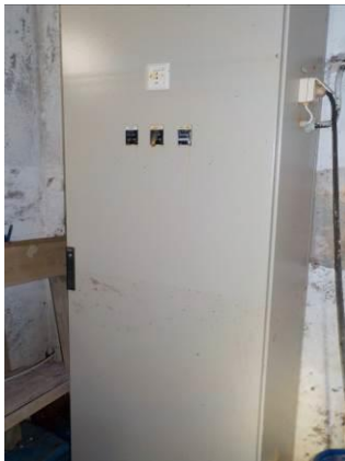
Bilde 4 Viser el. skap som eksempel på EE-avfall
