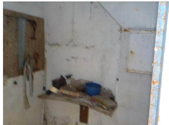
Bilde 9 Viser innside av hjørnerom ved inngangsparti til pumpehus. Hvitmaling på betongvegg er forurenset.
