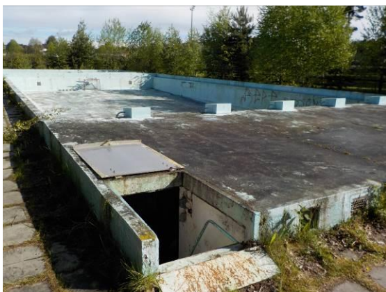
Bilde 7 Viser inngang til pumpehus, ved basseng 1. Maling i pumpehuset er forurenset.
