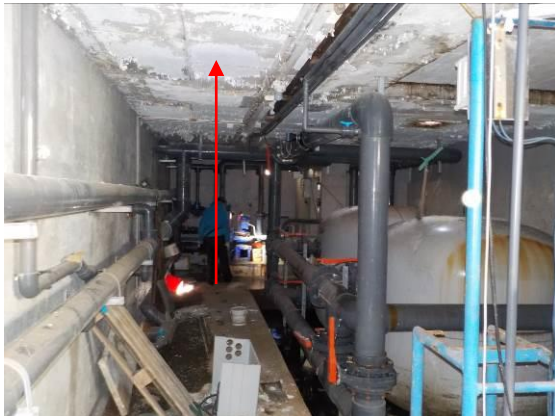
Bilde 2 Viser EPS i tak i hovedrom. Håndteres som ordinært avfall.
