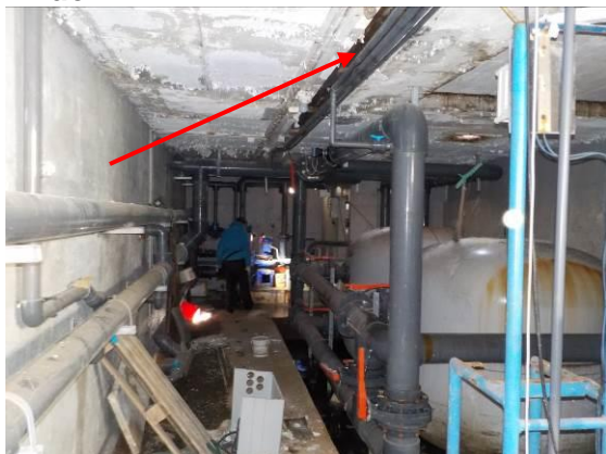
Bilde 3 Viser CCA-impregnert trevirke i tak i hovedrom
