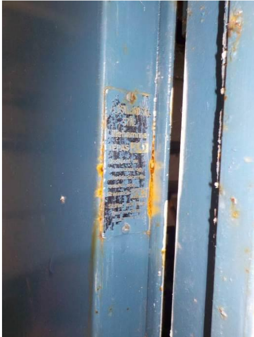
Bilde 1 Viser karm på eldre branndør mellom hovedrom og hjørnerom ved inngangsparti. Håndteres som asbestholdig.
