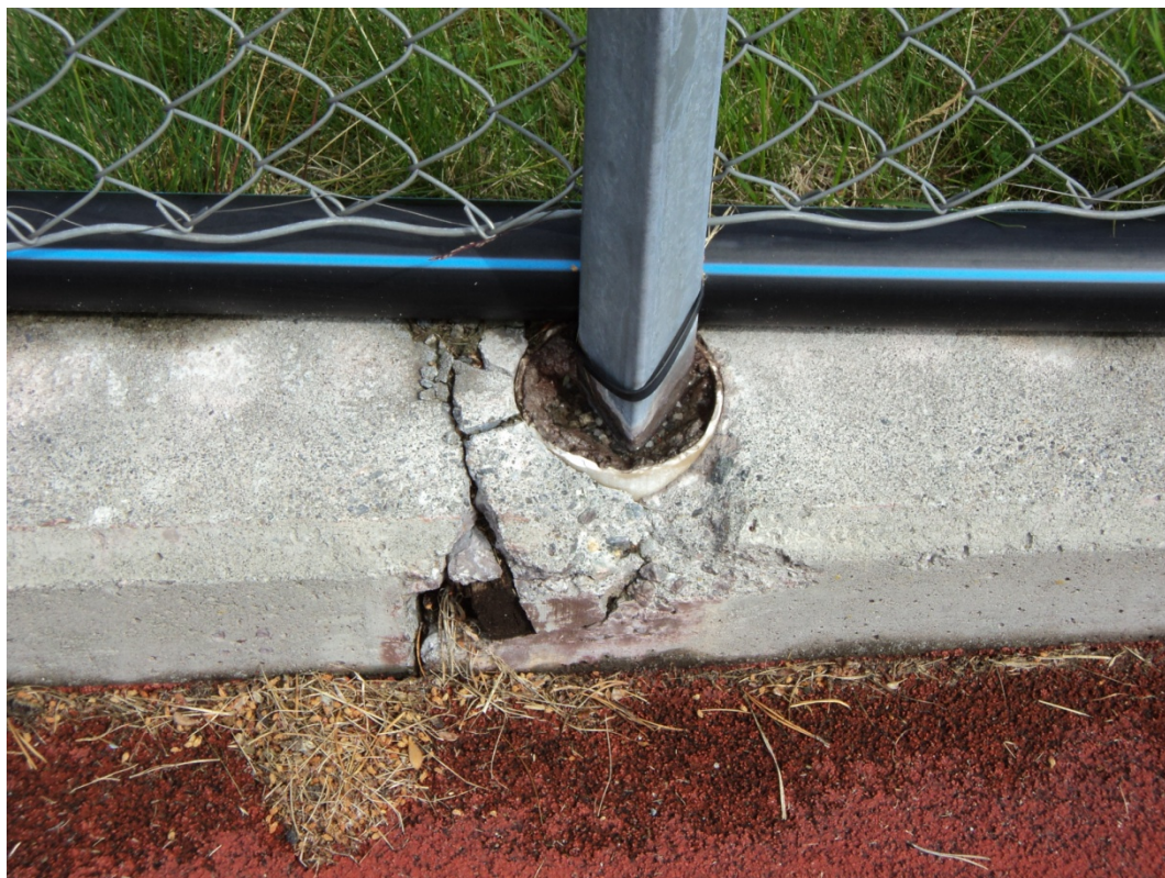
Ytre kantstein, fundament for gjerde, frostsprengning
