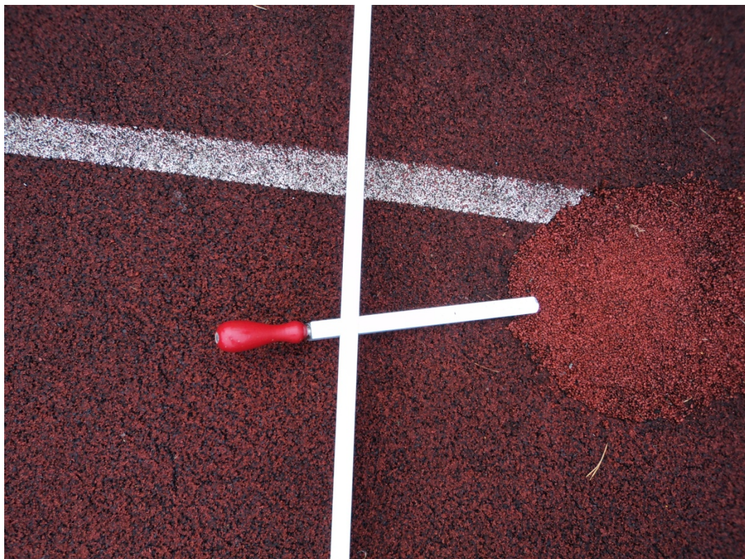
Svank, hulrom under dekket i de ytterste banene i østre sving
