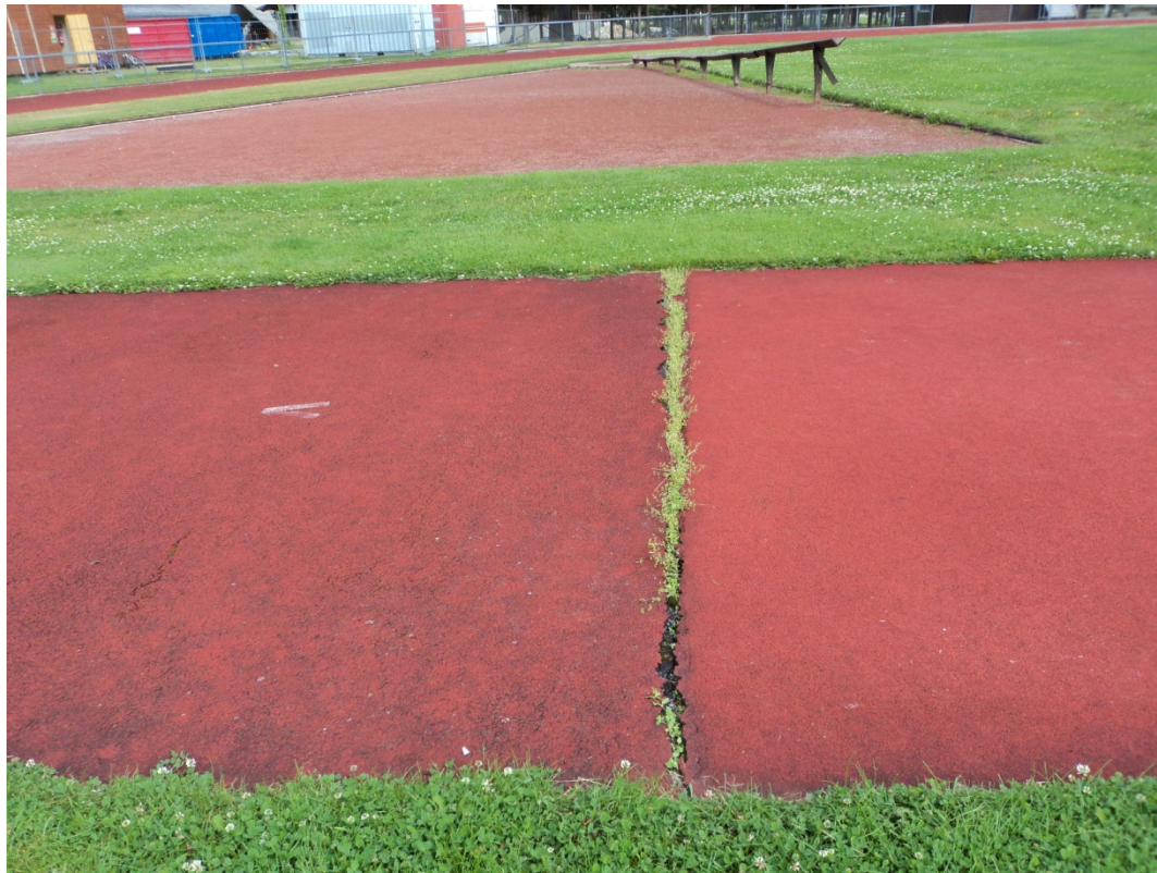
Spydtilløp, gjennomgående sprekk i kunststoffdekke og asfalt
