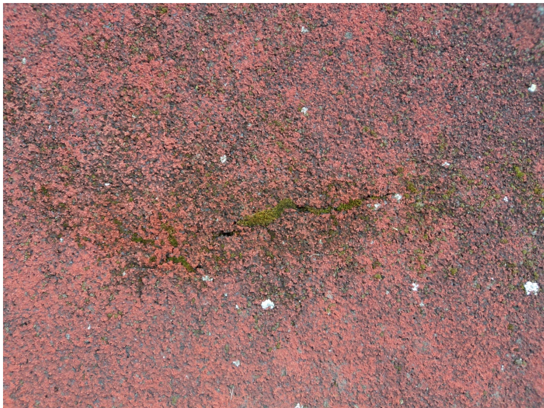
Sprekker i kunststoffdekke, gjengrodd med mose. De hvite flekkene er lav
