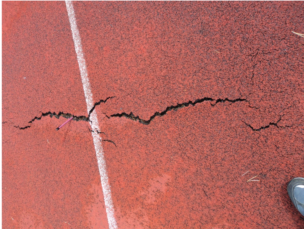
Typiske sprekker i kunststoffdekket
