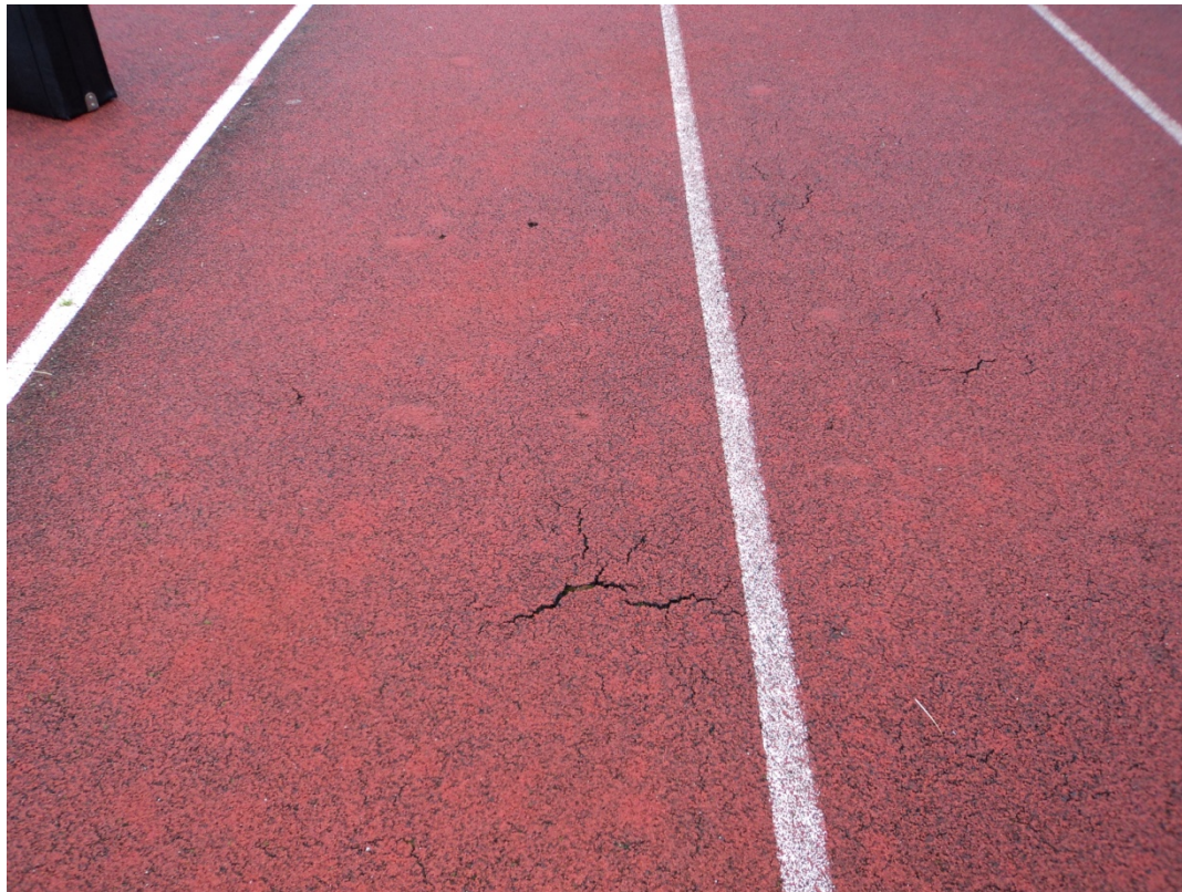
Sprekker, krakelering av kunststoffdekket
