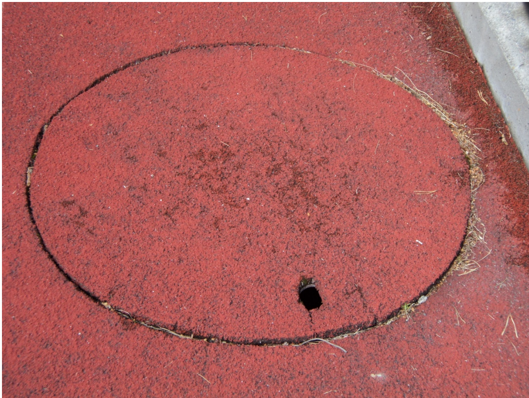
Lokk over trekkekum i areal med kunststoffdekke
