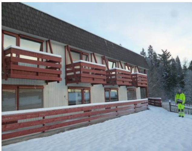
Bilde 13: I forbindelse med fasader er det benyttet trykkimpregnert trevirke (CCA) på balkongenes rekkverk, stendere og i terrassebord. Enkelte av bordene og platingene har Cu-impregnert trevirke som ikke er farlig avfall, men dette må i så fall skilles ved hjelp av en XRF (miljøpistol) under rivearbeidene. Dette fordi Cu-impregnert trevirke og CCA-impregnert trevirke ikke lar seg skille kun ved visuell inspeksjon.
