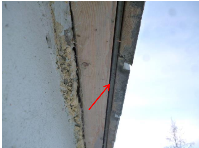
Bilde 2: Asbestholdige internittplater er benyttet som vindsperre bak kledningen på begge fløyer.
