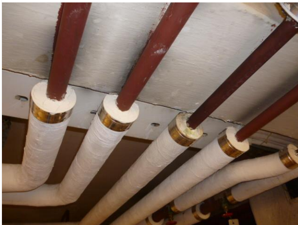
Bilde 7: Antatt asbestholdige mansjetter/endestykker i kjelleren.
