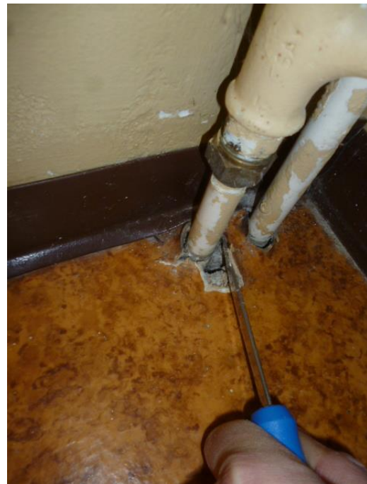
Bilde 8: I bygget finnes det en rekke gjennomføringer for servanter og radiatorer. Det ble ikke observert asbestholdige tråder eller isolasjon i forbindelse med gjennomføringene i byggene.
