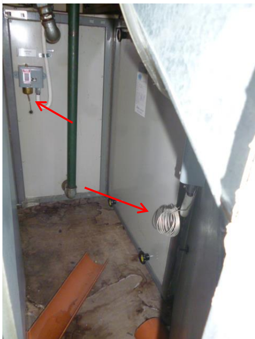
Bilde 21: Kvikksølvholdige termostater ved det ventilasjonstekniske rommet på plan 3 i 1956-delen av bygget.
