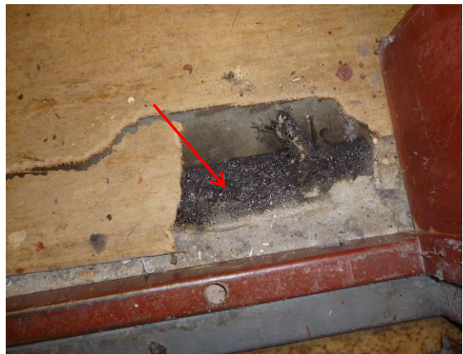
Bilde 12: Under den blyholdige linoleumen på ventilasjonsrommet på plan 3 i vestfløyen ble det funnet sort lim som inneholdt olje. Det ble ikke påvist asbest i limet. Limet medfører at den underliggende betongen er lavforurenset med hensyn til olje og tungmetaller – hvis det skal foretas rivearbeider/hulltaking i betongen her.
