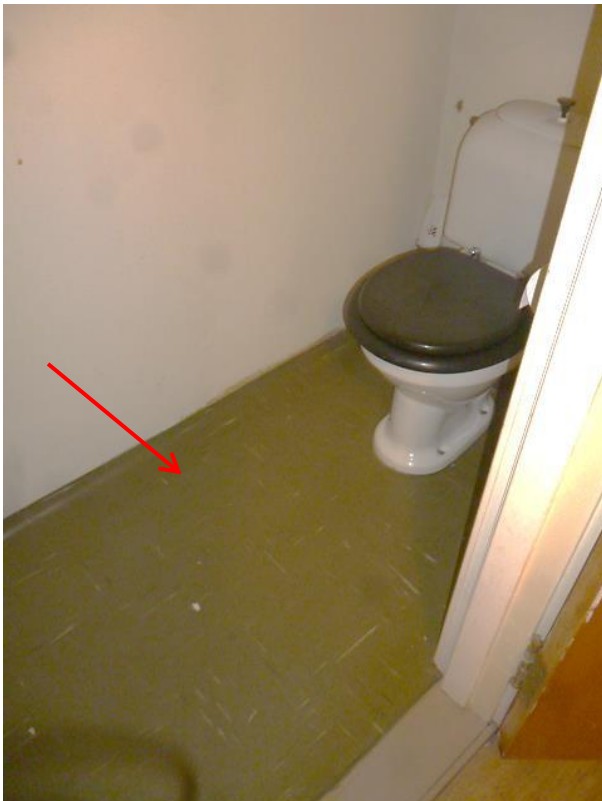
Bilde 3: Bildet viser asbestholdige gulvfliser som er benyttet på toalett på plan 3 i 1956-delen av vestfløyen.
