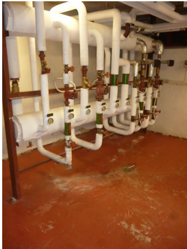
Bilde 4: Asbestholdig rørisolasjon i fyrrommet i kjelleren i bygget. Merk at selv om det ikke ble påvist asbest i prøvene som ble tatt av isolasjonen her, så er det likevel vurdert som sannsynlig at det vil kunne forekomme asbest i rørmansjetter/endstykker og i rørbendene. Det er derfor anbefalt at disse konstruksjonene asbestsaneres i forbindelse med ombyggingsarbeidene.
