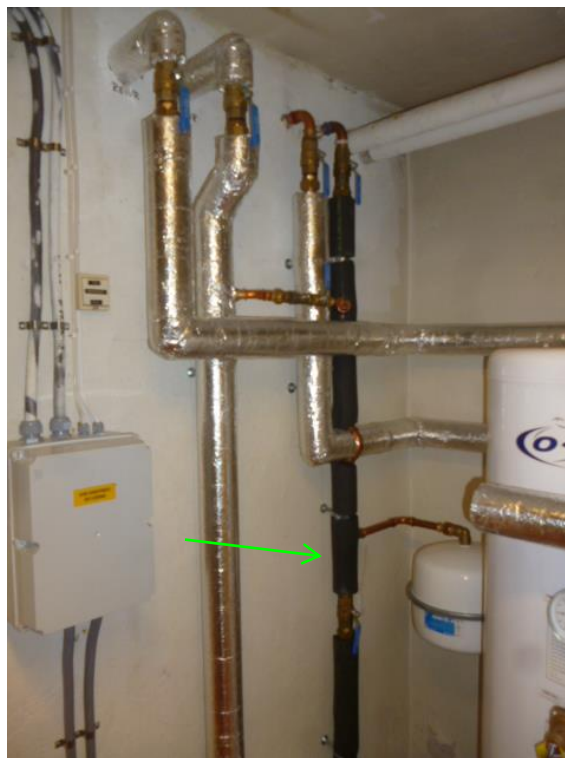
Bilde 26: Cellegummi rørisolasjon finnes stedvis på rørisolasjon i bygget. Bildet viser rørisolasjon i forbindelse med VVS-bereder i kjelleren på vestfløyen. Slik cellegummi rørisolasjon er farlig avfall på grunn av flammehemmere.
