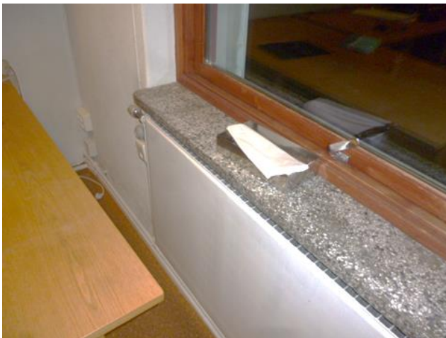
Bilde 19: De fleste av bygningens isolerglassvinduer er farlig avfall med klorparafiner (de fleste av disse er fra 1979). I bygget er det også benyttet vinduer som farlig avfall med ftalater. I bildet vises også at det er benyttet terrasso sålebenker/vindusbrett i forbindelse med vinduskarmer i bygget. Bildet er tatt fra 1956-delen av vestfløyen i bygget. I den eldste delen av bygget er det for det meste benyttet enkeltglassvinduer (spesielt på plan 3 og i kjeller).
