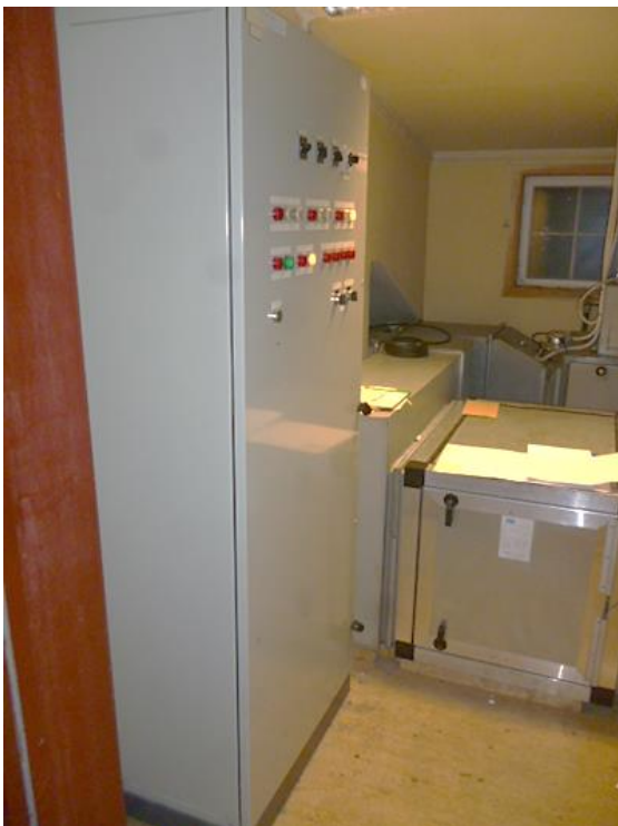
Bilde 11: Blyholdig linoleum finnes på ventilasjonsteknisk rom på plan 3 i vestfløyen.
