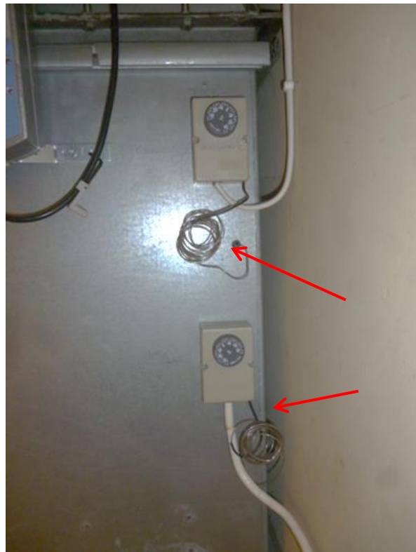
Bilde 20: Kvikksølvholdige termostater ved det ventilasjonstekniske rommet på plan 3 i 1956-delen av bygget. Kapillærrøret inneholder trolig kvikksølv.
