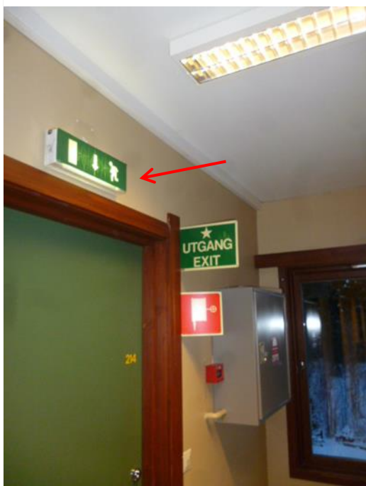
Bilde 23: Ledelys med NiCd-batterier er benyttet i hele bygget. I bildet vises også radioaktive ledeskilter.
