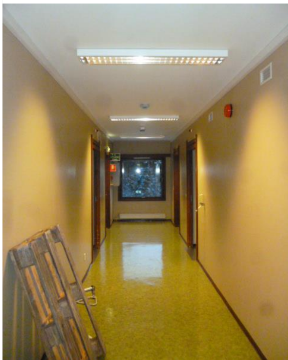
Bilde 15: Innvendige gulv på de aller fleste rom i bygget er belagt med vinyl gulvbelegg som er farlig avfall med ftalater. I østfløyen skal det rives stedvis både lettvegger, gulvbelegg og oppbygde gulv.
