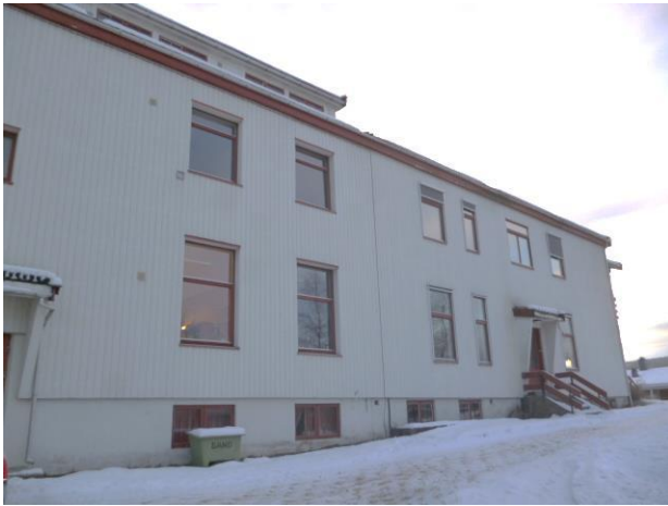
Bilde 1: Fasadene på begge fløyer har stående trekledning. Under trekledningen finnes det asbestholdige internittplater. I tiltakene er det planlagt å fjerne kledningen og de underliggende asbestholdige internittplatene.
