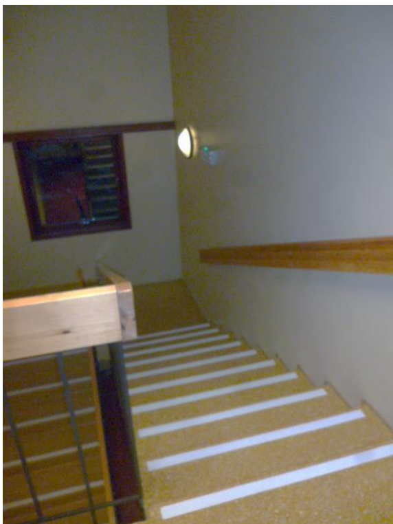
Bilde 25: I flere av byggets trapper er det benyttet terrasso. Trappene er ikke planlagt omfattet av tiltaket, men slik terrasso kan erfaringsmessig inneholde PCB. Dette må undersøkes hvis trappene likevel skal rives i tiltaket.
