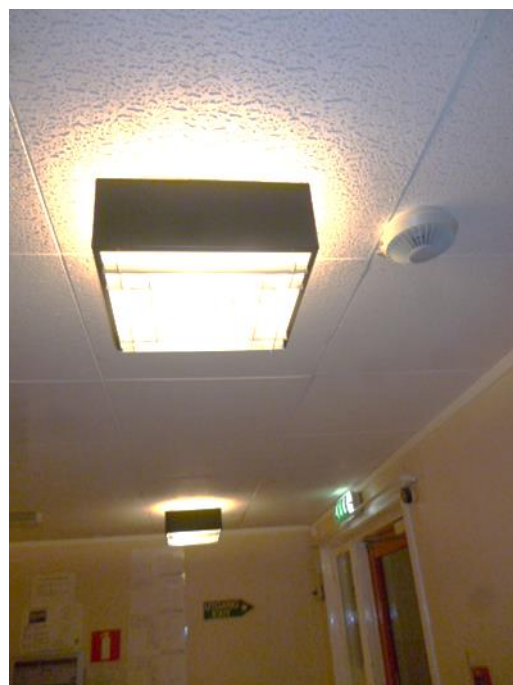
Bilde 24: Det er normale forekomster av elektriske kabler og komponenter i bygget. De fleste lysarmaturer i bygget skal være skiftet ut i forbindelse med PCB-prosjektet i 2007/2008.
