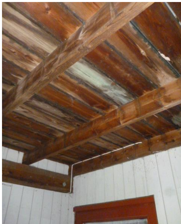
Bilde 14: Undersiden av balkonger er kontrollert med XRF-miljøpistol og trevirket er trykkimpregnert med krom-kobber og arsen (CCA).
