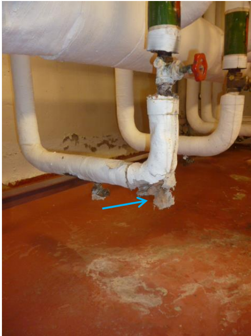
Bilde 5: Skadd rørbeind på samlestock i fyrrommet. Det ble ikke påvist asbest i prøven av rørbeindet her, men det er sannsynlig at det vil kunne finnes asbestholdige isolasjon blant de øvrige rørbeindene i bygget.
