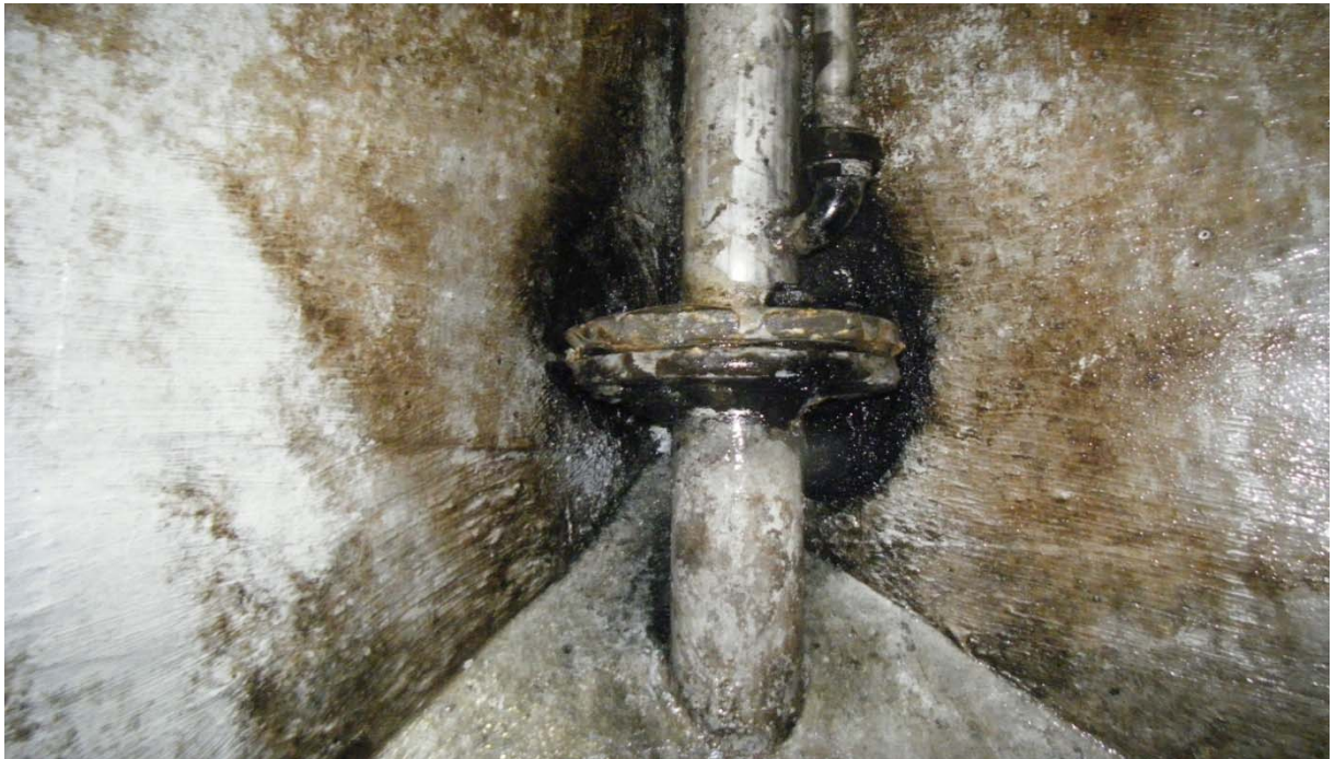
Rør for returslamføring.
