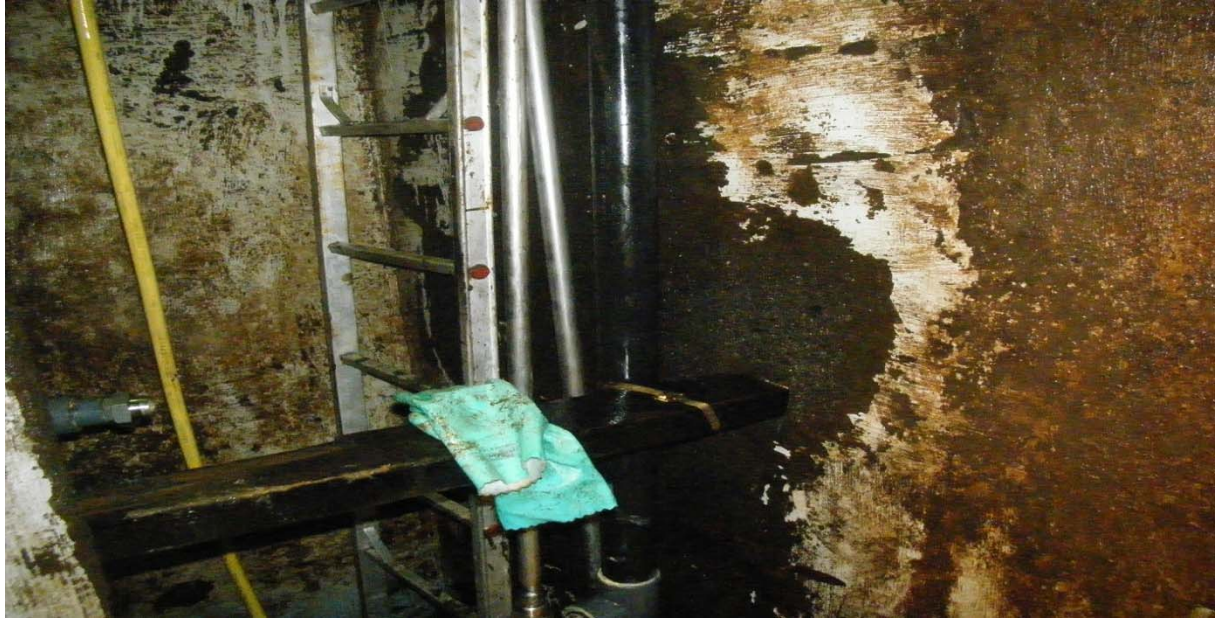
Vegg med stor avskaling av epoxy
