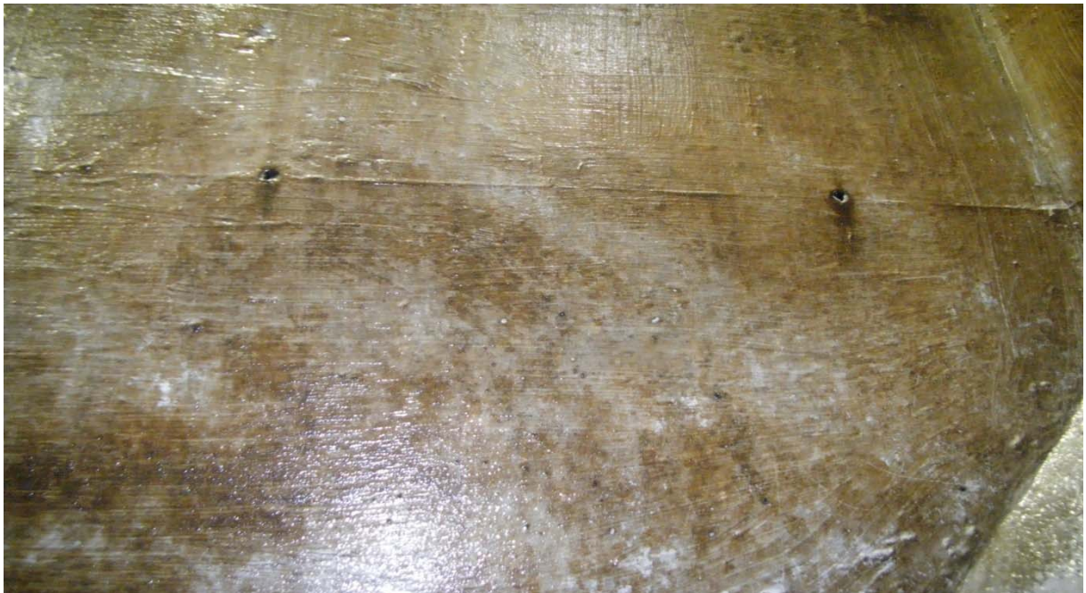
Noen punkter med rustsprenging rundt forskalingsstag
