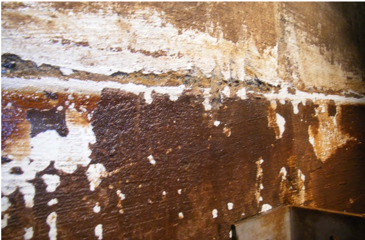
Vegg, overgang frå vannspeil til friluft har noe tæring på betong.
