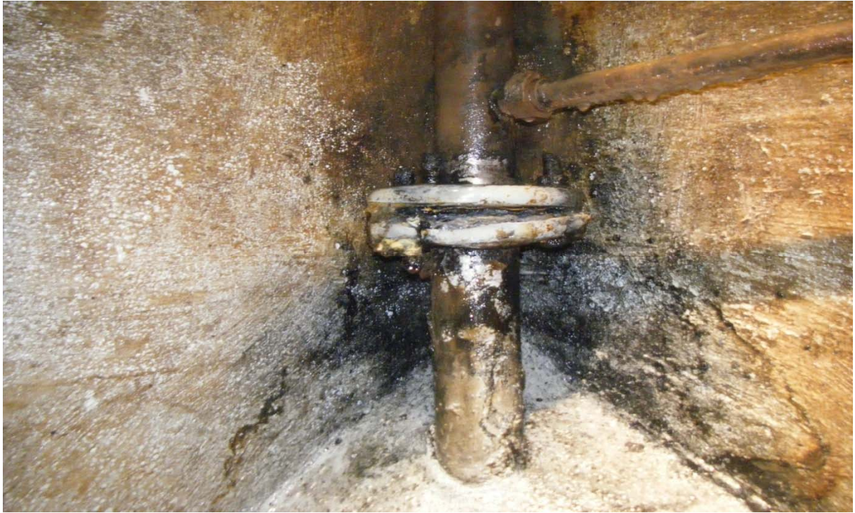
Rør for overskudsslam Mamut pumpe
