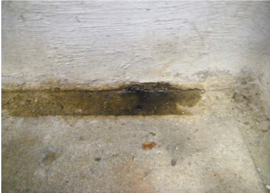
Gjennomslag av fukt frå ettersedementering
