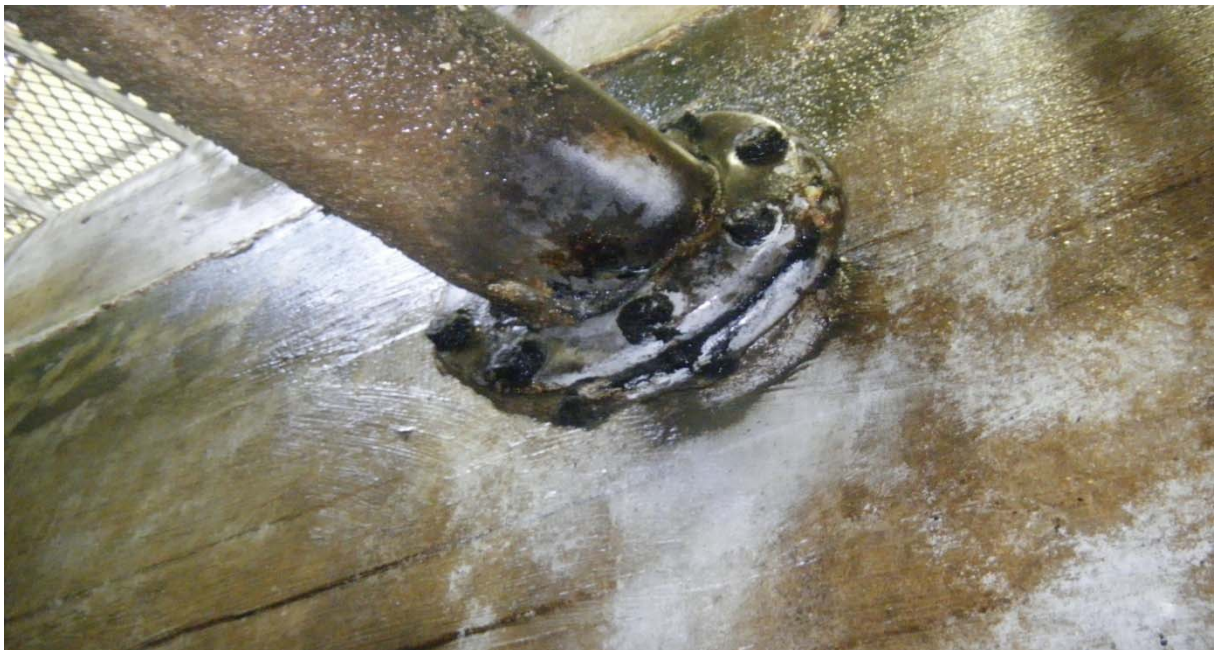
Gjennomføring frå luftebasseng til forsedementering.
