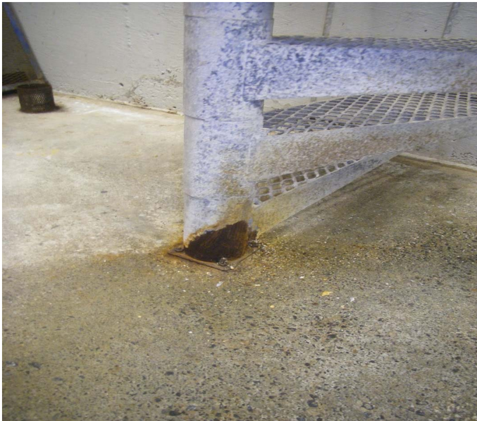
Rust på vindeltrapp
