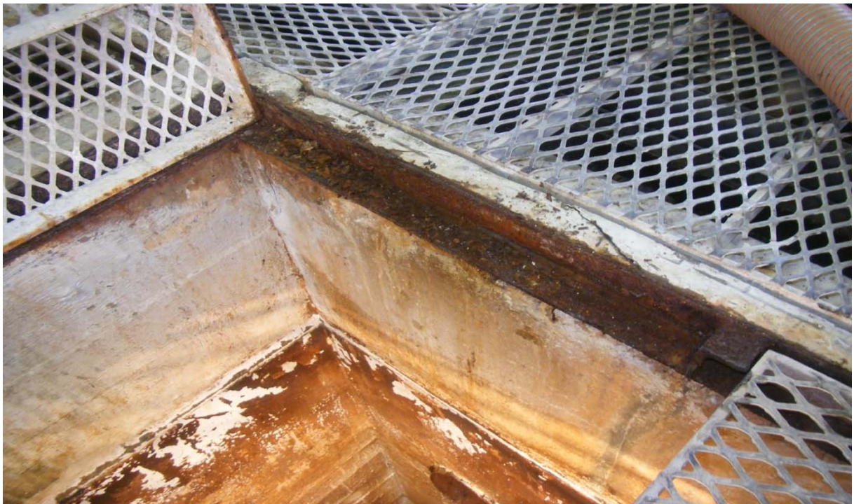
Vinkeljern som er innstøpt for rister i golv har mye rust og det er antydning til utsprenging i betongen
