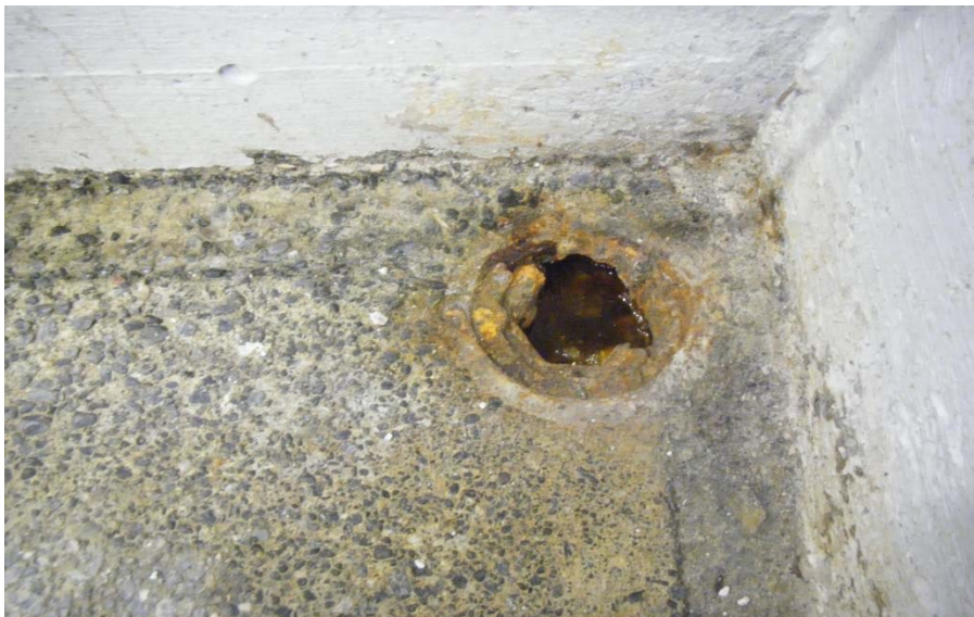
Sluk av jern i dårlig forfatning.
