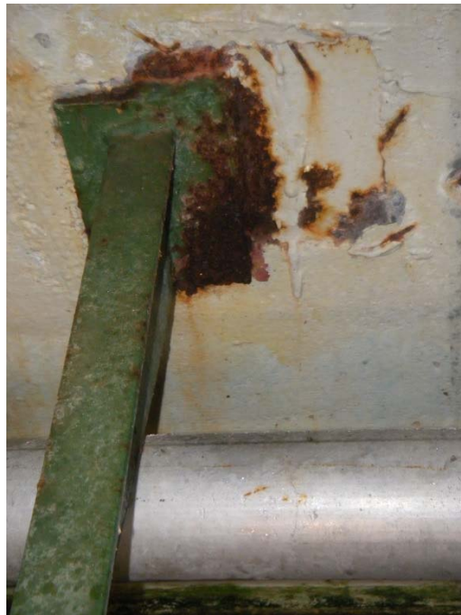
Sveiseplater i stål er innstøpt for fastsetting av braketter, mye rust på plate og braketter
