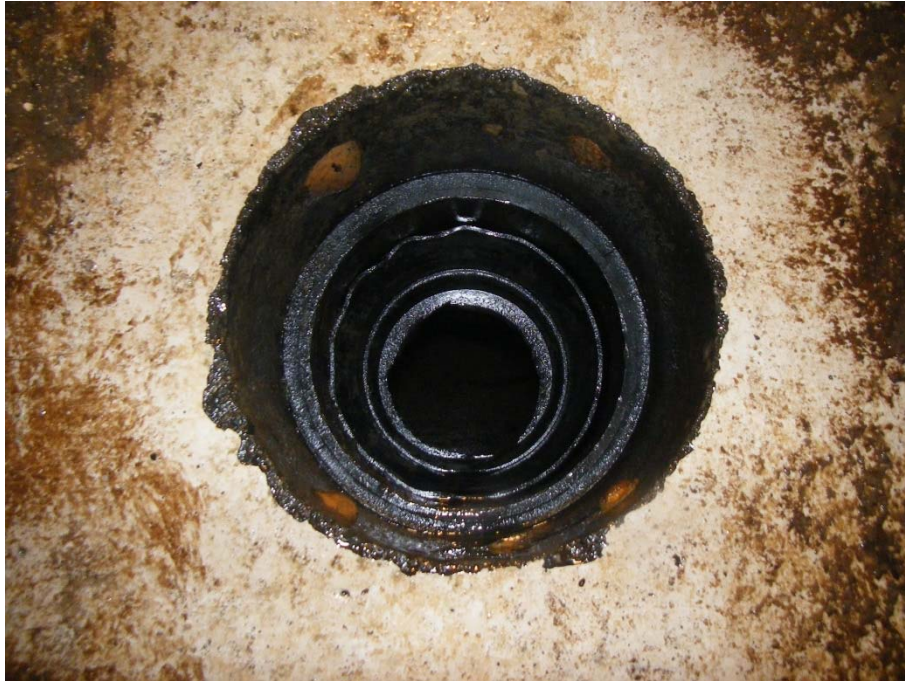
Kjerneboret hull til luftebasseng ubehandlet, rust på armering.
