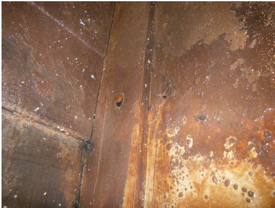
Delingsvegg i tre festet med stålpiker, betongen rundt spiker er løs.
