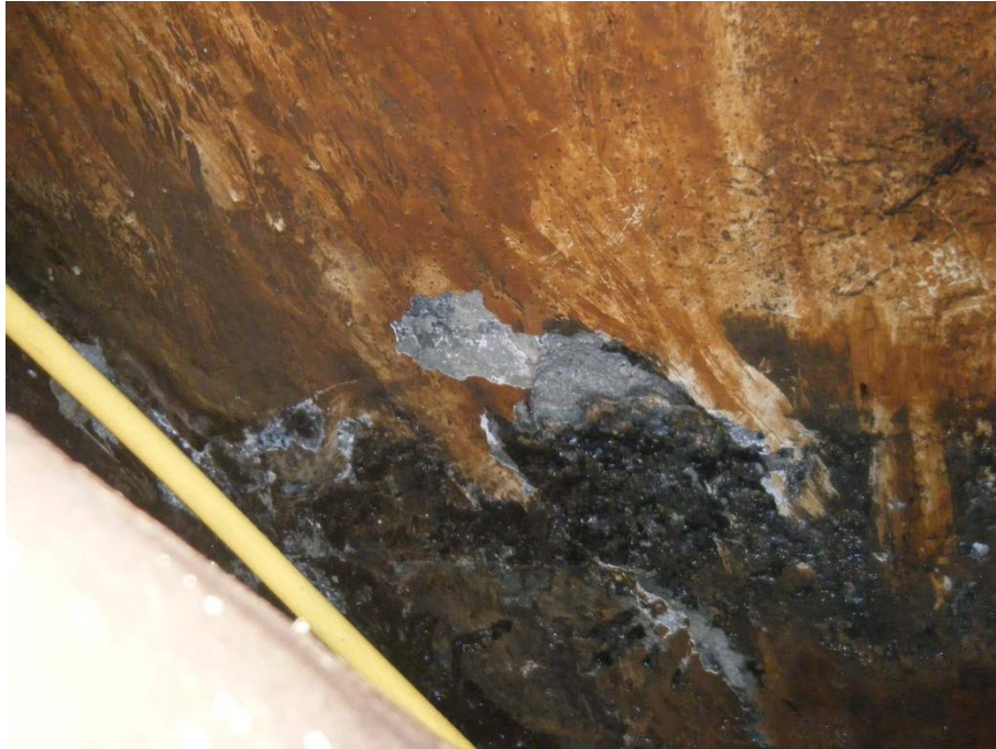
Litt tæring på betongen nederst i ettersedimenterin
