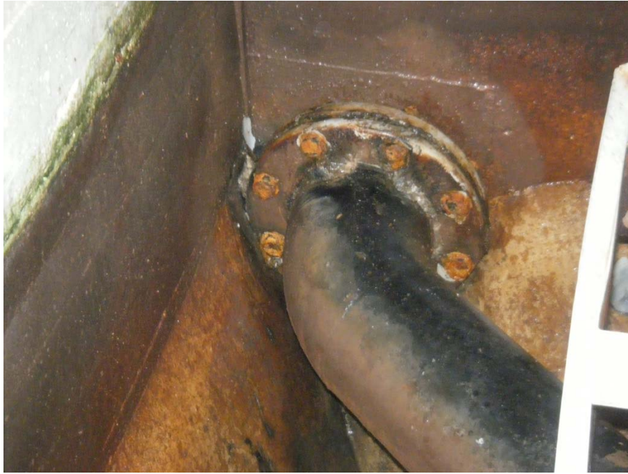
Rør fra flokkulering til etter sedimentering virker ok bolter må vurderes.
