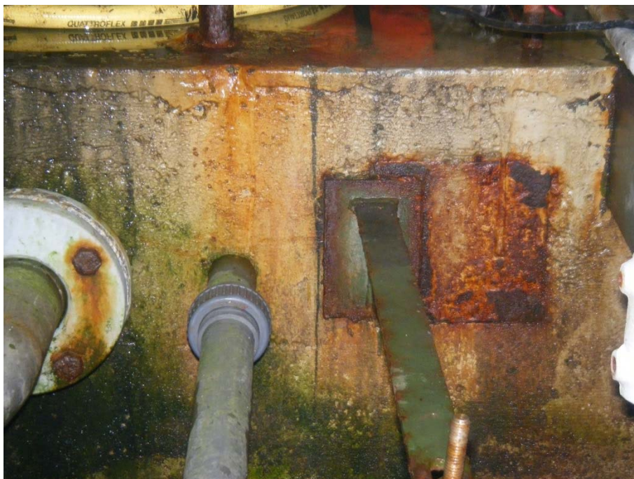
Sveiseplater i stål er innstøpt for fastsetting av braketter, mye rust på plate og braketter
