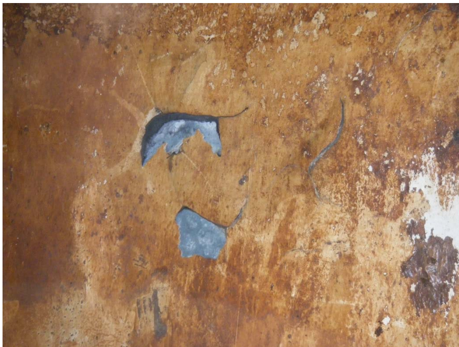
Vegger med mye avskalling av epoxy
