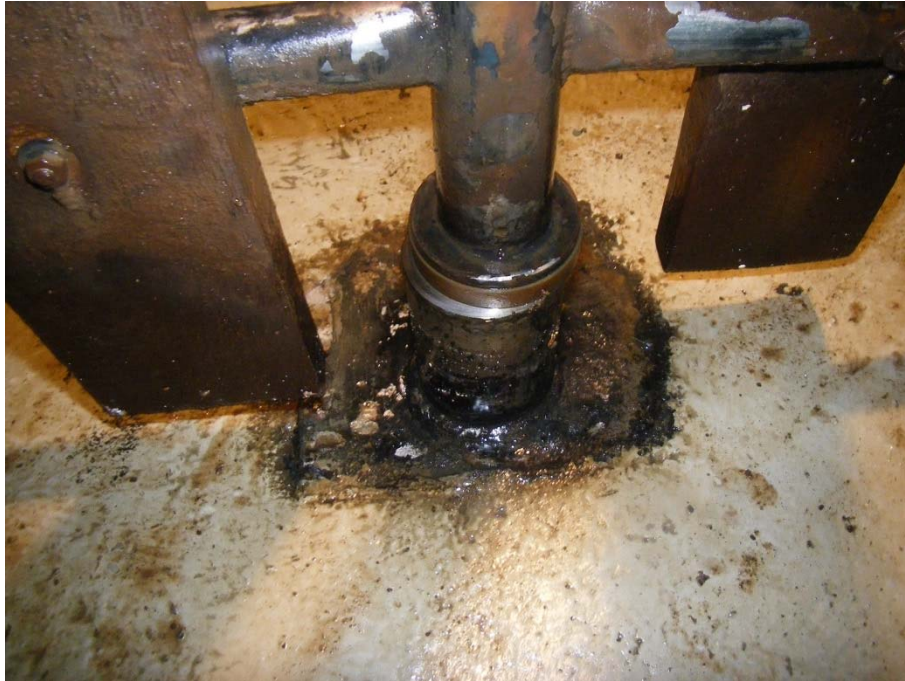
Røreverk med stor slark 6-8 mm. Gjelder begge røreverk.
