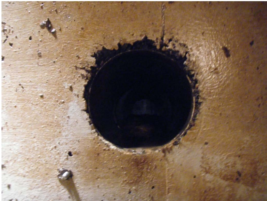
Rør til forsedimentering verker ok sår i betongen rundt hullet
