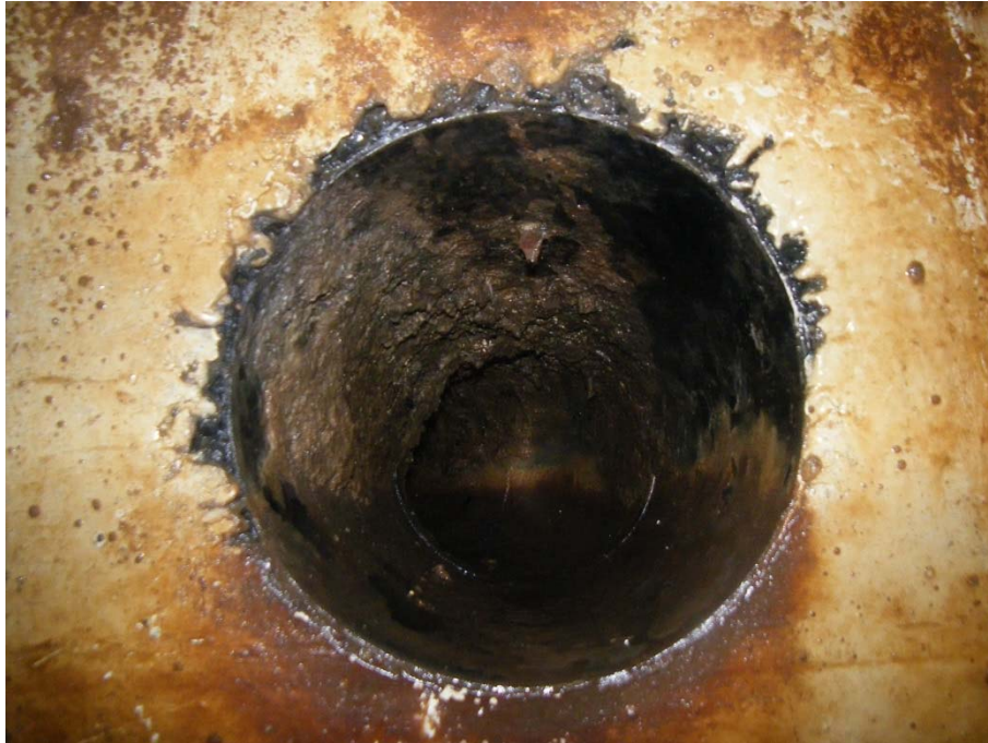
Rør til ettersedemetering verker ok, sår i betongen rundt.
