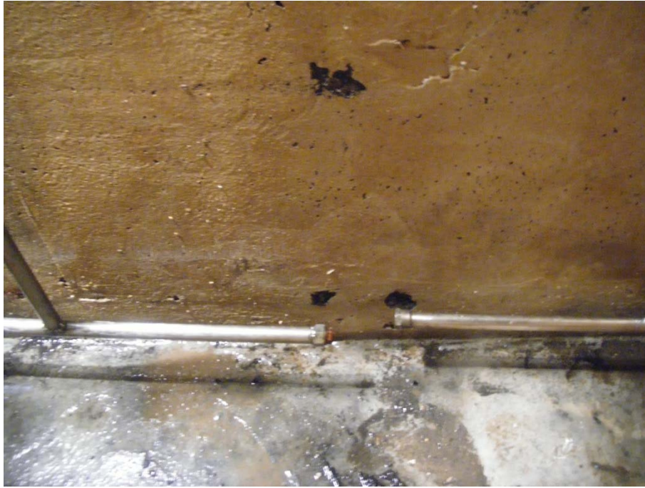
Overgang golv vegg med sår i betongen.
