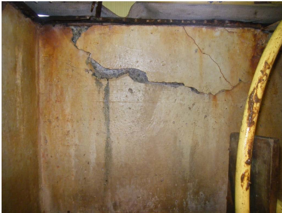
Innstøpte vinkeljern rundt kanten har mye rustsprengning med stor avskaling av betong.
