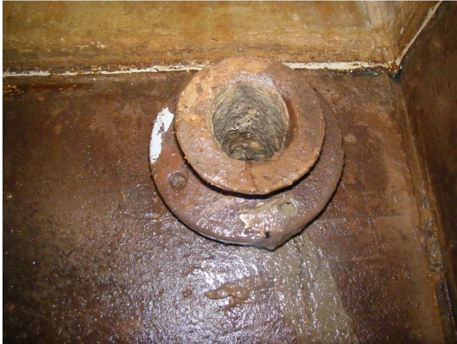
Rør fra forsedemetering med belegg av kjemikalie, røret ser bra ut etter å ha skrapet bort belegg
