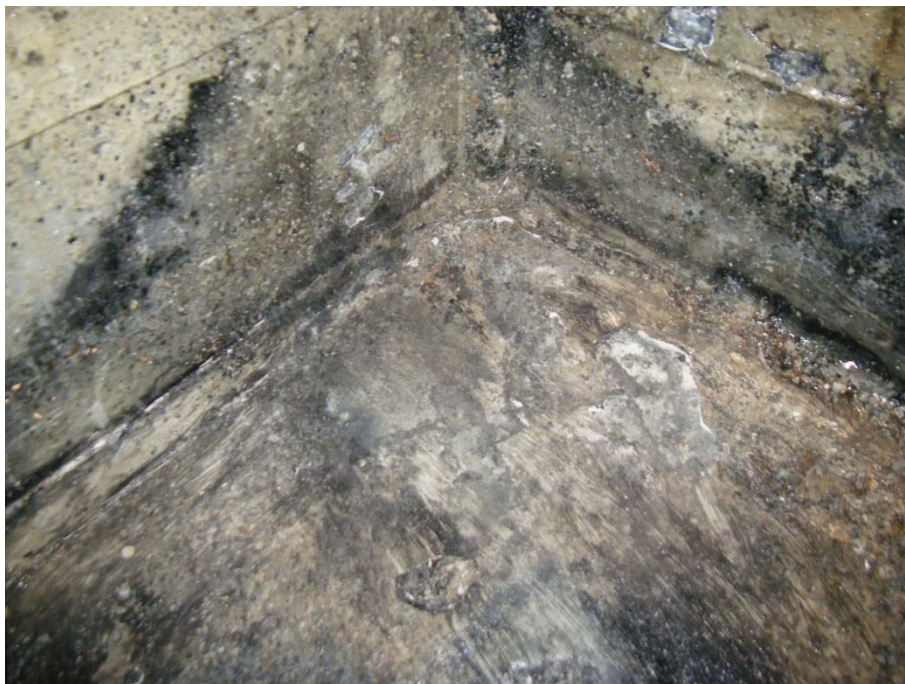
Hjørner i kammer 2 har litt løs betong.
