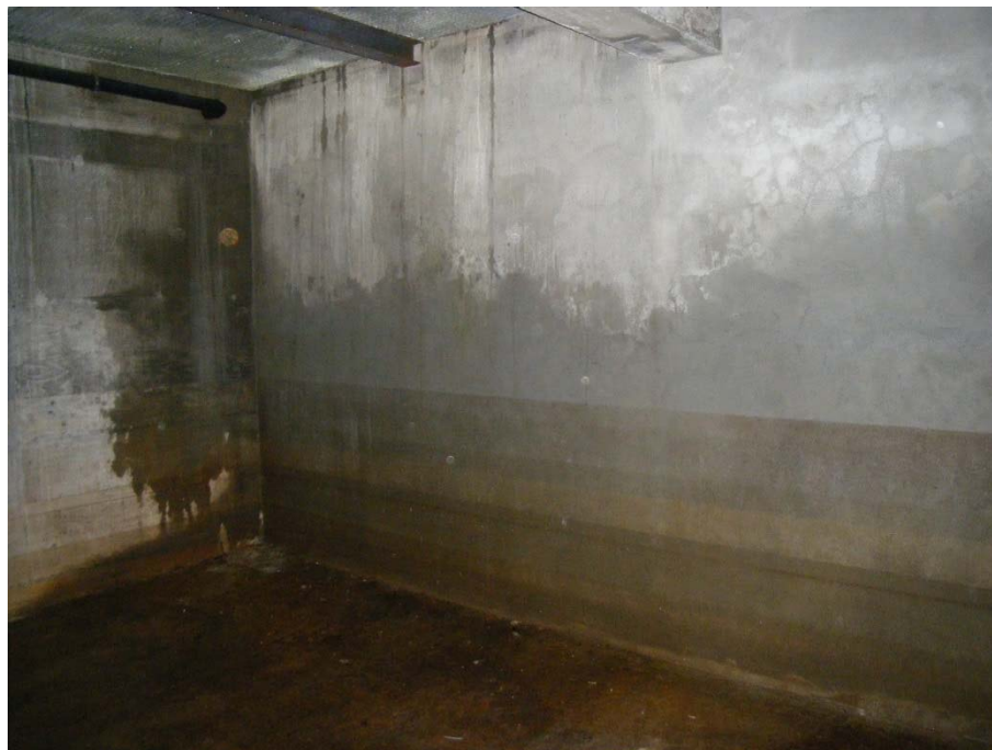
Yttervegg mot elva har fuktgjennomslag
