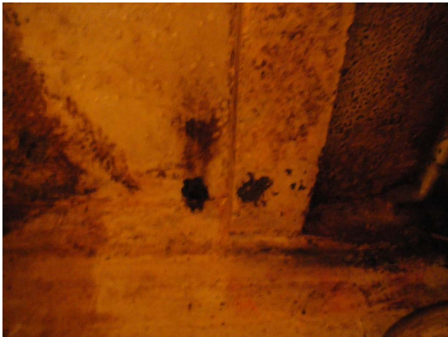
Oppunder dekke med drager i betong avflassing av epoxy
