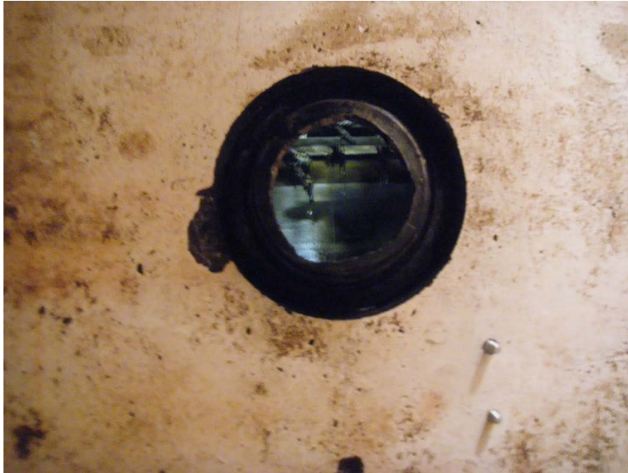
Fra innløp til luftebasseng kjerneboret hull ubehandlet med rust i armering.
