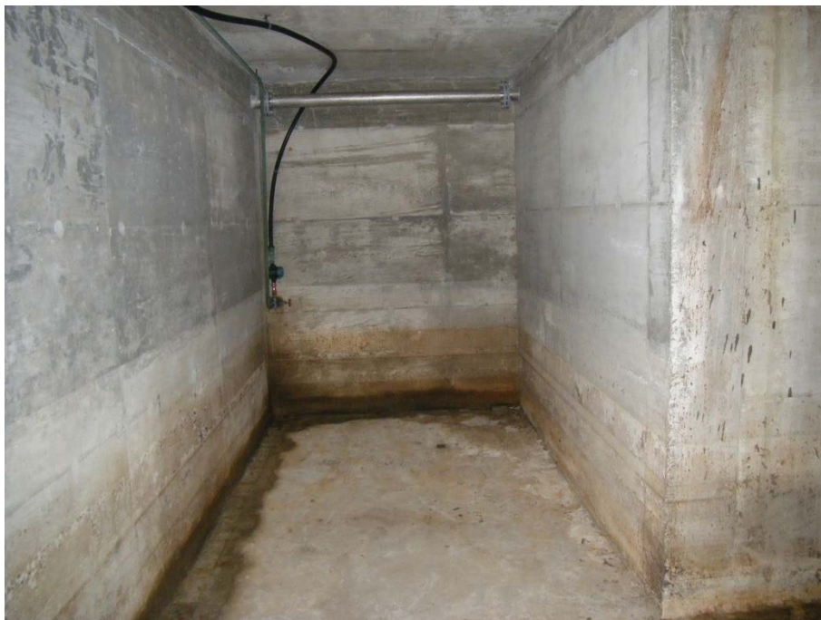
Fuktinnslag overgang gulv vegg.
