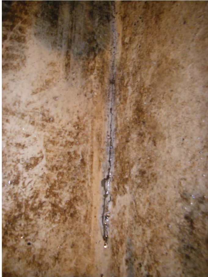
Sprekk i hjørne.
