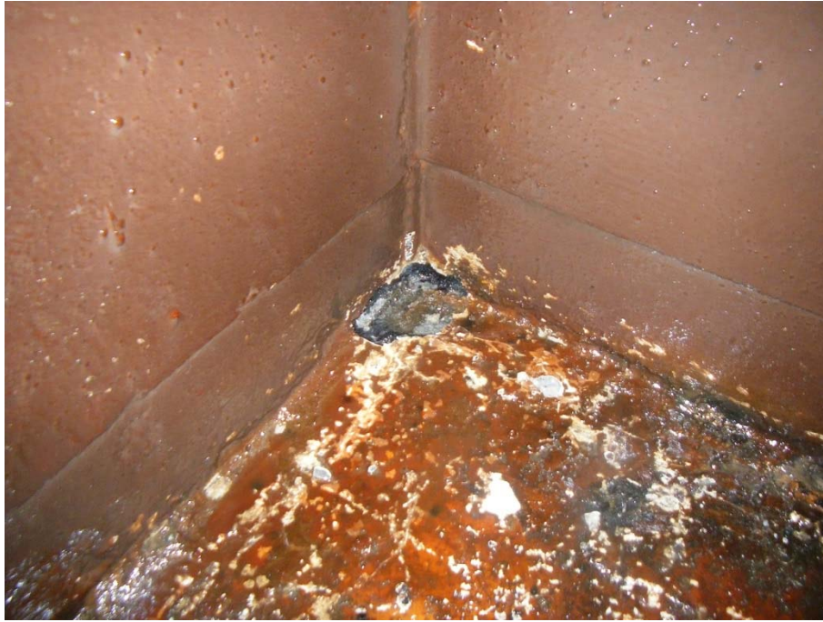
Dårlig punkt i hjørne med løs betong.
