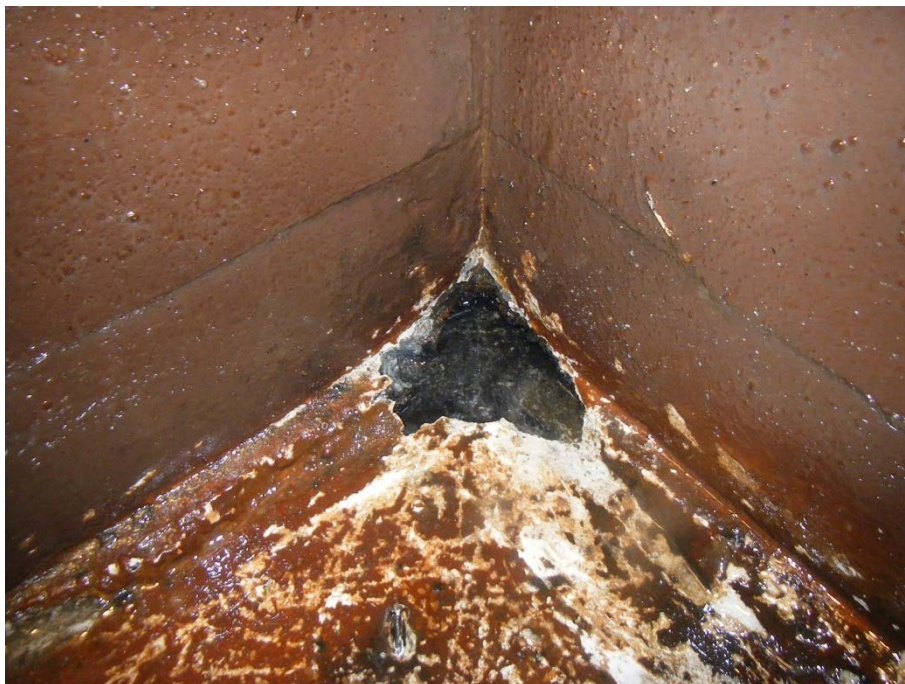
Dårlig punkt i hjørne med løs betong.
