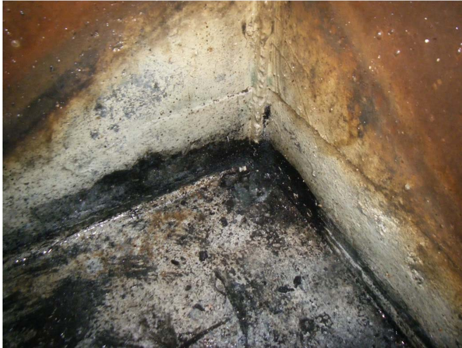
Hjørner i kammer 2 har litt løs betong.
