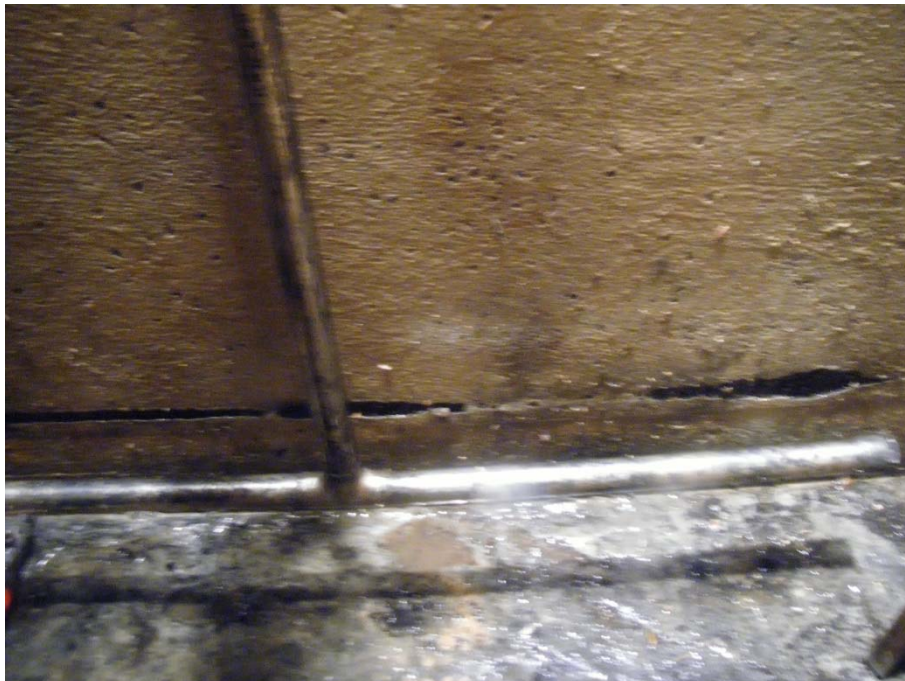
Overgang golv vegg med sår i betongen.
