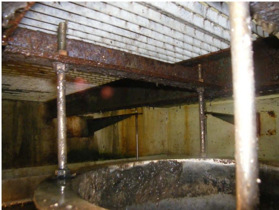
Stålbjelker og innfesting av sedimenteringsrør har mye rust.
