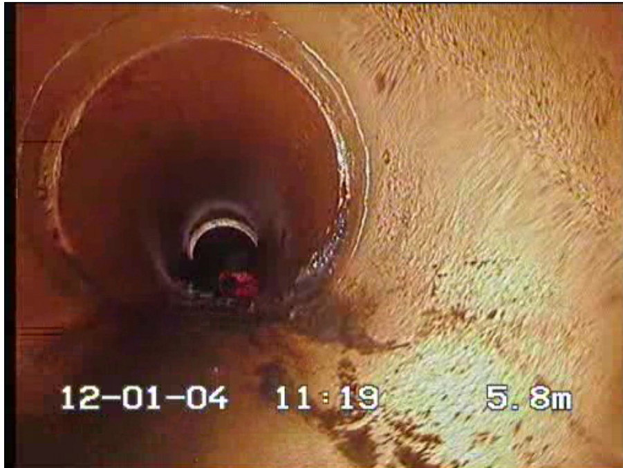
Foto: S_Sectionname040120125,8SR2_A.jpg 5,8m, Sprukket rør, sprekkene er åpne/løse teglstein, fra 12 til 12 Kl., Kompleks
