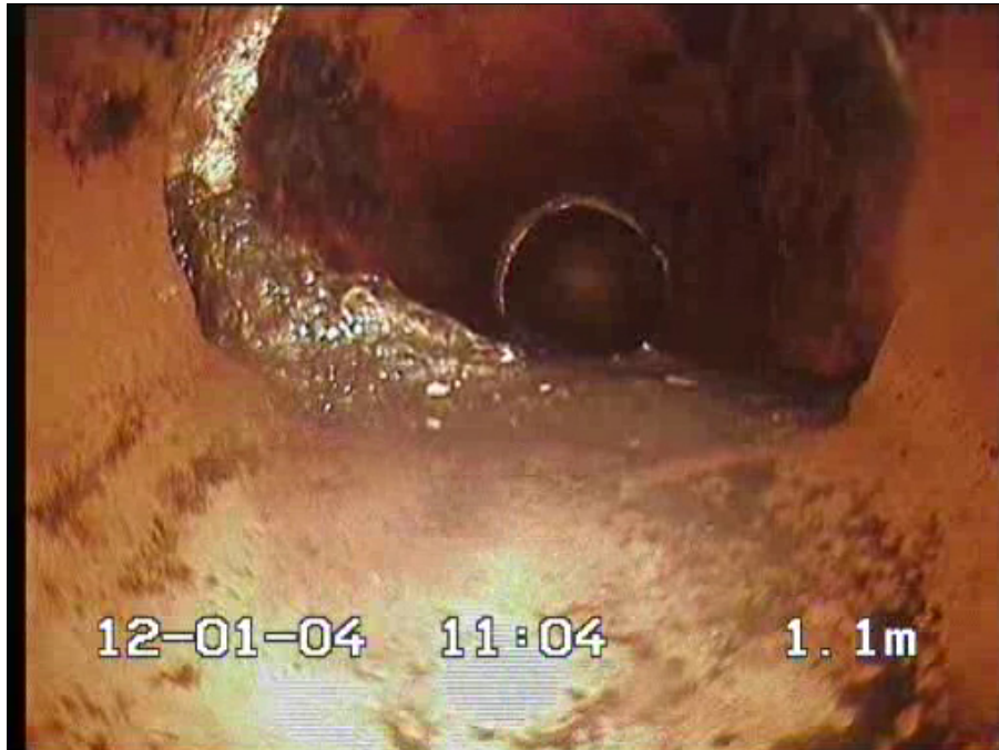
Foto: S_Sectionname040120121,1UB2_A.jpg 1,1m, Utfelling/Belegg, reduksjon i tverrsnittsarealet er mellom 5 - 15%, fra 05 til 08 Kl., Utfelling
