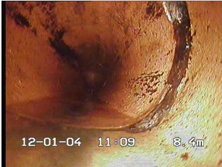
Foto: S_Sectionname040120128,5FS2_A.jpg 8,5m, Forskjøvet skjøt forskyvningen er mellom halve og hele rørtykkelsen, fra 12 til 06 Kl., Vinkelforskjøvet
