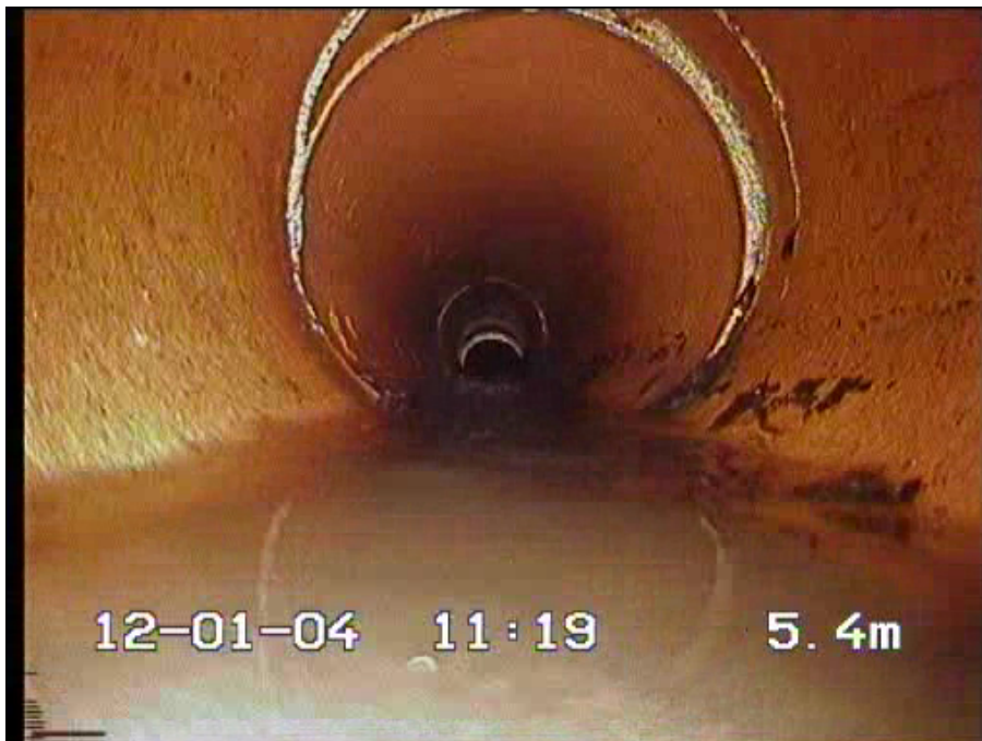
Foto: S_Sectionname040120125,4SR2_A.jpg 5,4m, Sprukket rør, sprekkene er åpne/løse teglstein, fra 08 til 04 Kl., Kompleks
