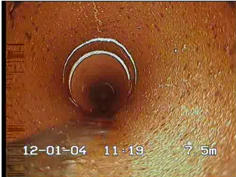
Foto: S_Sectionname040120127,7SR2_A.jpg 7,7m, Sprukket rør, sprekkene er åpne/løse teglstein, fra 12 til 12 Kl., Kompleks
