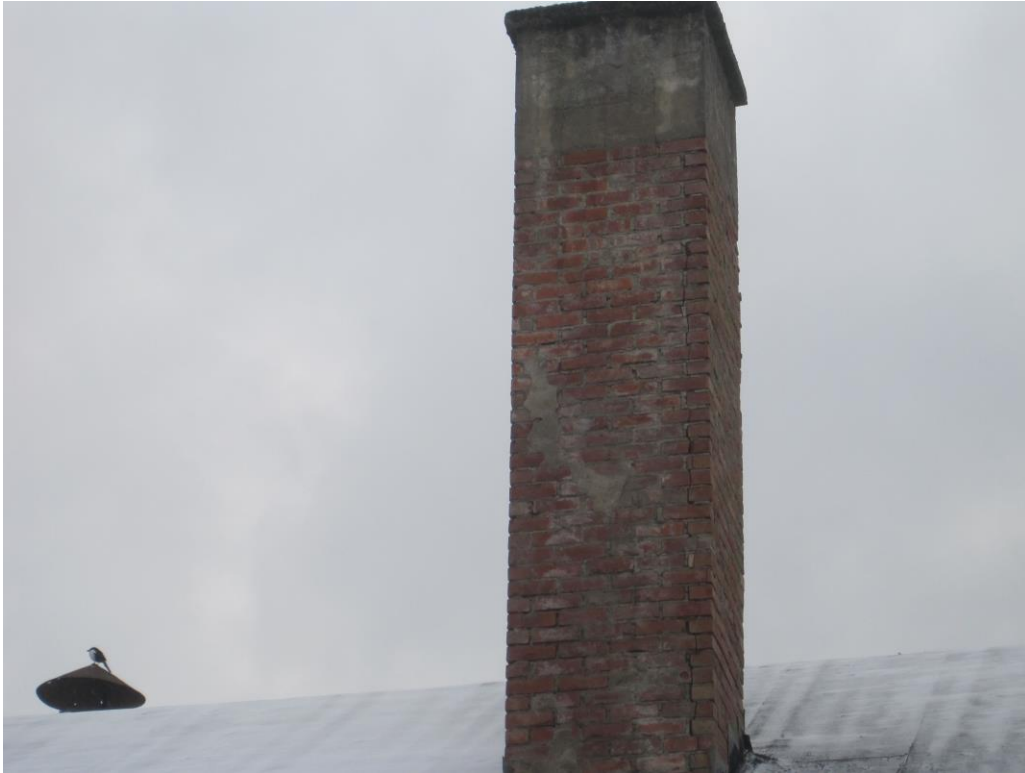
Pipa har store frostskafer og sprekker.
