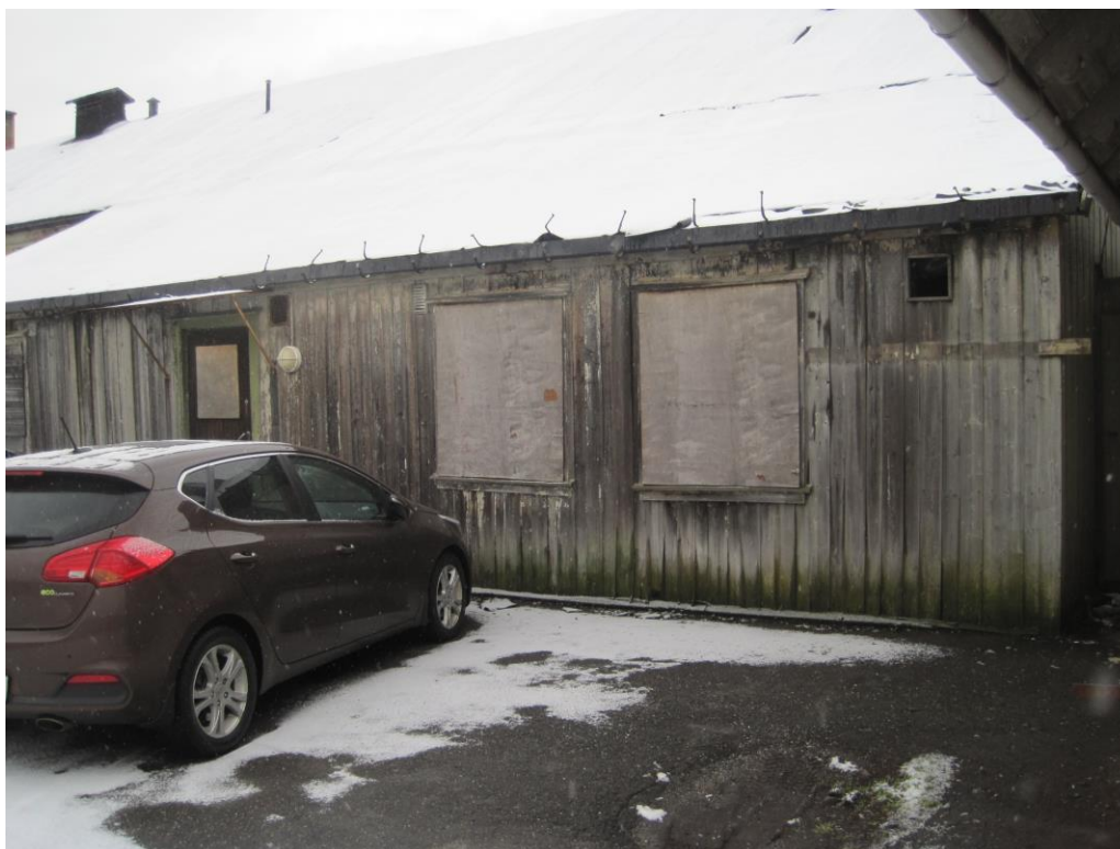
Trehus mot øst er kondemnabelt.
