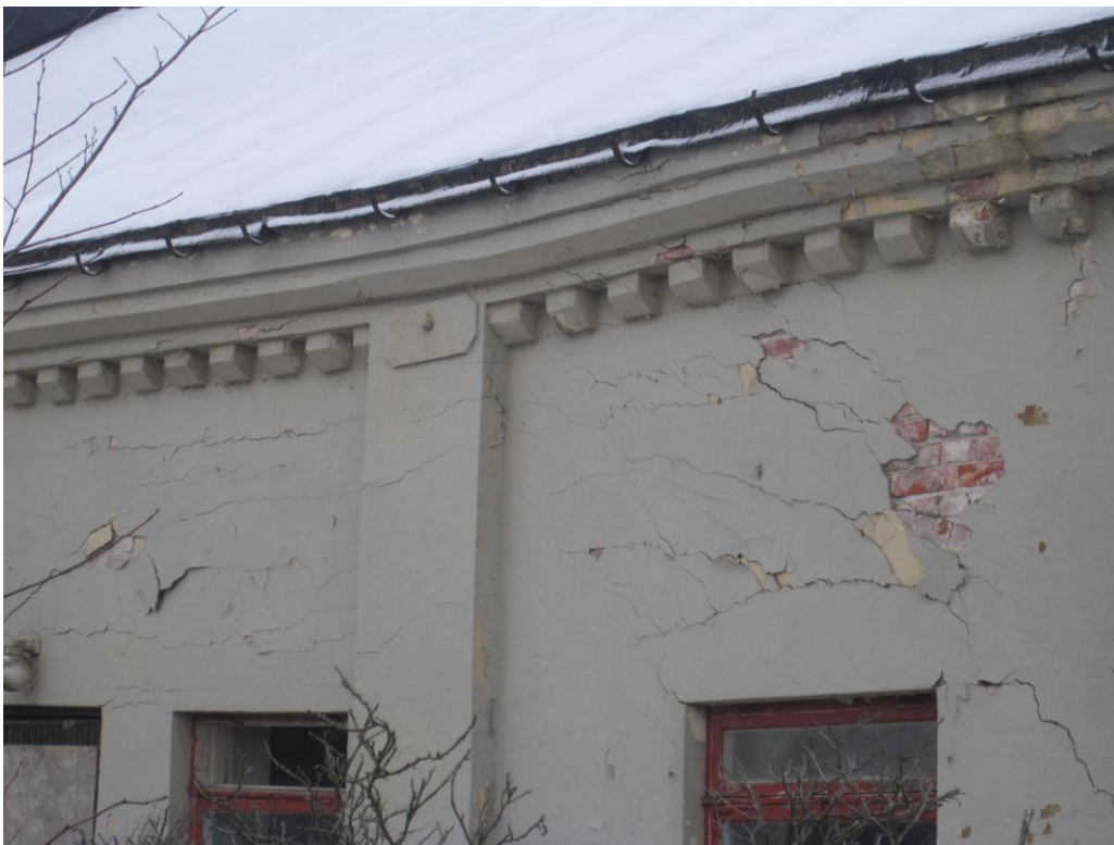
Store skjevheter etter setninger samt sprekker i ytterveggene.
