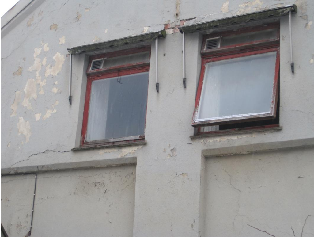
Gavlvegg mot nord. Skadede vinduer, sprekker og frostskeer i veggene.
