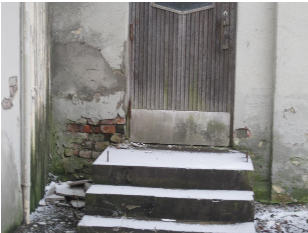
Skadet ytterdør med frostskeer i veggene.
