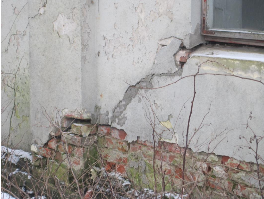
Sprekker og frostskeer i ytterveggene.
