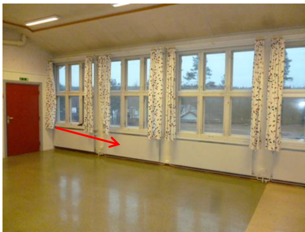
Bilde 14: Veggmaling i klasserommet på plan 2 der ventilasjonsrom skal etableres er farlig avfall med sink (samme rom som bilde 13). Det er usikkert om det blir aktuelt med fjerning av veggfelter her. Vinduene skal tas ut og åpningene skal gjenstøpes.
