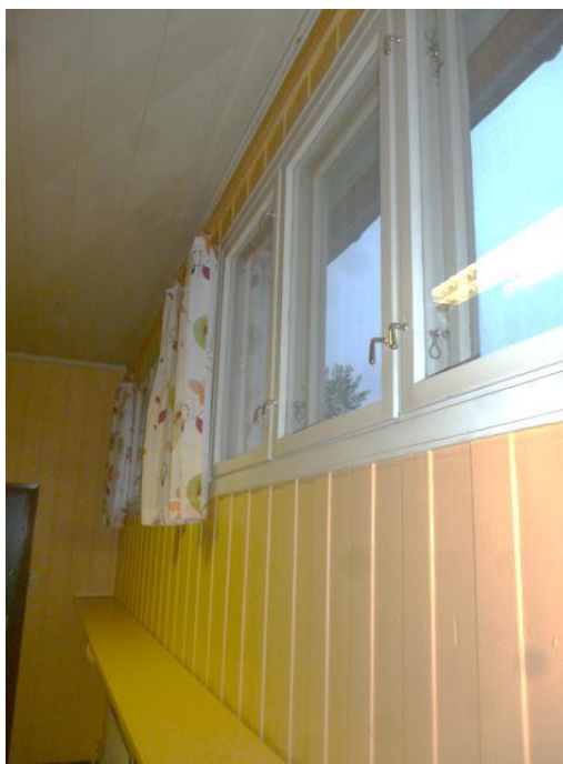
Bilde 16: De fleste av byggenes vinduer er koplede enkeltglassvinduer. Bildet viser korridor på plan 2 i bygg A.
