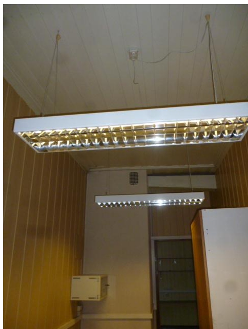
Bilde 15: Det er normale forekomster av elektriske kabler og komponenter i bygget. Disse skal håndteres som EE-avfall. De fleste lysarmaturer i bygget skal være skiftet ut i forbindelse med PCB-prosjektet i 2007/2008.
