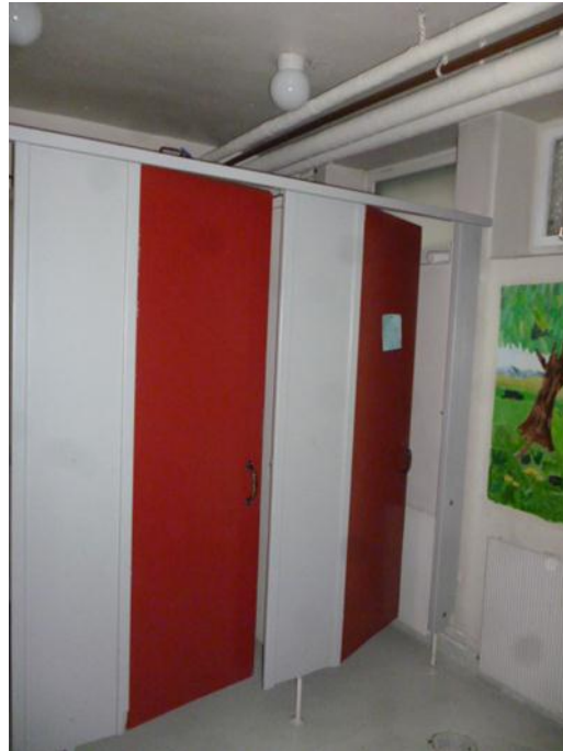
Bilde 6: Ved toaletter i kjelleren er det spanskvegger som eventuelt skal rives. Rørisolasjonen i taket her er asbestholdig.
