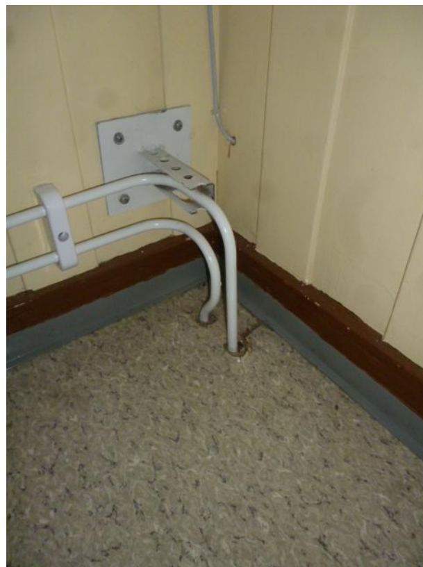
Bilde 10: Vinyl gulvlister er benyttet i ganske stort omfang i bygget. Det er ikke observert asbestholdige gjennomføringer for radiatorer.
