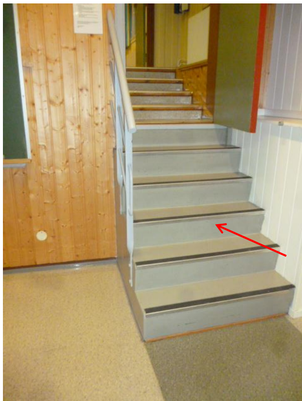
Bilde 13: Betongtrapp på plan 2 i rommet der ventilasjonsrom skal etableres, er farlig avfall på grunn høy konsentrasjon av sink i den grå malingen.
