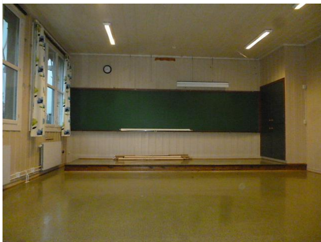
Bilde 9: Innvendige gulv i de aller fleste klasserom er vinyl gulvbelegg som er farlig avfall med ftalater. På plan 2 i hovedbygget (del A) skal det rives både lettvegger, gulvbelegg og oppbygde gulv.
