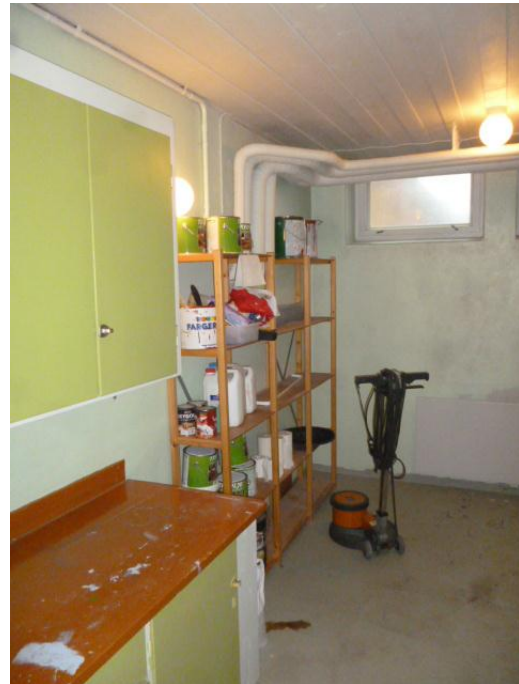
Bilde 2: Asbestholdig rørisolasjon i forbindelse med lagerrom i kjelleren. Rommet er lokalisert sør for kjellertrappen. Det ble ikke funnet annet enn glassvatt i rørbendene her, men ikke alle rørbend ble detaljkartlagt. Rørmansjetter med hardt kitt er asbestholdige.
