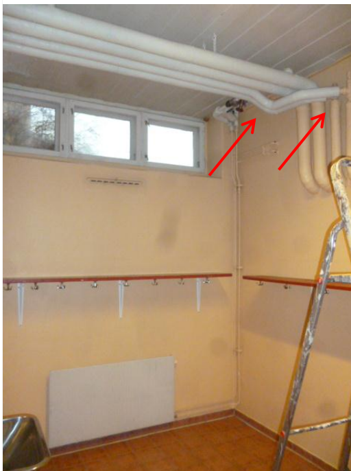
Bilde 3: Garderobe i U1 – der heis skal etableres ned i kjelleren. Eksisterende rør i taket kommer i konflikt med heissjakt, og vil måtte asbestsaneres. Se også bilde 4.
