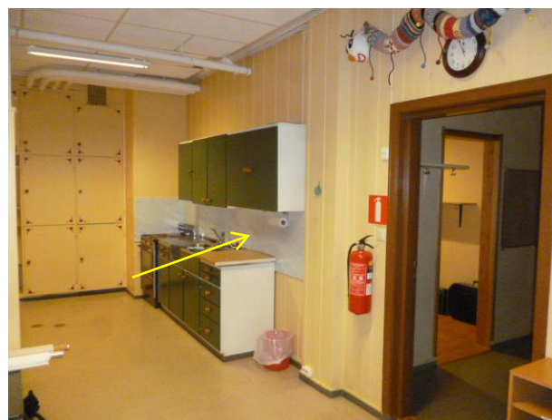
Bilde 12: Innvendige lyseblå veggplater i klasserom i mellombygg i kjelleretasjen er marmorimiterte, og er antatt å være farlig avfall med pentaklorfenol.
