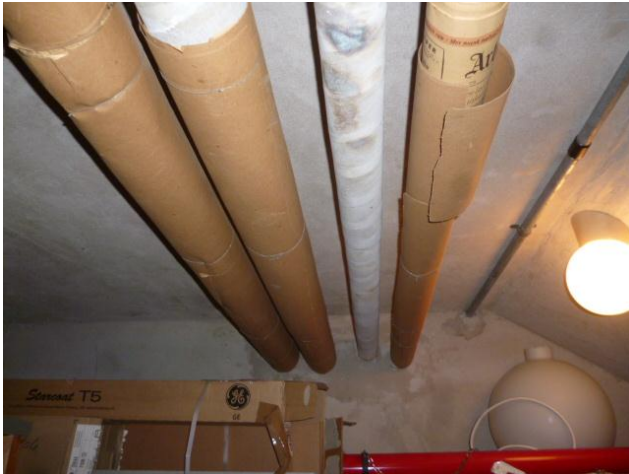
Bilde 5: I laggerommet under trappen i kjeller er det asbestholdig kitt på rørmansjetter/endestykker. Rørene vil trolig måtte fjernes, da det er prosjektert dør inn i rommet der rørene kommer inn i dette rommet.
