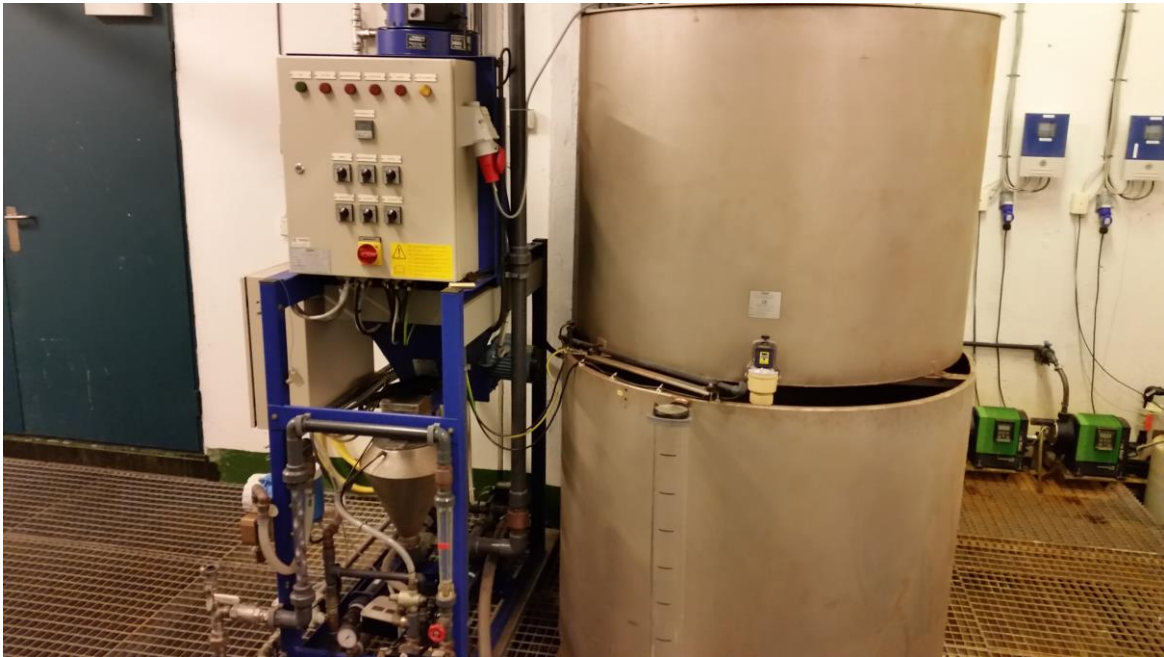
Figur 3. Polymerdoseringsanlegg for foravvanner for HRA-slam.
