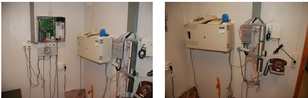
Kommunikasjonsutstyr og koplinger i «telefonsentral rom» i kjeller
