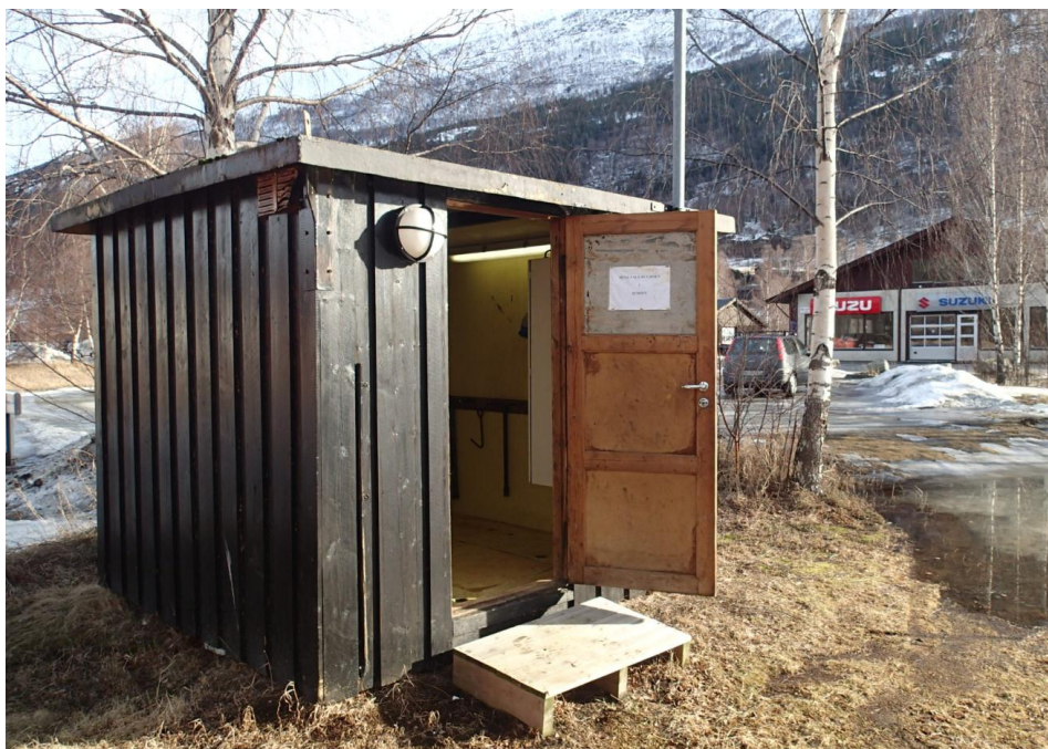
Figur 2 Både overbygg og pumpeump i nåværende pumpestasjon er i en slik stand at skal erstattes av en helt ny stasjon.
