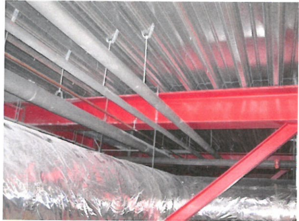
Foto 6: I teknisk mellometasje under operasjonsavdelingen er det store mengder cellegummi.
