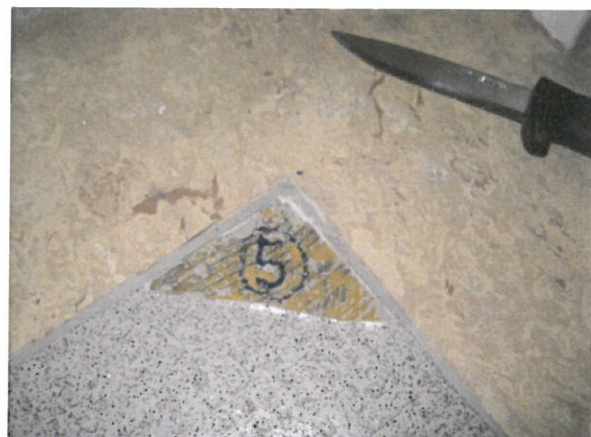
Foto Prøve 5 av sklisikkert gulvbelegg i vaskerom tilhørende operasjonsrom viser innhold av mindre mengder tungmetaller og ftalater over grense for farlig avfall
