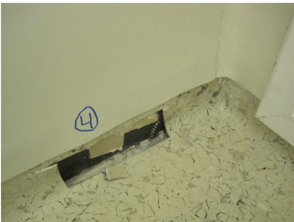
Foto 2: Prøve 4 av gulvbelegg i operasjonsrom viser innhold av mindre mengder tungmetaller og ftalater over grense for farlig avfall
