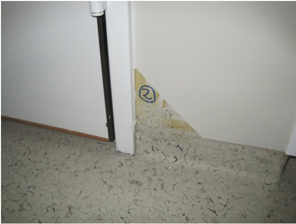
Foto 1: Prøve 2 av vinyltapet på vegg inneholder mindre mengder tungmetaller, og ftalater over grense for farlig avfall.
