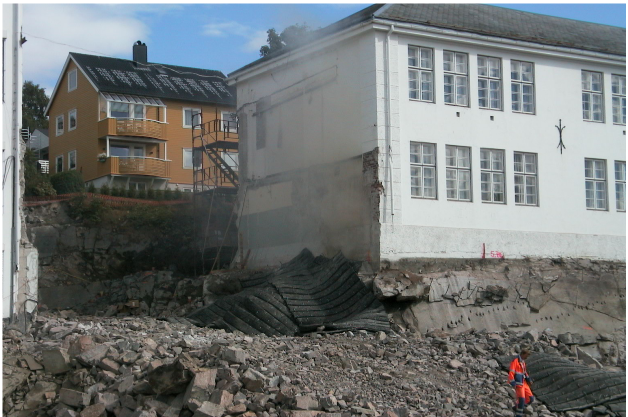
2005-08-04 Hjørne sørøst C og hjørne sørvest A, mot nordøst. 3. – 4. etasje i A.
