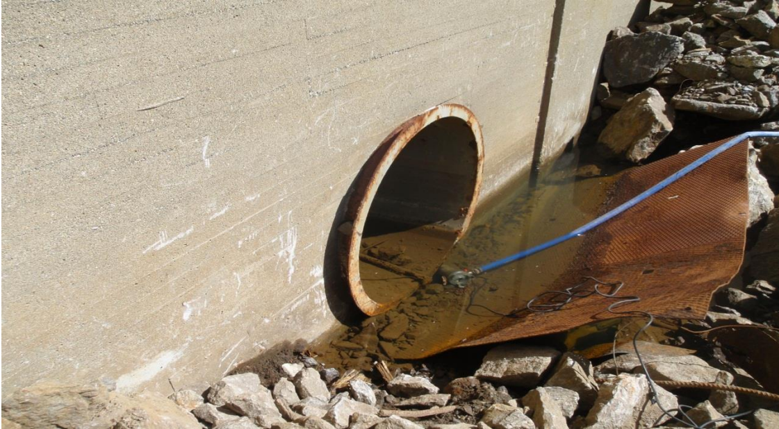
Utstikkende rør med flens
