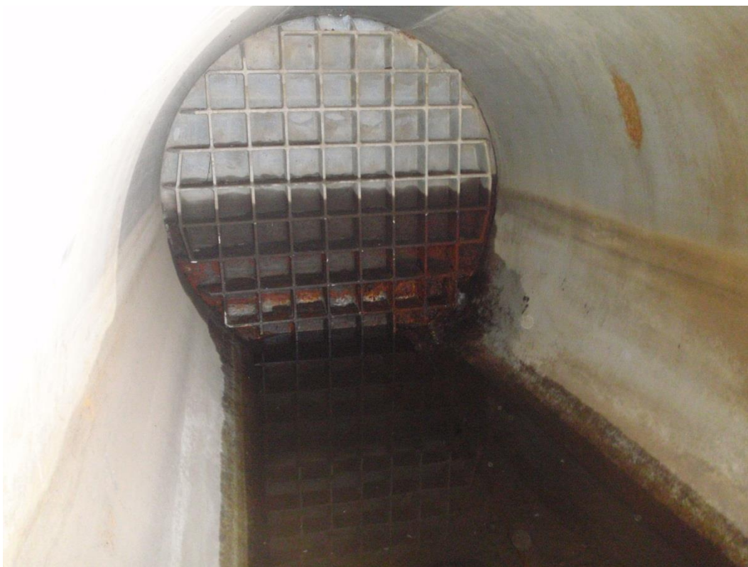
Luftside av eksisterende luke.
