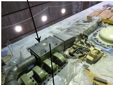
Eksisterende vifte med filter
