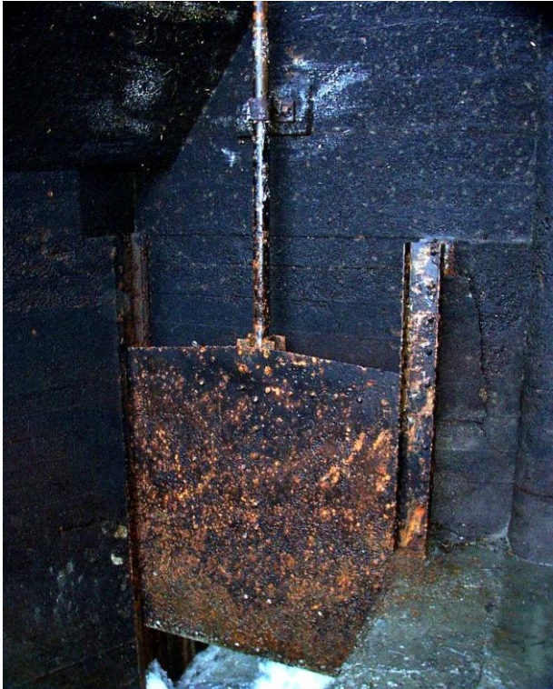
Bilde nr 5: Tappeluke med lukeføring. NB! Luke støter mot betongoverløp dersom den heves ut av lukeføring (Nordre bunnluke)
