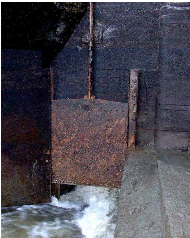
Bilde nr 6: Tappeluke med lukeføring. NB! Luke støter mot betongoverløp dersom den heves ut av lukeføring (Nordre bunnluke)
