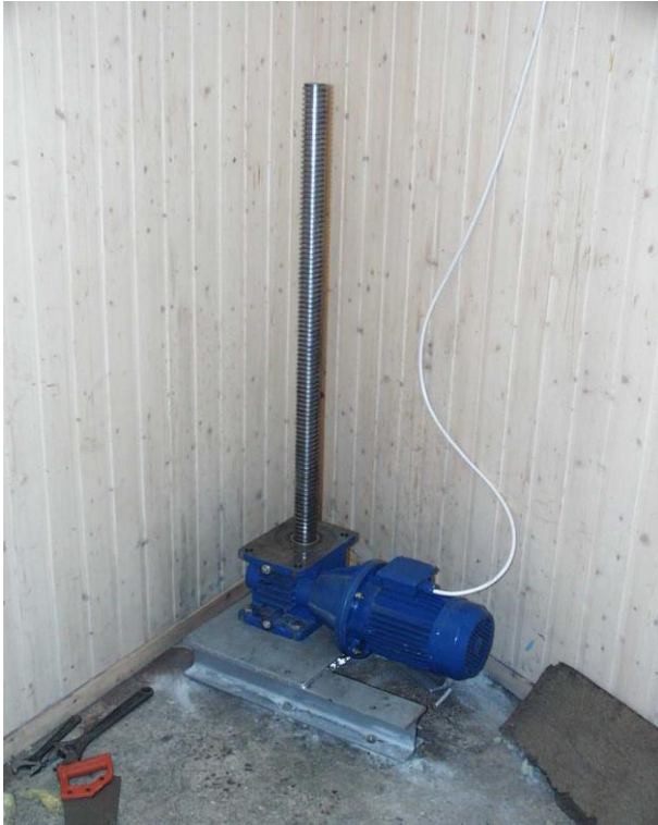
Bilde nr 1: Gearmotor i lukehus (Nordre bunnluke)
