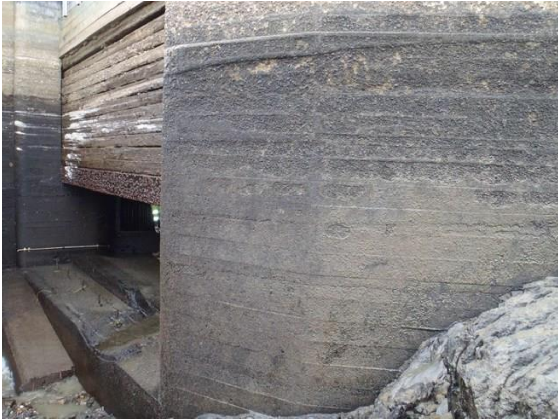
Innløp til driftsluker med bjelkevegg som beskytter mot is.
