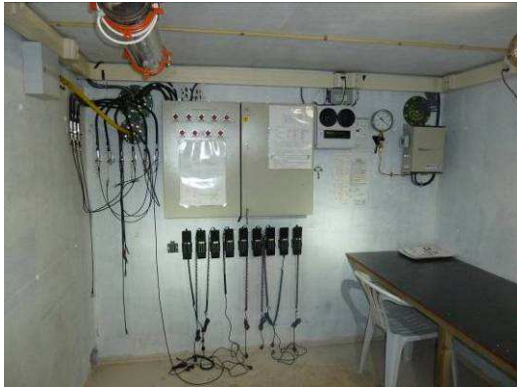
Bilde 30 viser sikringskapp, kabler og telefoner som er eksempler på EE-avfall. Bildet er fra inventar 1007 i Signaldalen.
