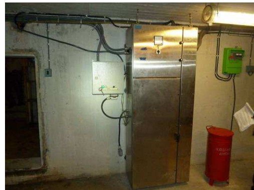
Bilde 33 viser EL-skap, kabler og lysstoffrør som eksempel på EE-avfall fra inventar 1018 i Kitdalen.
