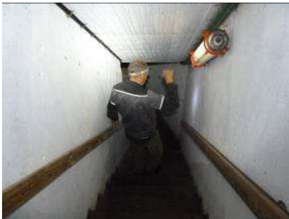
Bilde 26 viser CCA-impregnert trevirke som gelender i trapp i inventar 1010 i Øvregård.
