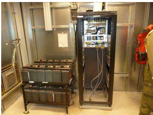
Bilde 31 viser batterier og sikringskapp som eksempel på EE-avfall fra inventar 1007 i Signaldalen.
