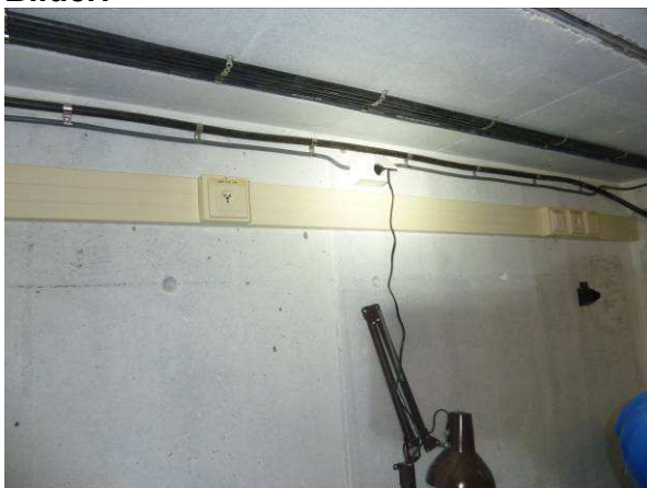
Bilde 24 viser kabelskinne i plast i inventar 1007 i Signaldalen.
