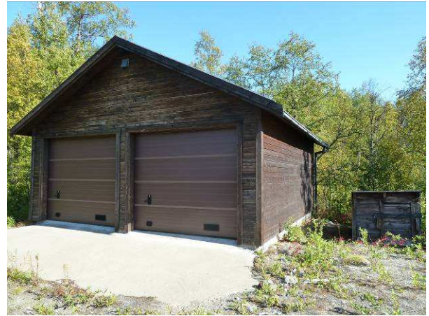
Bilde 59 viser garasje og pumpehus 193955/1013, som begge har oljepapp på tak.
