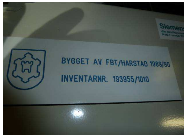
Bilde 40 skilt observert inne i anlegget som beskriver at det er anlegg 193955/1010.
