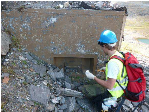
Bilde 41 viser prøvetaking av brunmaling på fasaden av inventar 1028 i Kitdalen.
