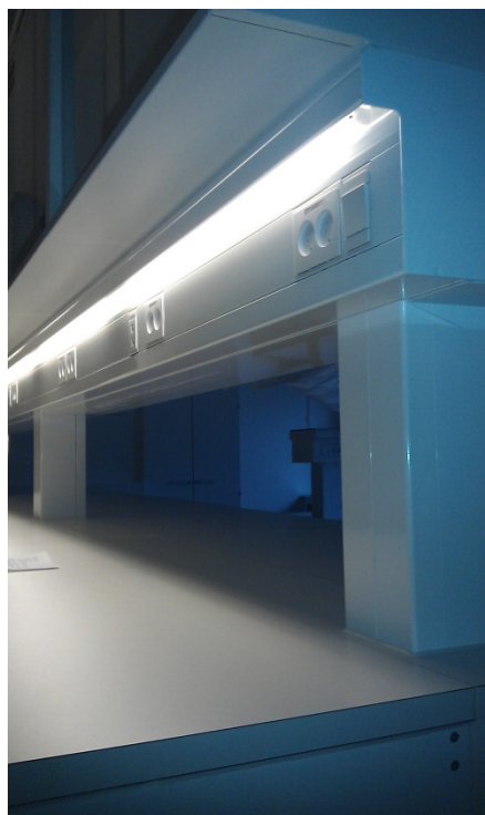
Figur 6: Service panel integrert i laboratorieinnredningen
