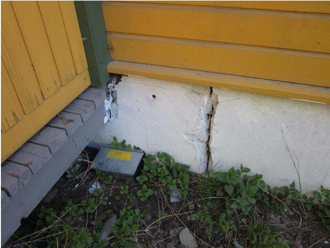
Vertikal sprekk i grunnmur
