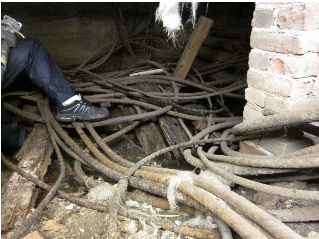
Mye kabler og skrot i krypkjeller
