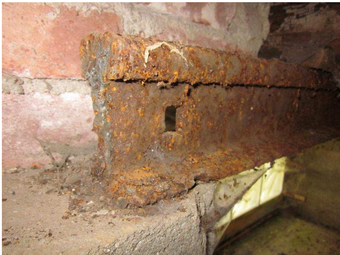
Stålbæring er noe svekket
