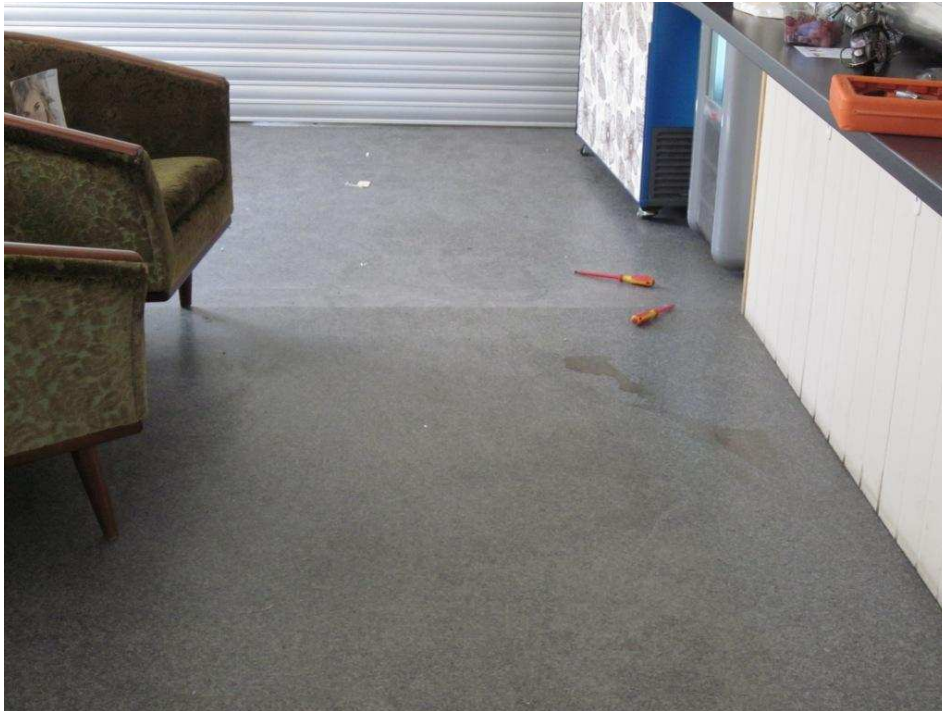
Høydeforskjell på bjelkelag i 1. etasje
