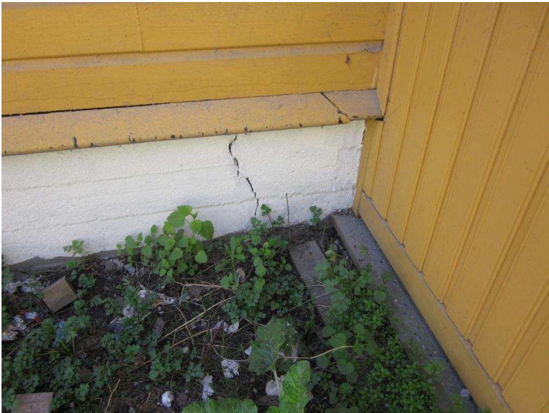
Vertikal sprekk i grunnmur
