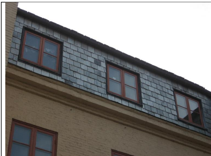
Bygningsdel «sør» - vestside Skifer på 3.etg ved siden av heissjakt.
