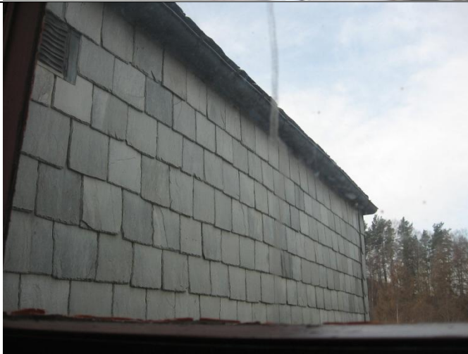
Bygningsdel «sør» - innvendig hjørne på vestside.
