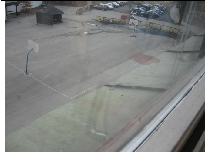
Bygningsdel «sør» Detaljer på beslag mellom 2.etg og 3.etg.
