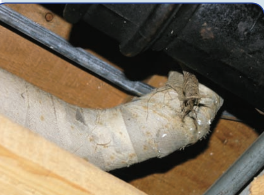
Asbest i isolasjon rundt rør.
