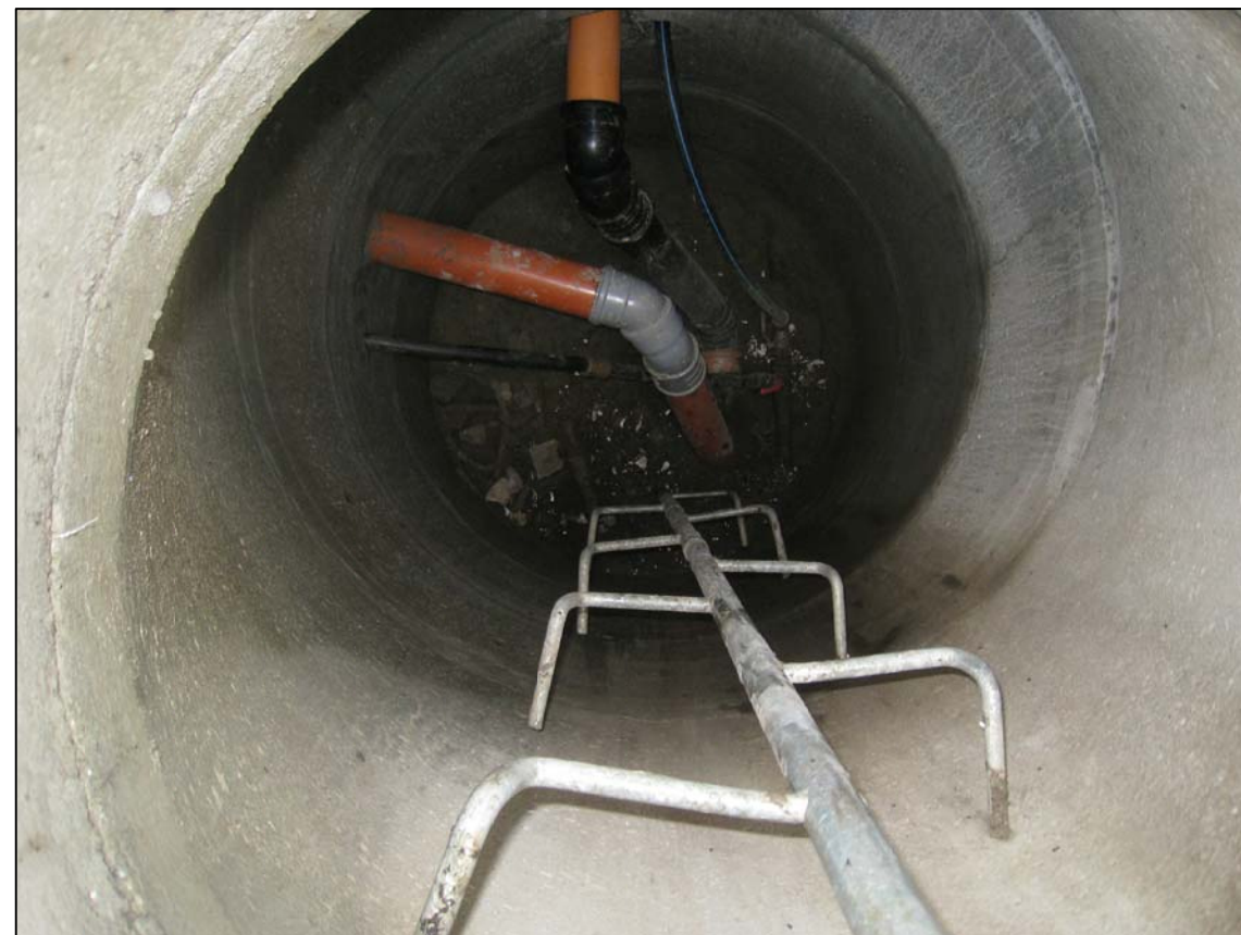
Bilde av eksisterende kum/tilknytningspunkt for ny SP110 og VL63 fra S43
