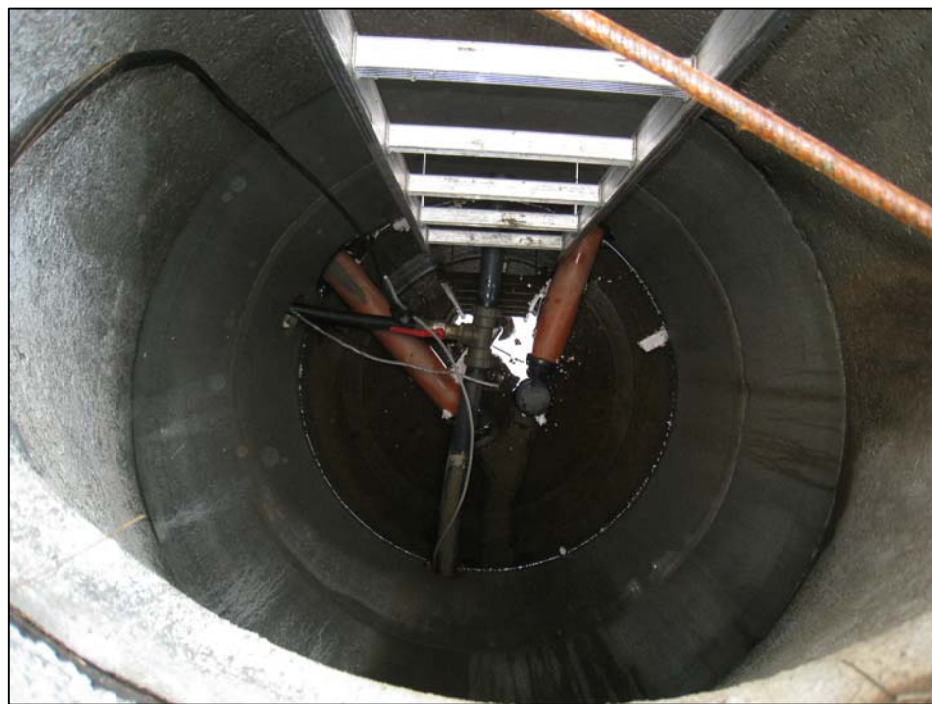
Bilde av eksisterende kum/tilknytningspunkt for ny SP110 og VL63 fra S31
