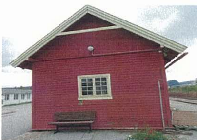
Side mot stasjon Her ønskes det pris på å bytte liggende panel opp til markert skille. Maling vindu / vindskier
