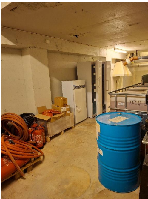
Figur 2: Figur 3: UPS-rom – NORD
