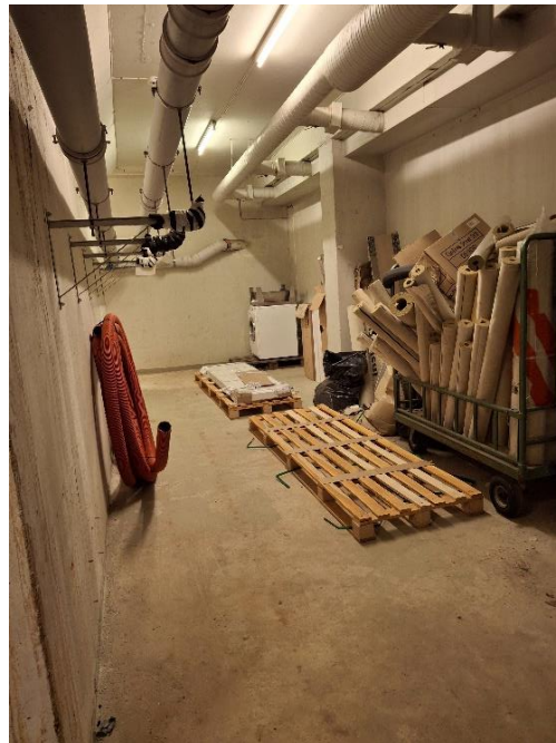
Figur 3: Figur 3: UPS-rom - SØR
