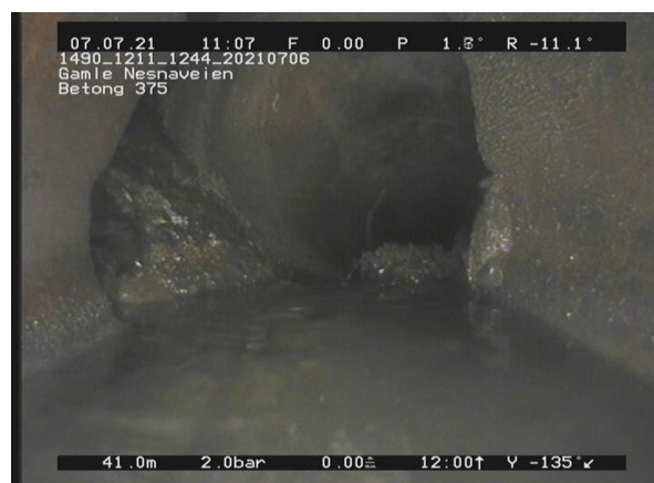
12, 00:05:34, 41.08m Inspeksjon avbrutt, Andre / Møtepunkt for inspeksjon fra andre side.
