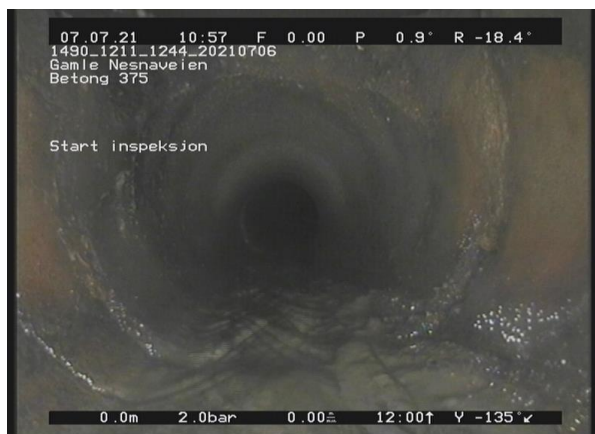
1, 00:00:00, 0.00m Start inspeksjon / Feil dimensjon fra 1211, 225 korrekt dimensjon. Kum ikke på kart 11m fra 1244, dimensjonsending forventet der.
