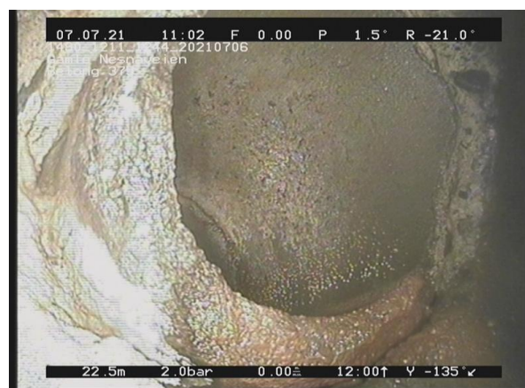
8, 00:03:06, 22.52m Innstukket rør, Innstikk reduserer tverrsnittsarealet med 5 % eller mindre, av 9 Kl. til 10 Kl.
