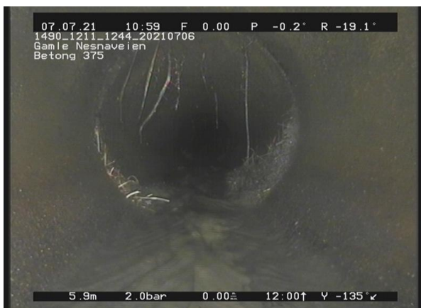
5, 00:00:55, 5.90m Røtter, reduksjon av tverrsnittsarealet er mellom 5 - 15%, av 12 Kl. til 12 Kl., Enkelte fine rottråder
