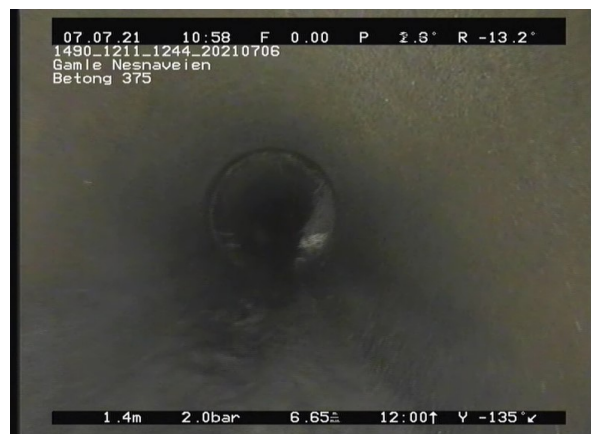
2, 00:00:16, 1.40m Korrosjon/Slitasje, Økende ruhet (rørveggen er noe påvirket), av 4 Kl. til 8 Kl.
