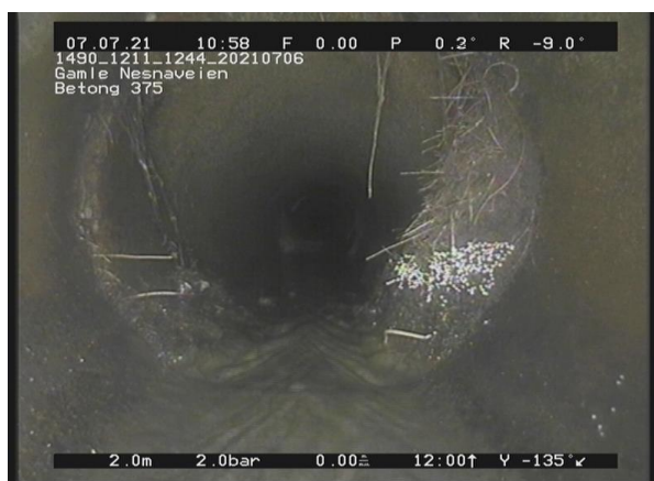
3, 00:00:21, 2.00m Røtter, reduksjon i tverrsnittsarealet er mer enn 30%, av 2 Kl. til 5 Kl., Sammenfiltrede røtter / rottugge
