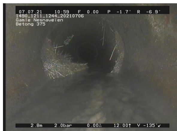
4, 00:00:34, 2.89m Røtter, reduksjon i tverrsnittsarealet er mer enn 30%, av 2 Kl. til 10 Kl., Sammenfiltrede røtter / rottugge
