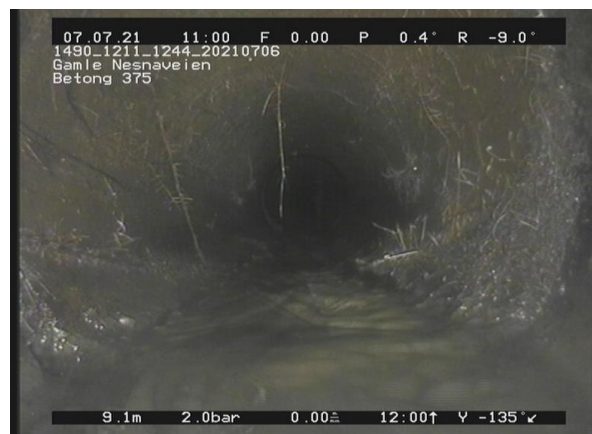
6, 00:01:18, 9.11m Røtter, reduksjon i tverrsnittsarealet er mellom 15 - 30%, av 12 Kl. til 12 Kl., Sammenfildrede røtter / rottugge
