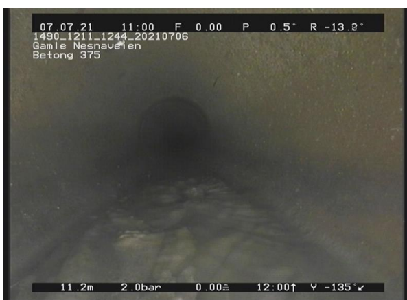
7, 00:01:35, 11.28m Korrosjon/Slitasje, Økende ruhet (rørveggen er noe påvirket), av 2 Kl. til 9 Kl.
