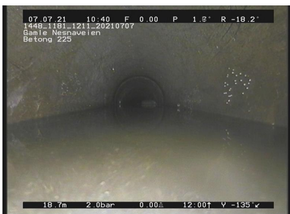
11, 00:05:20, 18.72m Korrosjon/Slitasje, Økende ruhet (rørveggen er noe påvirket), av 12 Kl. til 12 Kl.
