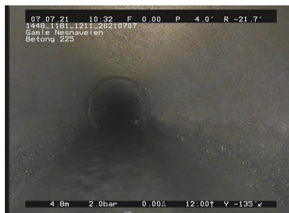
4, 00:01:40, 4.88m Korrosjon/Slitasje, Økende ruhet (rørveggen er noe påvirket), av 12 Kl. til 12 Kl.
