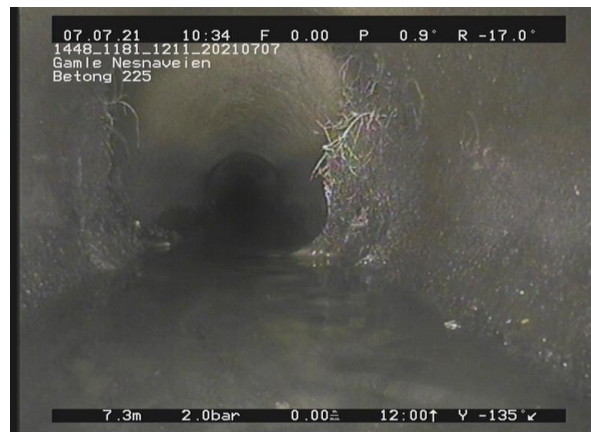
6, 00:02:09, 7.39m Røtter, reduksjon i tverrsnittsarealet er mellom 15 - 30%, av 2 Kl. til 10 Kl., Sammenfildrede røtter / rottugge
