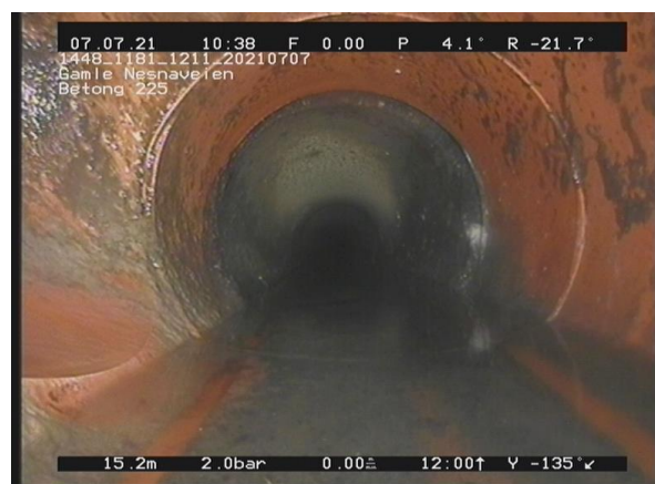
8, 00:04:31, 15.25m Forsk. skjøt forskyvningen er mellom halve og hele rørtykkelsen, av 11 Kl. til 5 Kl., Tverrforskjøvet
