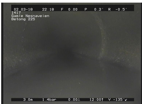
3, 00:00:48, 3.09m Forsk. skjøt forskyvningen er mindre enn halve rørtykkelsen, av 12 Kl. til 5 Kl., Tverrforskjøvet
