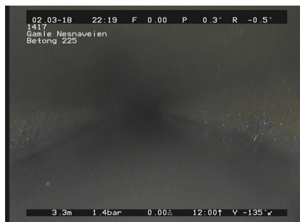
4, 00:01:01, 3.33m Korrosjon/Slitasje, Økende ruhet (rørveggen er noe påvirket), av 3 Kl. til 9 Kl.
