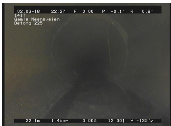
11, 00:04:15, 22.14m Forsk. skjøt forskyvningen er mellom halve og hele rørtykkelsen, av 11 Kl. til 3 Kl., Tverrforskjøvet
