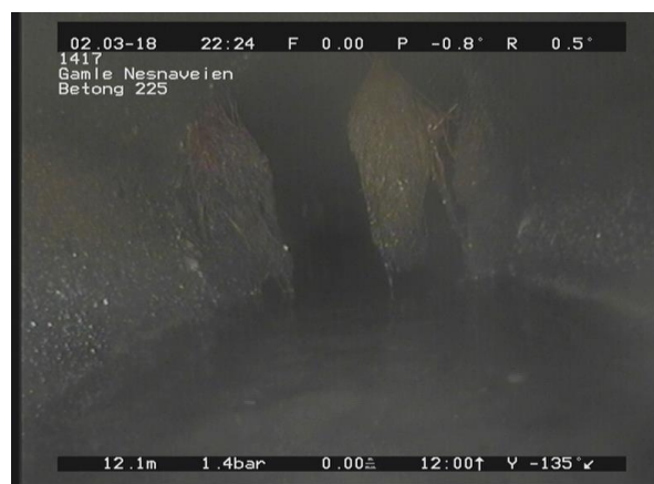
8, 00:02:41, 12.11m Røtter, reduksjon i tverrsnittsarealet er mellom 15 - 30%, av 2 Kl. til 10 Kl., Sammenfiltrede røtter / rottugge
