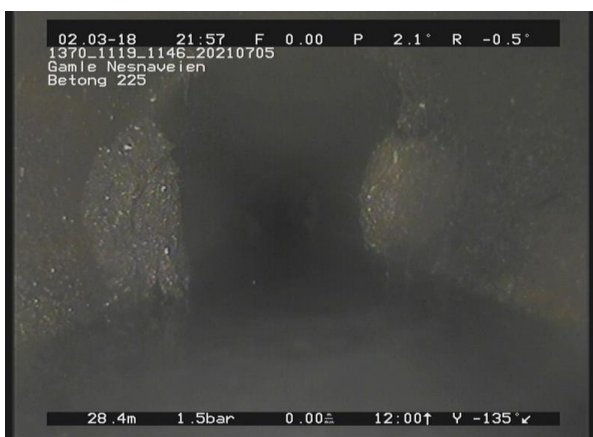
11, 00:05:45, 28.40m Røtter, reduksjon av tverrsnittsarealet er mellom 5 - 15%, av 8 Kl. til 4 Kl., Sammenfildrede røtter / rottugge
