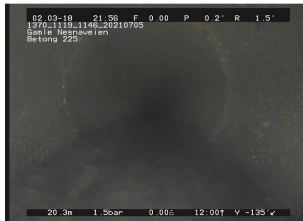
10, 00:04:42, 20.34m Korrosjon/Slitasje, Økende ruhet (rørveggen er noe påvirket), av 12 Kl. til 12 Kl.
