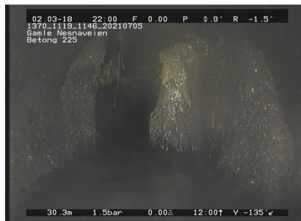
14, 00:06:32, 30.34m Inspeksjon avbrutt, Hindring, 30% / Røtter. Fimet forbi overfylt kum på ca 11 meter. Ikke merket på kart.
