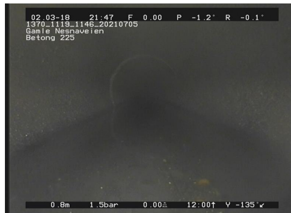
2, 00:00:18, 0.98m Korrosjon/Slitasje Synlig tilslag (rørveggen er betydelig påvirket), I betongrør er tilslagsmaterialet tydelig blottlagt av 3 Kl. til 9 Kl.
