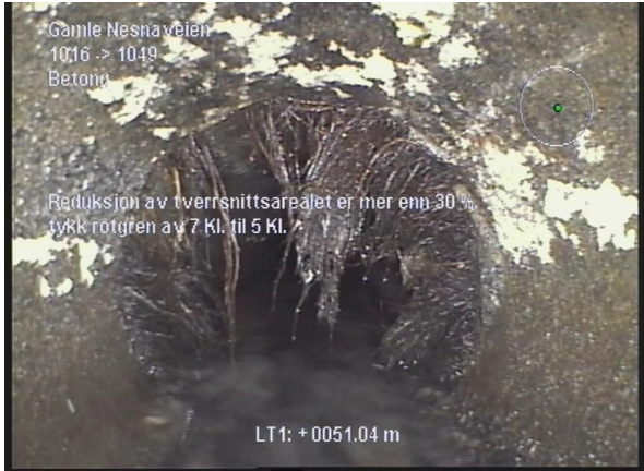
14.11.2024 150201_1016_1049_14112024_030307_052.jpg, 00:06:23, 51.00m Reduksjon av tverrsnittsarealet er mer enn 30 %, tykk rotgren av 7 Kl. til 5 Kl.
