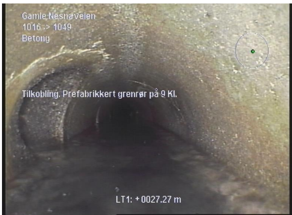
14.11.2024 150201_1016_1049_14112024_030307_042.jpg, 00:02:24, 27.20m Tilkobling. Prefabrikkert grenrør på 9 Kl.
