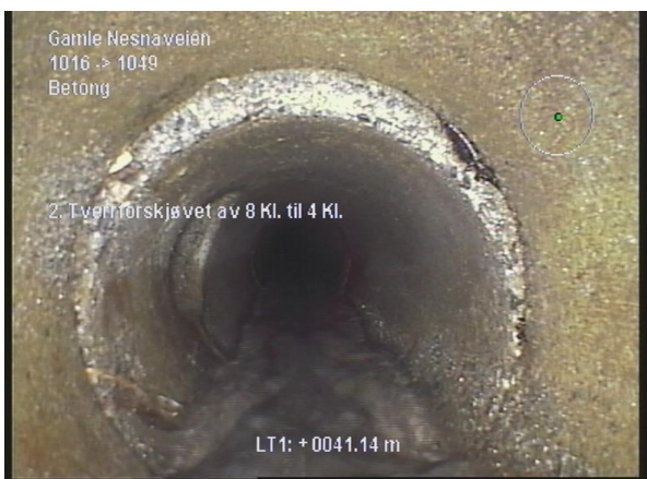
14.11.2024 150201_1016_1049_14112024_030307_046.jpg, 00:04:24, 41.10m 2, Tverrforskjøvet av 8 Kl. til 4 Kl.
