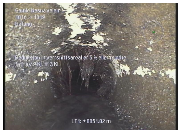
14.11.2024 150201_1016_1049_14112024_030307_051.jpg, 00:06:15, 51.00m Reduksjon i tverrsnittsareal er 5 % eller mindre, fett av 9 Kl. til 3 Kl.
