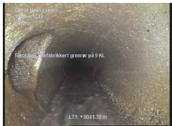
14.11.2024 150201_1016_1049_14112024_030307_047.jpg, 00:04:39, 41.30m Tilkobling, Prefabrikkert grenrør på 9 Kl.
