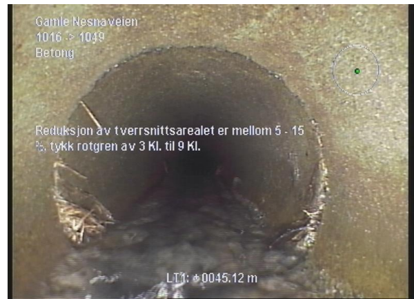
14.11.2024 150201_1016_1049_14112024_030307_049.jpg, 00:05:21, 45.10m Reduksjon av tverrsnittsarealet er mellom 5 - 15 %, tykk rotgren av 3 Kl. til 9 Kl.
