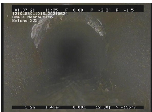
3, 00:00:29, 1.21m Forsk. skjøt forskyvningen er mellom halve og hele rørtykkelsen, av 9 Kl. til 3 Kl., Tverrforskjøvet
