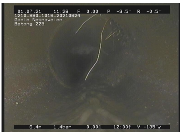
5, 00:01:17, 6.40m Røtter, reduksjon i tverrsnittsarealet er 5% eller mindre, av 12 Kl. til 3 Kl., Enkelte fine rottråder
