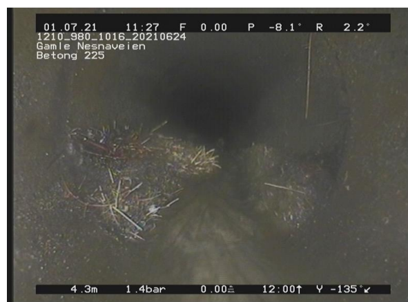
4, 00:00:54, 4.38m Sedimentering, dybde på avsetning er mellom 5-15%, av 4 Kl. til 8 Kl., Fine masser (f eks sand, silt)
