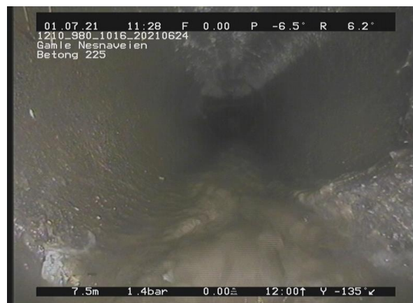
6, 00:01:30, 7.56m Utfelling/Belegg, reduksjon i tverrsnittsarealet er 5% eller mindre, av 11 Kl. til 1 Kl., Utfelling
