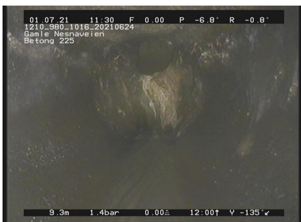
7, 00:01:54, 9.38m Inspeksjon avbrutt, Hindring / Utfelling
