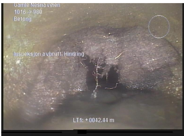
14.11.2024 152856_980_1016_14112024_032933_065.jpg, 00:08:38, 42.40m Inspeksjon avbrutt. Hindring / kamera kjør ikke forbi røtter
