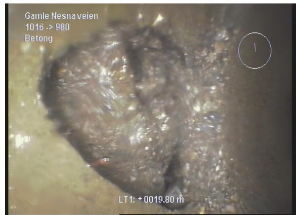
14.11.2024 152856_980_1016_14112024_032933_058.jpg, 00:03:13, 19.60m Rørbiter har løsnet eller mangler, utstrekning under 2 timer, inkl spetthull på 12 Kl. / spetthull
