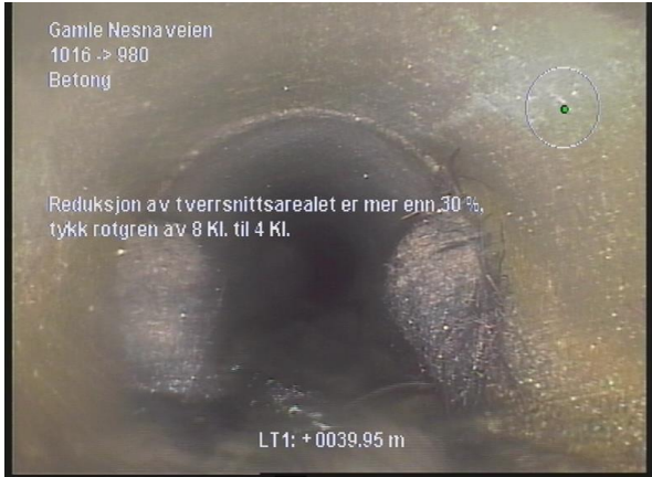
14.11.2024 152856_980_1016_14112024_032933_063.jpg, 00:07:22, 39.90m Reduksjon av tverrsnittsarealet er mer enn 30 %, tykk rotgren av 8 Kl. til 4 Kl.
