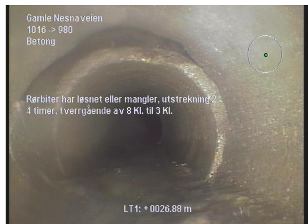
14.11.2024 152856_980_1016_14112024_032933_062.jpg, 00:04:58, 26.80m Rørbiten har løsnet eller mangler, utstrekning 2 - 4 timer, tverrgående av 8 Kl. til 3 Kl.
