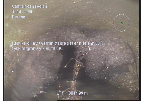
14.11.2024 152856_980_1016_14112024_032933_064.jpg, 00:07:57, 41.90m Reduksjon av tverrsnittsarealet er mer enn 30 %, tykk rotgren av 8 Kl. til 4 Kl.
