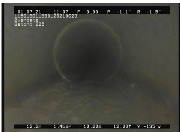
3, 00:02:17, 12.20m Utfelling/Belegg, reduksjon i tverrsnittsarealet er 5% eller mindre, av 4 Kl. til 8 Kl., Utfelling
