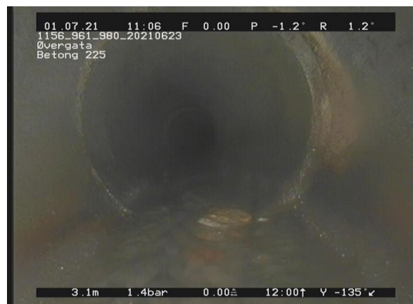
2, 00:00:45, 3.18m Korrosjon/Slitasje, Økende ruhet (rørveggen er noe påvirket), av 3 Kl. til 9 Kl.
