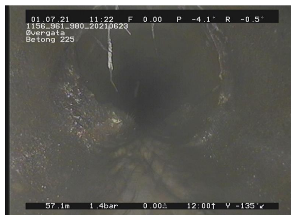
12, 00:09:32, 57.15m Utfelling/Belegg, reduksjon i tverrsnittsarealet er 5% eller mindre, av 4 Kl. til 9 Kl., Utfelling
