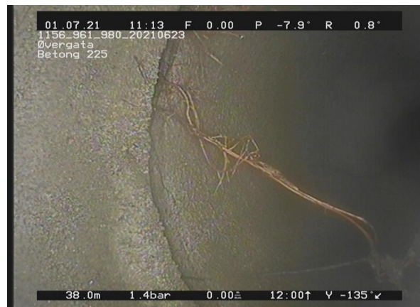
6, 00:05:54, 38.05m Røtter, reduksjon av tverrsnittsarealet er mellom 5 - 15%, av 8 Kl. til 12 Kl., Enkelte fine rottråder
