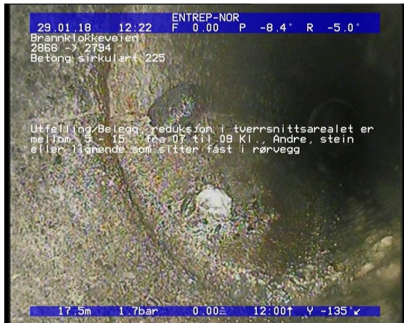
Foto: Utfelling/Belegg, reduksjon i tverrsnittet er mellom 5 - 15%, fra 07 til 09 Kl., Andre, .JPG 17,59m, Utfelling/Belegg, reduksjon i tverrsnittet er mellom 5 - 15%, fra 07 til 09 Kl., Andre, stein eller lignende som sitter fast i rørvegg
