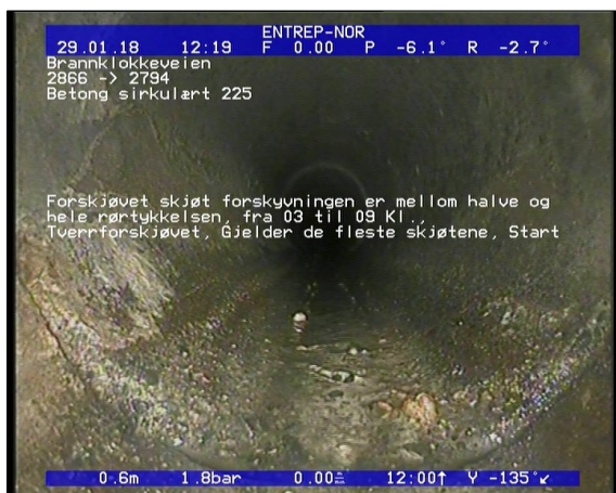
Foto: Forskjøvet skjot forskyvningen er mellom halve og hele rørtykkelsen, fra 03 til 09 Kl., Tverrf. JPG 0,69m, Forskjøvet skjot forskyvningen er mellom halve og hele rørtykkelsen, fra 03 til 09 Kl., Tverrforskjøvet, Gjelder de fleste skjøtene, Start
