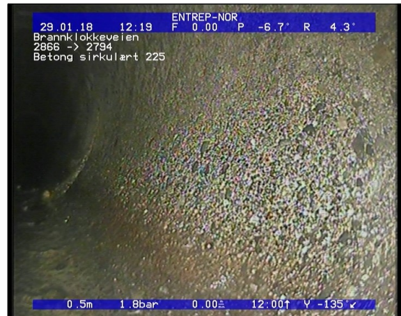
Foto: Korrosjon/Slitasje Synlig tilslag (rørveggen er betydelig påvirket), I betongrør er tilslagsmat.JPG 0,5m, Korrosjon/Slitasje Synlig tilslag (rørveggen er betydelig påvirket), I betongrør er tilslagsmaterialet tydelig blottlagt, fra 04 til 08 Kl., Start
