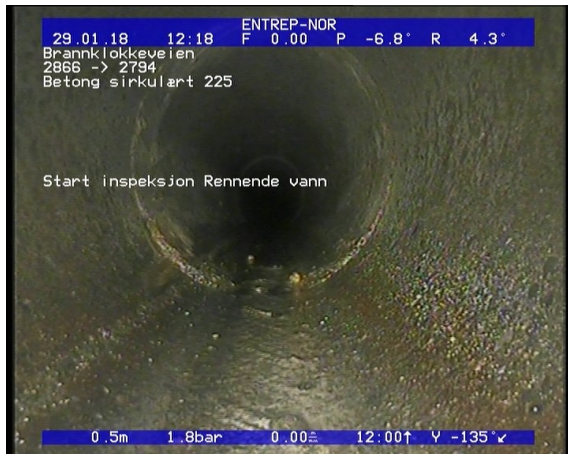
Foto: Start inspeksjon Rennende vann_1123050,5_SI.JPG 0,5m, Start inspeksjon Rennende vann
