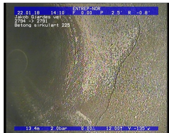
Foto: Sprukket rør, sprekkene er åpneløse teglstein, fra 12 til 12 Kl., Kompleks_22012018_13,41_SR2.JPG 13,41m, Sprukket rør, sprekkene er åpne/løse teglstein, fra 12 til 12 Kl., Kompleks
