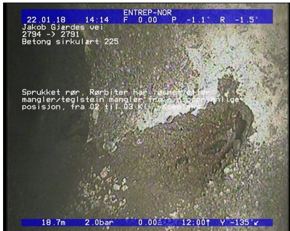
Foto: Sprukket rør, Rørbiter har løsnet eller manglerteglstein mangler fra sin opprinnlige posisjon,.JPG 16,21m, Sprukket rør, Rørbiter har løsnet eller mangler/teglstein mangler fra sin opprinnlige posisjon, fra 12 til 12 Kl., Kompleks
