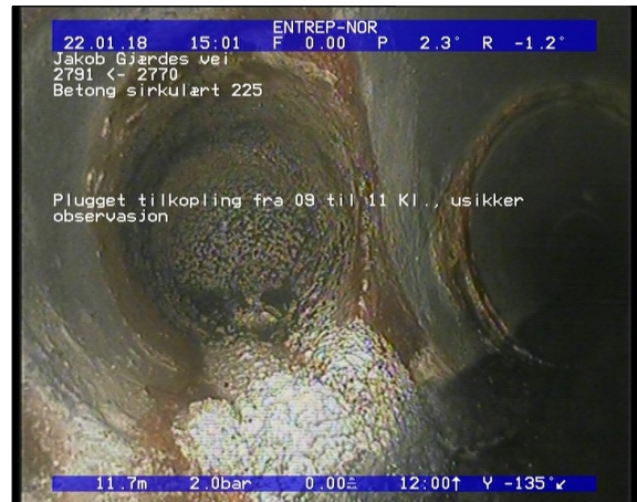
Foto: Plugget tilkopling fra 09 til 11 Kl., usikker observasjon_22012018_11,75_PT.JPG 53,11m, Plugget tilkopling fra 01 til 03 Kl., usikker observasjon
