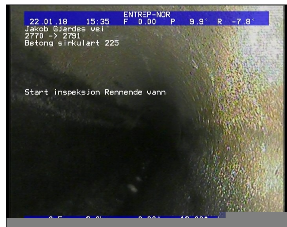
Foto: Start inspeksjon Rennende vann_22012018_0,5_SI.JPG 64,36m, Start inspeksjon Rennende vann
