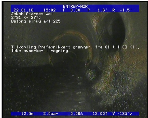
Foto: Tilkopling Prefabrikkert grennrør. fra 01 til 03 Kl., Ikke avmerket i tegning_22012018_12,51_TK.JPG 52,35m, Tilkopling Prefabrikkert grennrør. fra 09 til 11 Kl., Ikke avmerket i tegning
