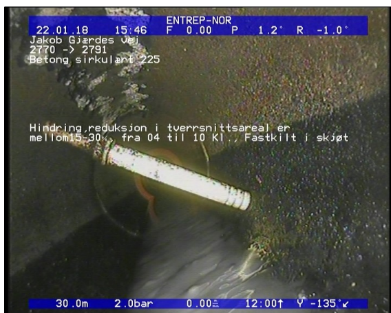
Foto: Hindring, reduksjon i tverrsnittsareal er mellom 15-30%, fra 04 til 10 Kl., Fastkilt i skjøt_2201.JPG 30,02m, Hindring, reduksjon i tverrsnittsareal er mellom 15-30%, fra 04 til 10 Kl., Fastkilt i skjøt
