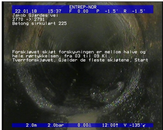
Foto: Forskjøvet skjøt forskyvningen er mellom halve og hele rørtykkelsen, fra 03 til 09 Kl., Tverrforskjøvet, Gjelder de fleste skjøtene, Start 2,08m, Forskjøvet skjøt forskyvningen er mellom halve og hele rørtykkelsen, fra 03 til 09 Kl., Tverrforskjøvet, Gjelder de fleste skjøtene, Start
