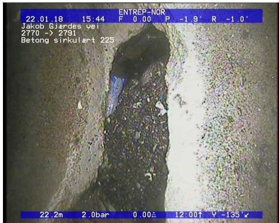
Foto: Sprukket rør, Rørbiter har løsnet eller manglerteglstein mangler fra sin opprinnlige posisjon,.JPG 11,09m, Sprukket rør, Rørbiter har løsnet eller mangler/teglstein mangler fra sin opprinnlige posisjon, fra 10 til 04 Kl., Tangentiell
