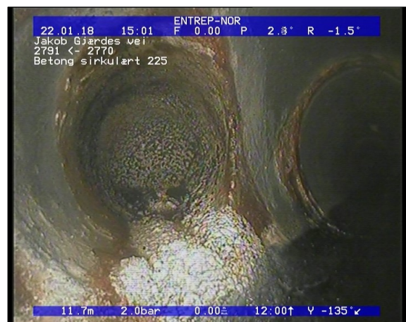
Foto: Tilkopling Prefabrikkert grennrør. fra 09 til 11 Kl., Ikke avmerket i tegning_22012018_11,66_TK.JPG 53,2m, Tilkopling Prefabrikkert grennrør. fra 01 til 03 Kl., Ikke avmerket i tegning
