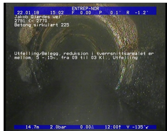
Foto: Utfelling/Belegg, reduksjon i tverrsnittsarealet er mellom 5 - 15, fra 09 til 03 Kl., Utfelli.JPG 50,07m, Utfelling/Belegg, reduksjon i tverrsnittsarealet er mellom 5 - 15%, fra 09 til 03 Kl., Utfelling
