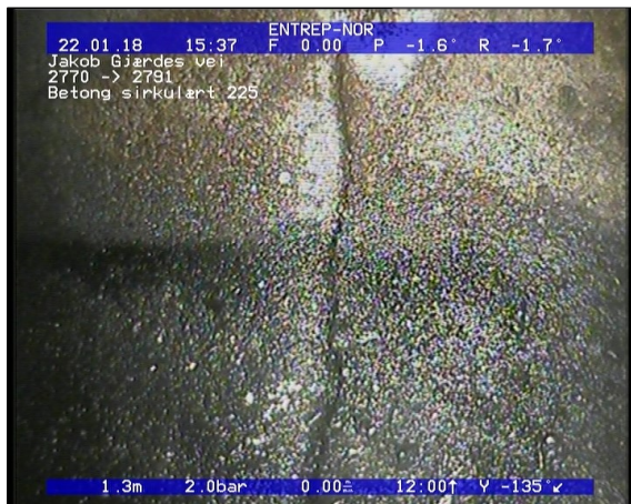
Foto: Sprukket rør, sprekke er åpneløse teglstein, fra 12 til 12 Kl., Tangentiell_22012018_1,18_SR.JPG 1,18m, Sprukket rør, sprekke er åpneløse teglstein, fra 12 til 12 Kl., Tangentiell
