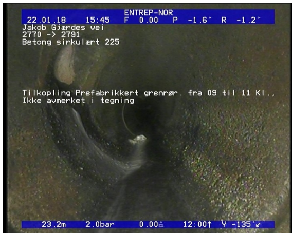
Foto: Tilkopling Prefabrikkert grennrør. fra 09 til 11 Kl., Ikke avmerket i tegning_22012018_23,24_TK.JPG 23,24m, Tilkopling Prefabrikkert grennrør. fra 09 til 11 Kl., Ikke avmerket i tegning
