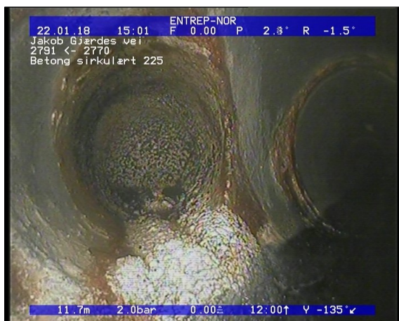
Foto: Tilkopling Prefabrikkert grennrør. fra 09 til 11 Kl., Ikke avmerket i tegning_22012018_11,66_TK.JPG 53,2m, Tilkopling Prefabrikkert grennrør. fra 01 til 03 Kl., Ikke avmerket i tegning
