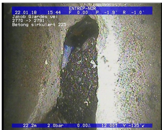
Foto: Sprukket rør, Rørbiter har løsnet eller manglerteglstein mangler fra sin opprinnlige posisjon,.JPG 22m, Sprukket rør, Rørbiter har løsnet eller mangler/teglstein mangler fra sin opprinnlige posisjon, fra 11 til 04 Kl., Tangentiell
