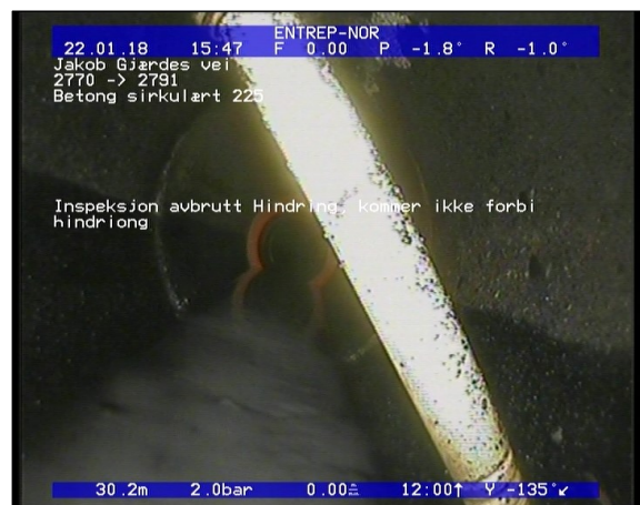
Foto: Inspeksjon avbrutt Hindring, kommer ikke forbi hindring_22012018_30,25_IA.JPG 30,25m, Inspeksjon avbrutt Hindring, kommer ikke forbi hindring
