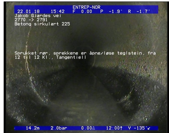
Foto: SPRUKKET RØR, SPREKKENE ER ÅPNELØSE TEGLSTEIN, FRA 12 TIL 12 KL., TANGENTIELL_22012018_14,21_S.JPG 14,21m, Sprukket rør, sprekkene er åpne/løse teglstein, fra 12 til 12 Kl., Tangentiell
