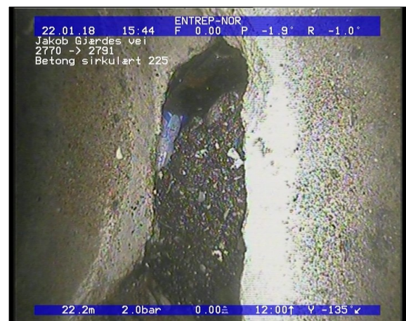
Foto: Sprukket rør, Rørbiter har løsnet eller manglerteglstein mangler fra sin opprinnlige posisjon,.JPG 22m, Sprukket rør, Rørbiter har løsnet eller mangler/teglstein mangler fra sin opprinnlige posisjon, fra 11 til 04 Kl., Tangentiell
