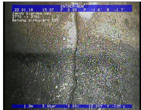
Foto: Sprukket rør, sprekke er åpneløse teglstein, fra 12 til 12 Kl., Tangentiell_22012018_1,18_SR.JPG 1,18m, Sprukket rør, sprekke er åpneløse teglstein, fra 12 til 12 Kl., Tangentiell
