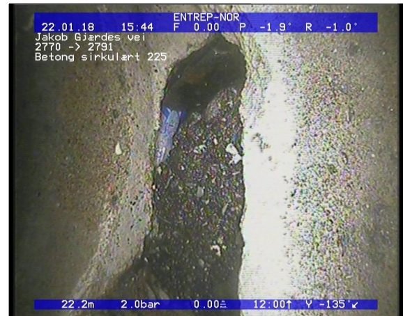
Foto: Sprukket rør, Rørbiter har løsnet eller manglerteglstein mangler fra sin opprinnlige posisjon,.JPG 9,17m, Sprukket rør, Rørbiter har løsnet eller mangler/teglstein mangler fra sin opprinnlige posisjon, fra 12 til 12 Kl., Tangentiell
