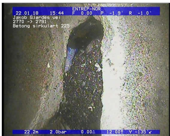
Foto: Sprukket rør, Rørbiter har løsnet eller manglerteglstein mangler fra sin opprinnlige posisjon, JPG 6,13m, Sprukket rør, Rørbiter har løsnet eller mangler/teglstein mangler fra sin opprinnlige posisjon, fra 12 til 12 Kl., Kompleks
