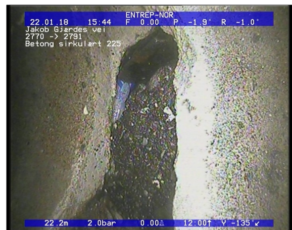
Foto: Sprukket rør, Rørbiter har løsnet eller manglerteglstein mangler fra sin opprinnlige posisjon, JPG 8,3m, Sprukket rør, Rørbiter har løsnet eller mangler/teglstein mangler fra sin opprinnlige posisjon, fra 05 til 08 Kl., Tangentiell, rørbunn borte
