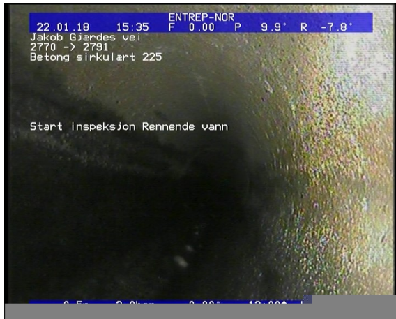
Foto: Start inspeksjon Rennende vann_22012018_0,5_SI.JPG 0,5m, Start inspeksjon Rennende vann
