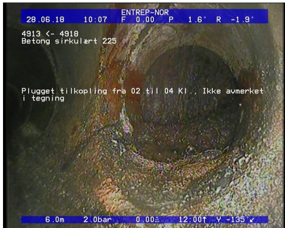
Foto: Tilkopling Prefabrikkert grenrør. fra 02 til 04 Kl., Ikke avmerket i tegning_1010195,94_TK.JPG 5,94m, Tilkopling Prefabrikkert grenrør. fra 02 til 04 Kl., Ikke avmerket i tegning
