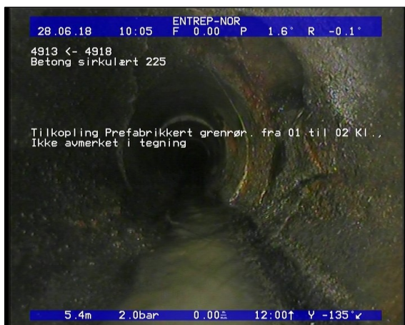
Foto: Tilkopling Prefabrikkert grenrør. fra 01 til 02 Kl., Ikke avmerket i tegning_1008555,45_TK.JPG 5,45m, Tilkopling Prefabrikkert grenrør. fra 01 til 02 Kl., Ikke avmerket i tegning
