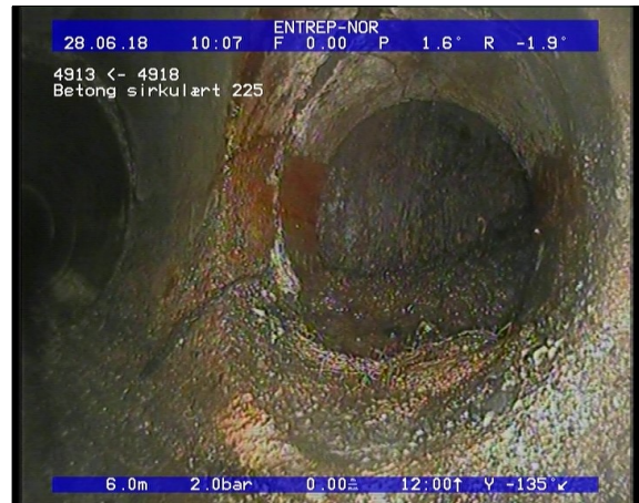
Foto: Plugget tilkopling fra 02 til 04 Kl., Ikke avmerket i tegning_1010256,04_PT.JPG 6,04m, Plugget tilkopling fra 02 til 04 Kl., Ikke avmerket i tegning
