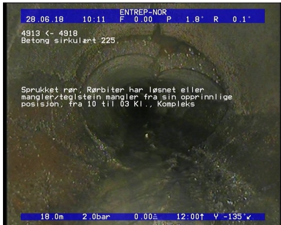
Foto: Sprukket rør, Rørbiter har løsnet eller manglerteglstein mangler fra sin opprinnlige posisjon,.JPG 2,11m, Sprukket rør, Rørbiter har løsnet eller mangler/teglstein mangler fra sin opprinnlige posisjon, fra 12 til 12 Kl., Kompleks, Start
