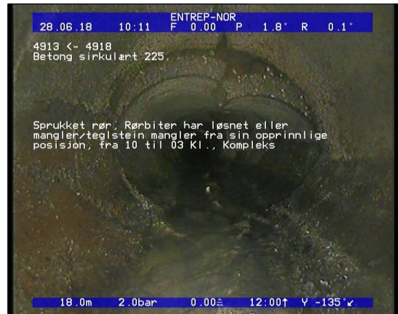
Foto: Sprukket rør, Rørbiter har løsnet eller mangler/teglstein mangler fra sin opprinnlige posisjon,.JPG 18,02m, Sprukket rør, Rørbiter har løsnet eller mangler/teglstein mangler fra sin opprinnlige posisjon, fra 10 til 03 Kl., Kompleks
