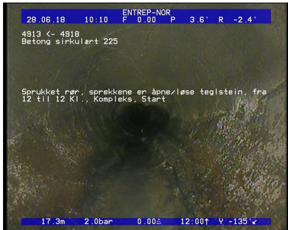
Foto: Sprukket rør, sprekke er åpne/løse teglstein, fra 12 til 12 Kl., Kompleks, Start_10133117,31_.JPG 17,31m, Sprukket rør, sprekke er åpne/løse teglstein, fra 12 til 12 Kl., Kompleks, Start
