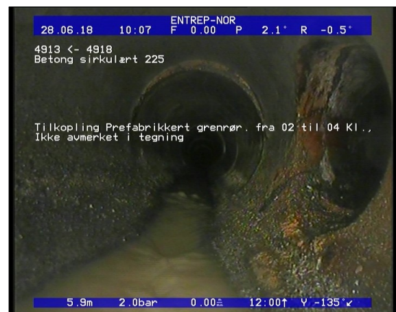
Foto: Tilkopling Prefabrikkert grenrør. fra 02 til 04 Kl., Ikke avmerket i tegning_1010045,94_TK.JPG 5,94m, Tilkopling Prefabrikkert grenrør. fra 02 til 04 Kl., Ikke avmerket i tegning
