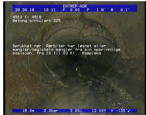
Foto: Sprukket rør, Rørbiter har løsnet eller manglerteglstein mangler fra sin opprinnlige posisjon,.JPG 2,11m, Sprukket rør, Rørbiter har løsnet eller mangler/teglstein mangler fra sin opprinnlige posisjon, fra 12 til 12 Kl., Kompleks, Start
