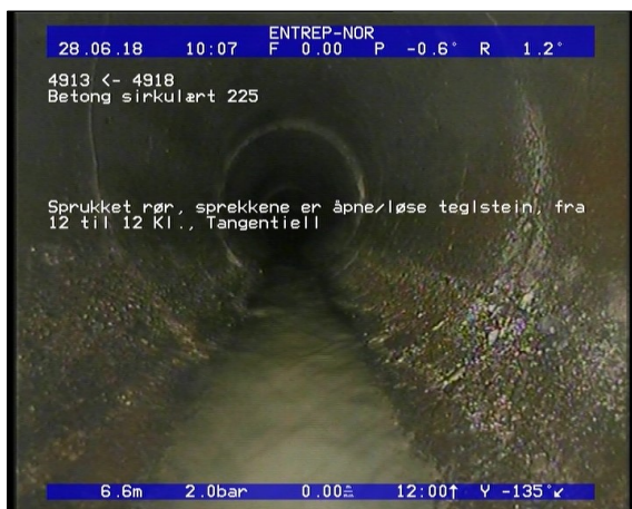
Foto: Sprukket rør, sprekken er åpne/løse teglstein, fra 12 til 12 Kl., Tangentiell_1010466,65_SR2.JPG 6,65m, Sprukket rør, sprekken er åpne/løse teglstein, fra 12 til 12 Kl., Tangentiell
