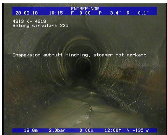
Foto: Inspeksjon avbrutt Hindring, stopper mot rørkant_10183018,66_.IA.JPG 18,66m, Inspeksjon avbrutt Hindring, stopper mot rørkant
