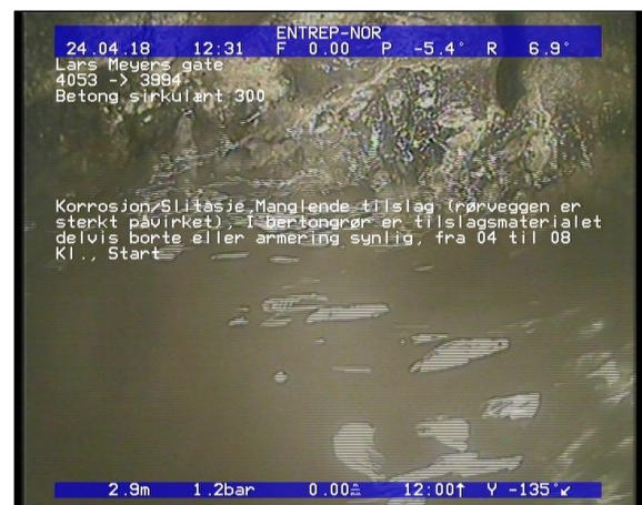
Foto: Korrosjon/Slitasje, Manglende tilslag (rørveggen er sterkt påvirket), I bertongrør er tilslagsma.JPG 2,94m, Korrosjon/Slitasje, Manglende tilslag (rørveggen er sterkt påvirket), I bertongrør er tilslagsmaterialet delvis borte eller armering synlig, fra 04 til 08 Kl., Start
