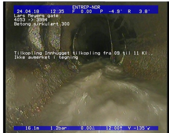
Foto: Tilkopling Innhugget tilkopling fra 09 til 11 Kl., Ikke avmerket i tegning_12385316,19_TK.JPG 16,19m, Tilkopling Innhugget tilkopling fra 09 til 11 Kl., Ikke avmerket i tegning
