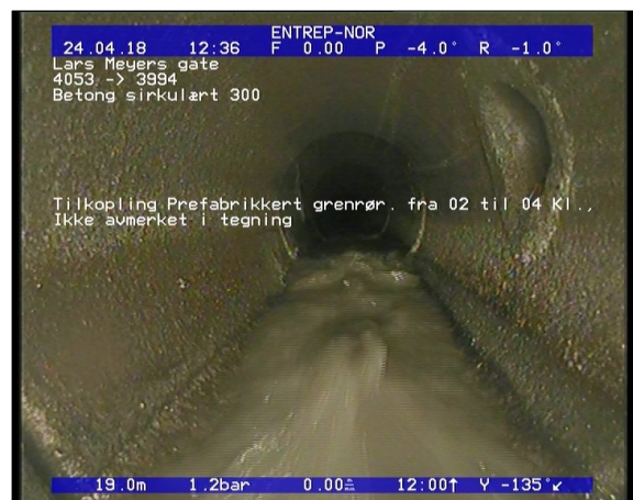
Foto: Tilkopling Prefabrikkert grennrør, fra 02 til 04 Kl., Ikke avmerket i tegning_12394619,04_TK.JPG 19,04m, Tilkopling Prefabrikkert grennrør, fra 02 til 04 Kl., Ikke avmerket i tegning
