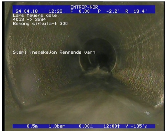
Foto: Start inspeksjon Rennende vann_1233370,5_SI.JPG 0,5m, Start inspeksjon Rennende vann
