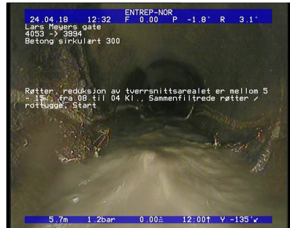
Foto: Røtter, reduksjon av tverrsnittsarealet er mellom 5 - 15%, fra 08 til 04 Kl., Sammenfiltrede røtter / rottugge, Start.JPG 5,76m, Røtter, reduksjon av tverrsnittsarealet er mellom 5 - 15%, fra 08 til 04 Kl., Sammenfiltrede røtter / rottugge, Start
