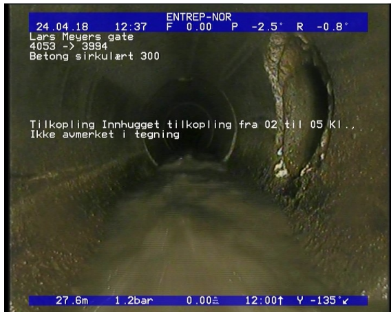
Foto: Tilkopling Innhugget tilkopling fra 02 til 05 Kl., Ikke avmerket i tegning_12405627,64_TK.JPG 27,64m, Tilkopling Innhugget tilkopling fra 02 til 05 Kl., Ikke avmerket i tegning
