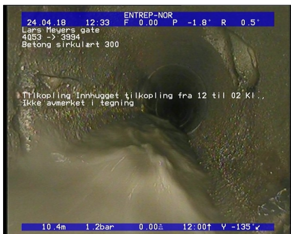
Foto: Tilkopling Innhugget tilkopling fra 12 til 02 Kl., Ikke avmerket i tegning_12371810,48_TK.JPG 10,48m, Tilkopling Innhugget tilkopling fra 12 til 02 Kl., Ikke avmerket i tegning
