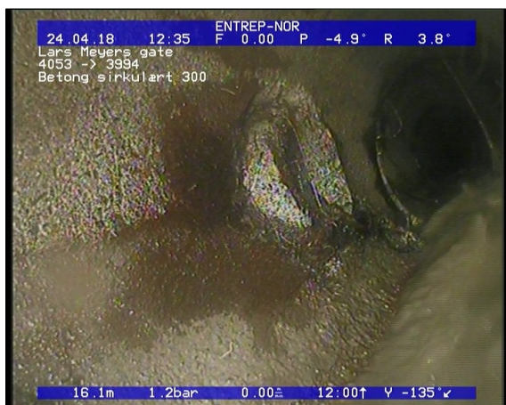
Foto: Innstukket rør, Innstikk reduserer tverrsnittsarealet med mellom 5-15, fra 09 til 11 Kl., 1239.JPG 16,19m, Innstukket rør, Innstikk reduserer tverrsnittsarealet med mellom 5-15 %, fra 09 til 11 Kl.
