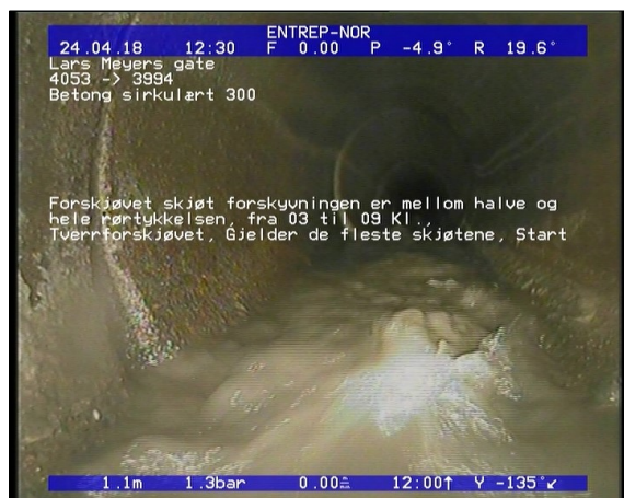
Foto: Forskjøvet skjøt forskyvningen er mellom halve og hele rørtykkelsen, fra 03 til 09 Kl., Tverrforskjøvet, Gjelder de fleste skjøtene, Start 1,17m, Forskjøvet skjøt forskyvningen er mellom halve og hele rørtykkelsen, fra 03 til 09 Kl., Tverrforskjøvet, Gjelder de fleste skjøtene, Start
