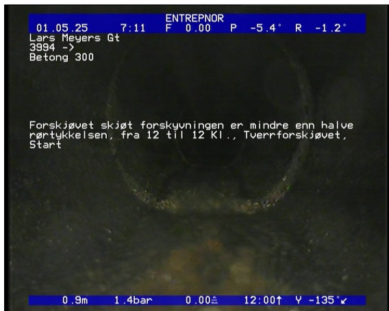
Foto: 4_1_Nr (SO_Counter)_28022019_095116.JPG 0,92m, Forskjøvet skjøt forskyvningen er mindre enn halve rørtykkelsen, fra 12 til 12 Kl., Tverrforskjøvet, Start
