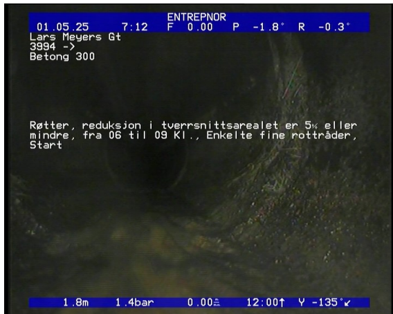
Foto: 4_1_Nr (SO_Counter)_28022019_095219.JPG 1,82m, Røtter, reduksjon i tverrsnittsarealet er 5% eller mindre, fra 03 til 09 Kl., Enkelte fine rottråder, Start
