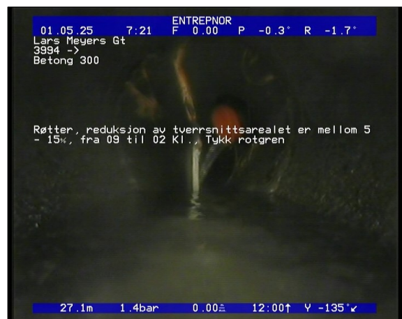
Foto: 4_1_Nr (SO_Counter)_28022019_100118.JPG 27,1m, Røtter, reduksjon av tverrsnittsarealet er mellom 5 - 15%, fra 09 til 02 Kl., Tykk rotgren
