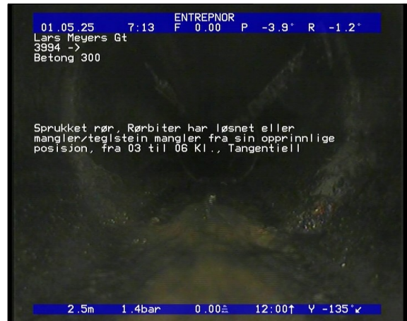
Foto: 4_1_Nr (SO_Counter)_28022019_095314.JPG 2,57m, Sprukket rør, Rørbiter har løsnet eller mangler/teglstein mangler fra sin opprinnlige posisjon, fra 03 til 06 Kl., Tangentiell
