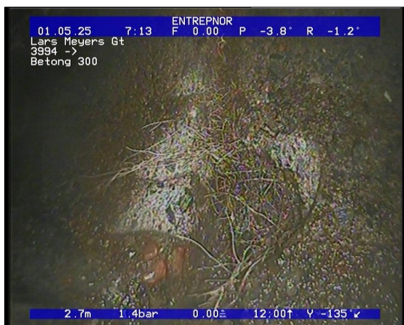
Foto: 4_1_Nr (SO_Counter)_28022019_095322.JPG 2,57m, Sprukket rør, Rørbiter har løsnet eller mangler/teglstein mangler fra sin opprinnlige posisjon, fra 03 til 06 Kl., Tangentiell
