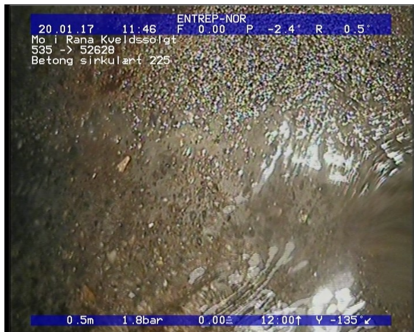
Foto: 2_2_11_A.JPG 0,5m, Korrosjon/Slitasje Synlig tilslag (rørveggen er betydelig påvirket), I betongrør er tilslagsmaterialet tydelig blottlagt, fra 04 til 08 Kl., Start
