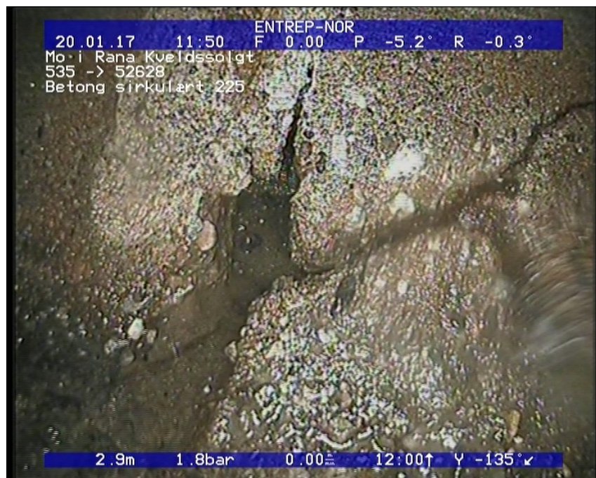
Foto: 2_2_16_A.JPG 2,96m, Sprukket rør, Rørbiter har løsnet eller mangler/teglstein mangler fra sin opprinnlige posisjon, fra 04 til 08 Kl., Tangentiell
