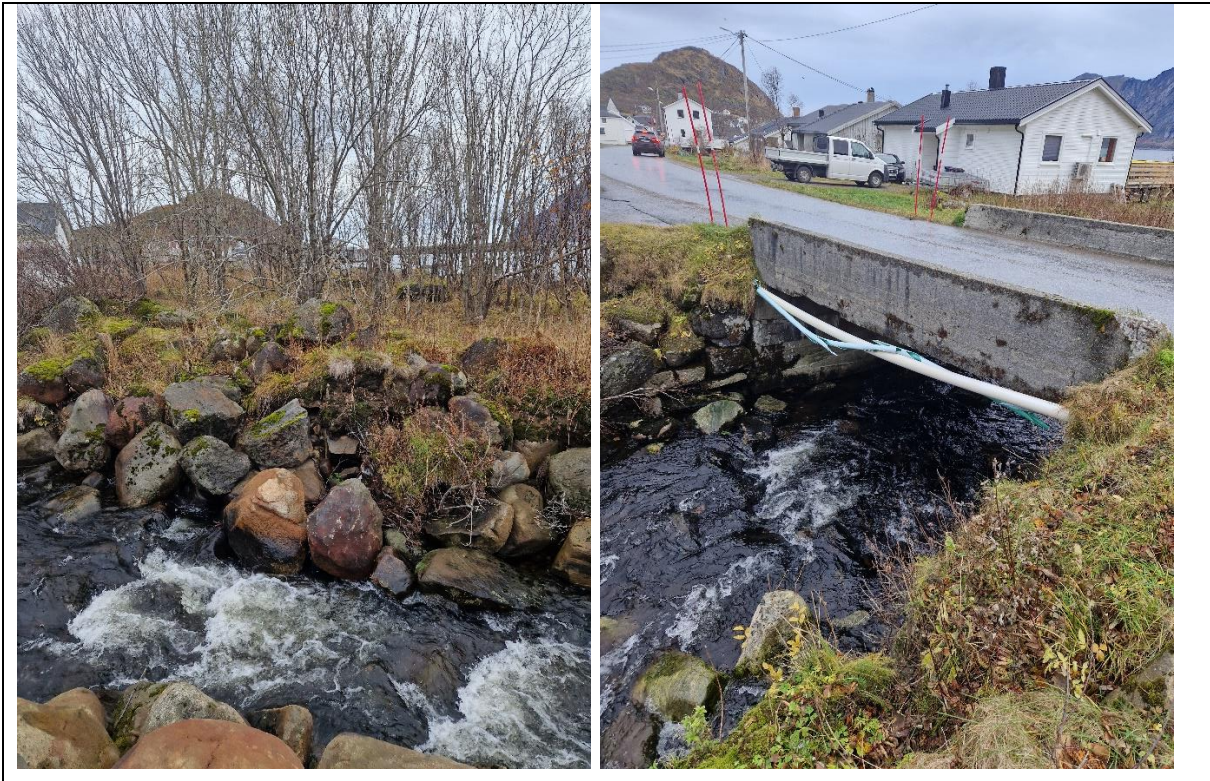
Figur 4-2: Bildet til venstre viser erosjonsskader i elveleiet nedstrøms. Bildet til høyre viser brua oppstrøms med ledninger/kabler som henger fritt og er delvis ødelagt.
