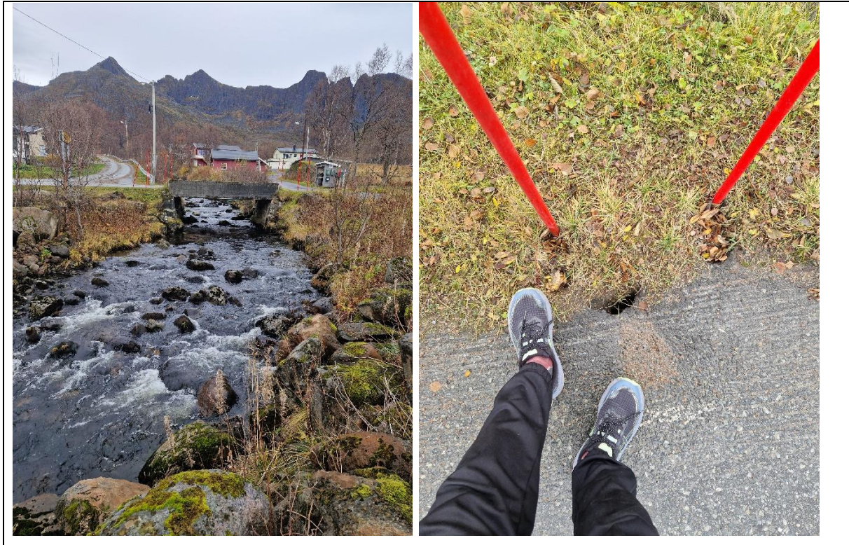
Figur 4-1: Bilde til venstre er tatt nedstrøms. Bilde til høyre viser hull i asfalt.
