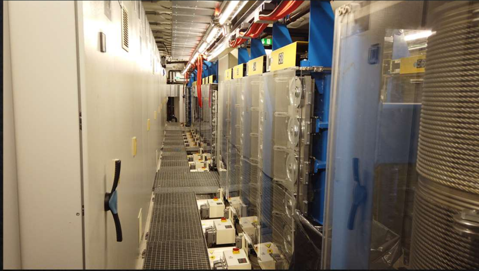
Maskinrom 10.etg høyre side
