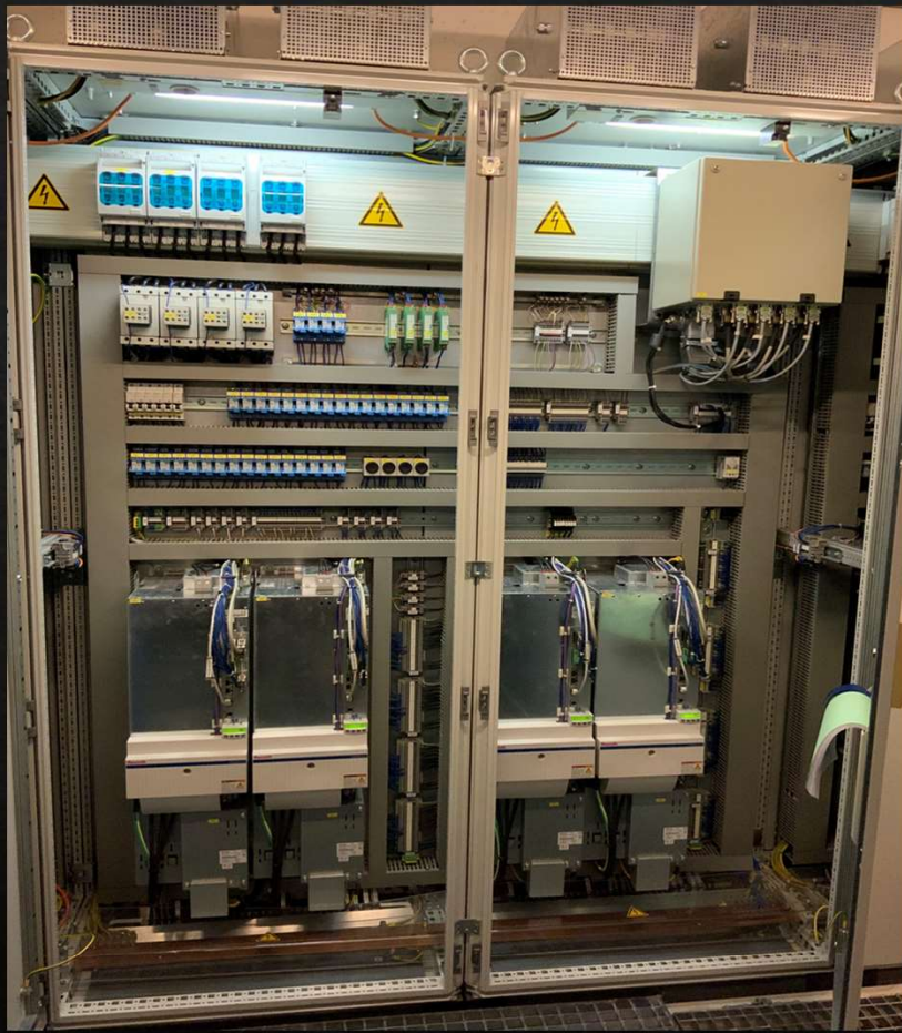
Styrekabinett med aksekontrollere og frekvensomformere
