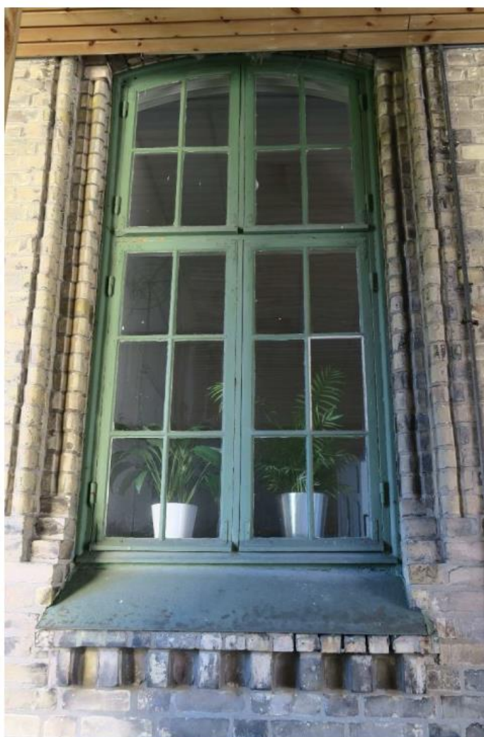
Original vinduet i bygg 2 (panelet som dekker den øvre delen er undersiden av et mellombygg)
