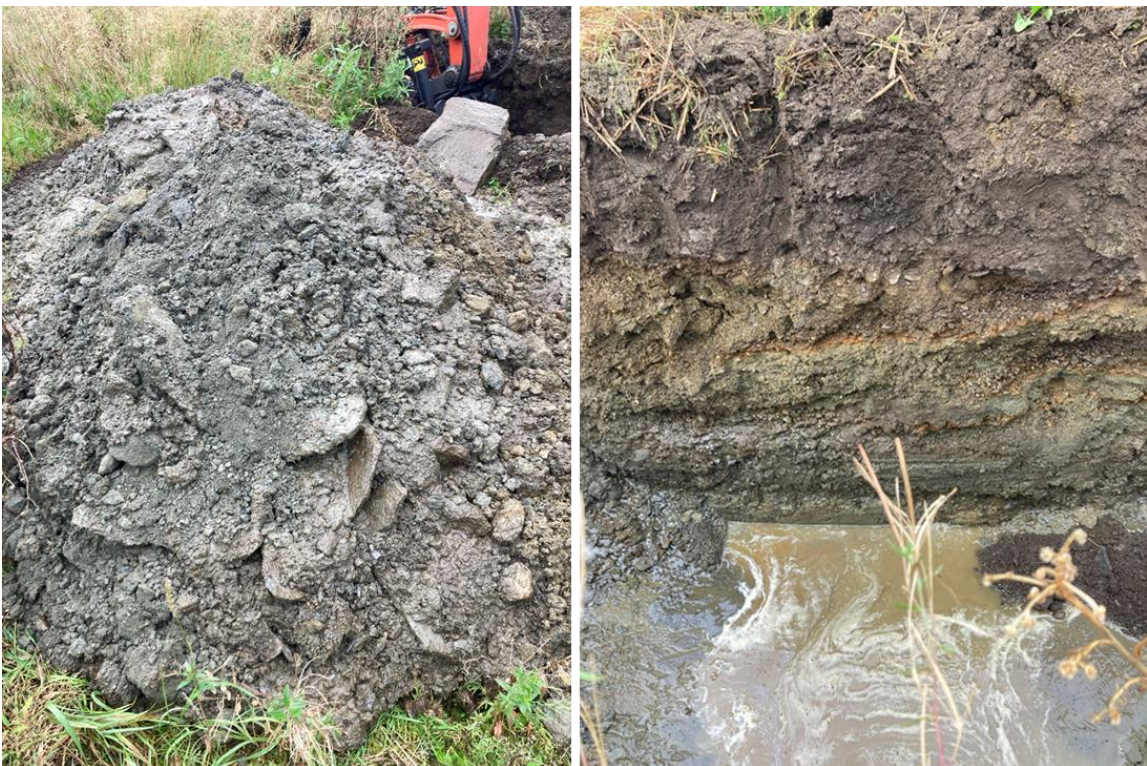
Figur 4 Prøvepunkt P2. Vanninnsig i sjakt og mye stein (fyllitt).
