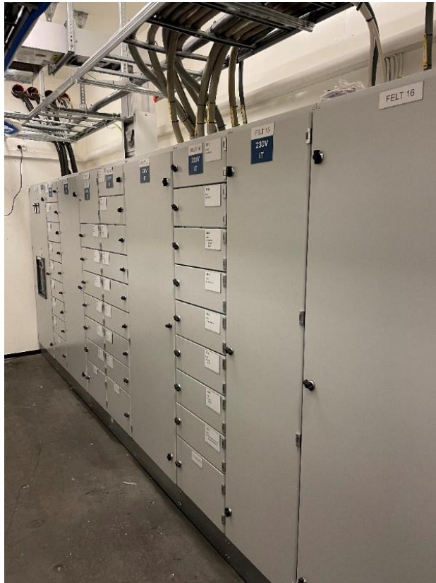
Figur 7: Eksisterende 230V hovedtavle C-fløy, inntak generator
