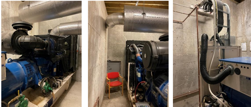
Figur 13: Generatoranlegg i fløy C
