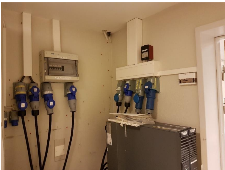
Figur 15: UPS-anlegg fløy C, rom CH1240
