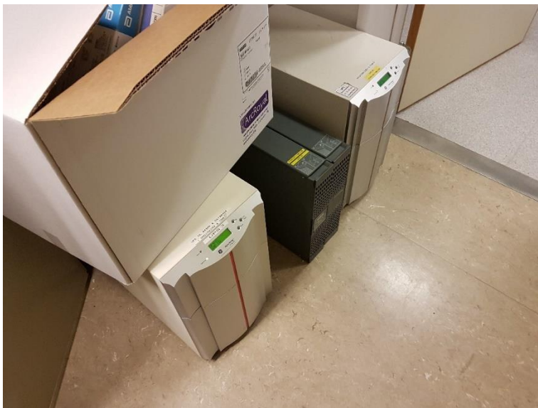
Figur 14: UPS-anlegg fløy C
